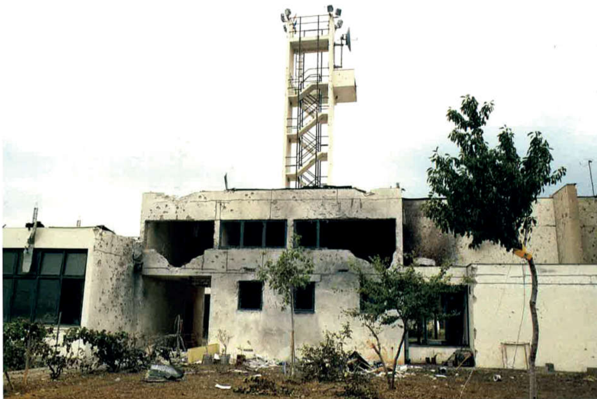
▽ Oštećena transformatorska stanica Konjsko, 1992.
