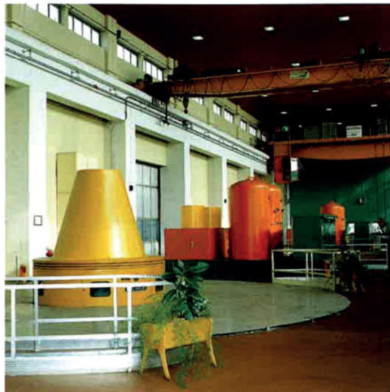
△ Strojarnica hidroelektrane Varaždin
