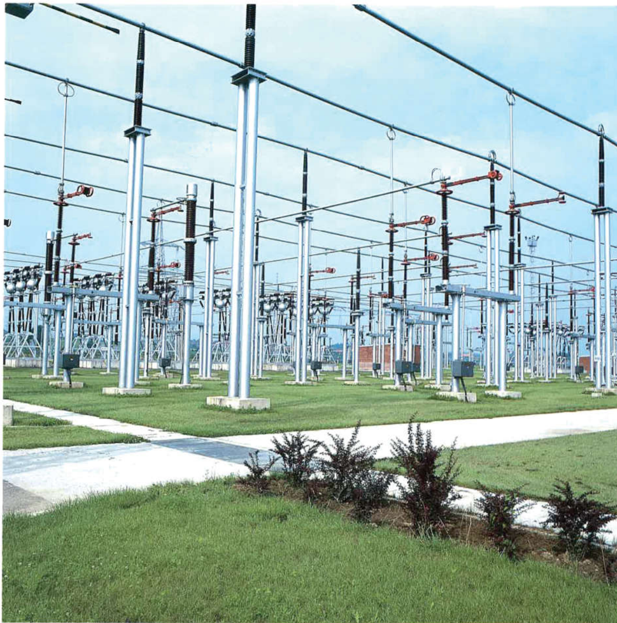
Δ Transformatorska stanica Tumbri 400/110 kV
