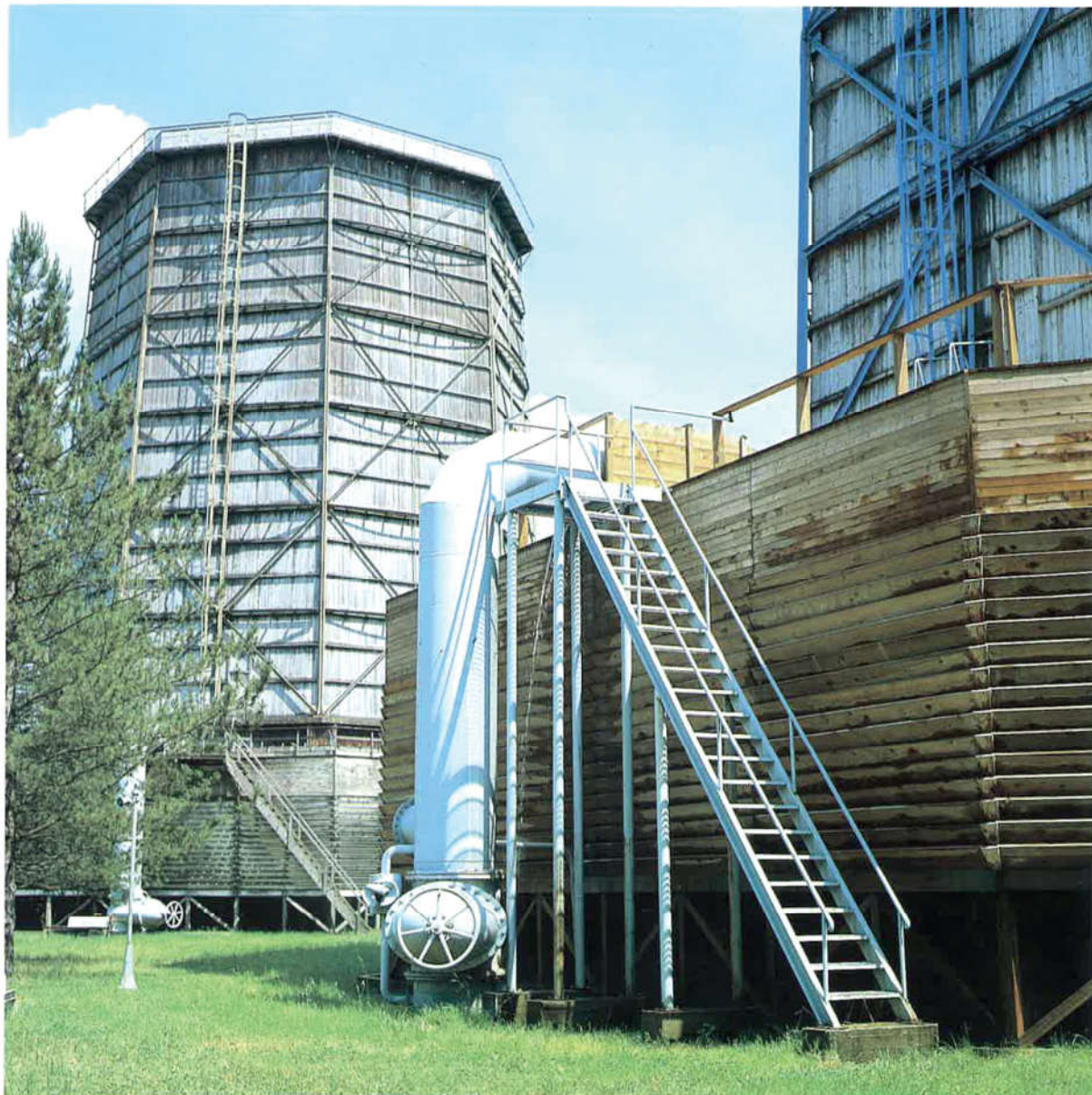
△ Rashladni tornjevi termoelektrane Jertovec
