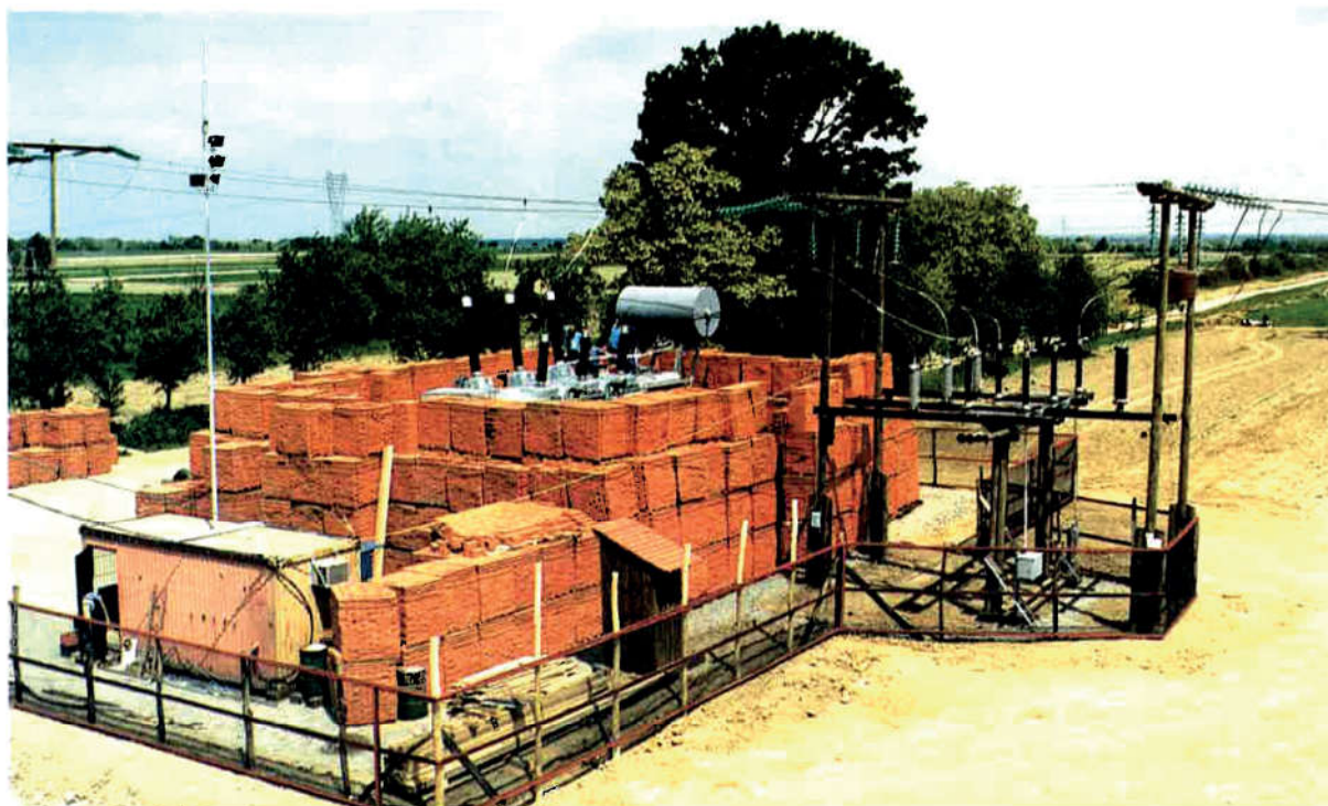
△ Privremena transformatorska stanica izgrađena 1992. godine nakon razaranja Ernestinova
