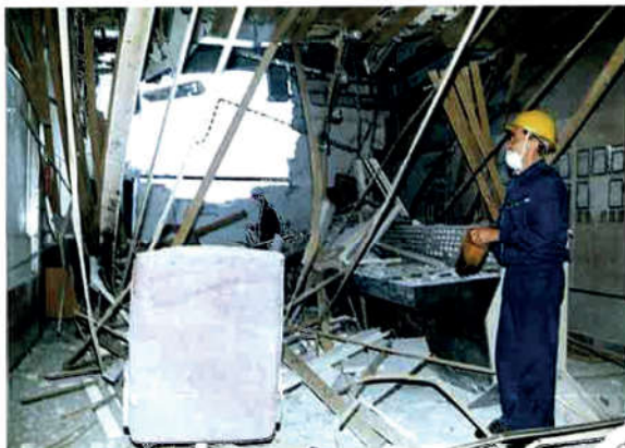
▽ Oštećena termoelektrana-toplana Osijek
