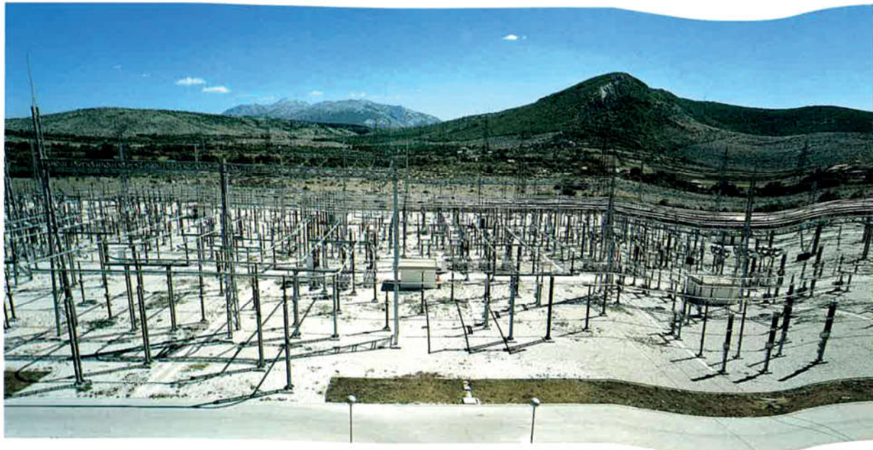
▽ Transformatorska stanica Konjsko 400/220/110 kV, kraj Splita
