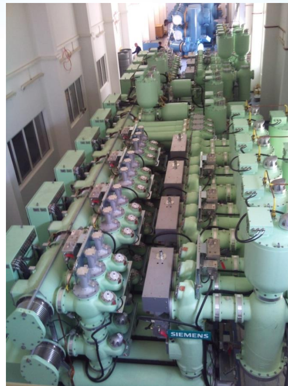
Rasklopno postrojenje 220 kV
