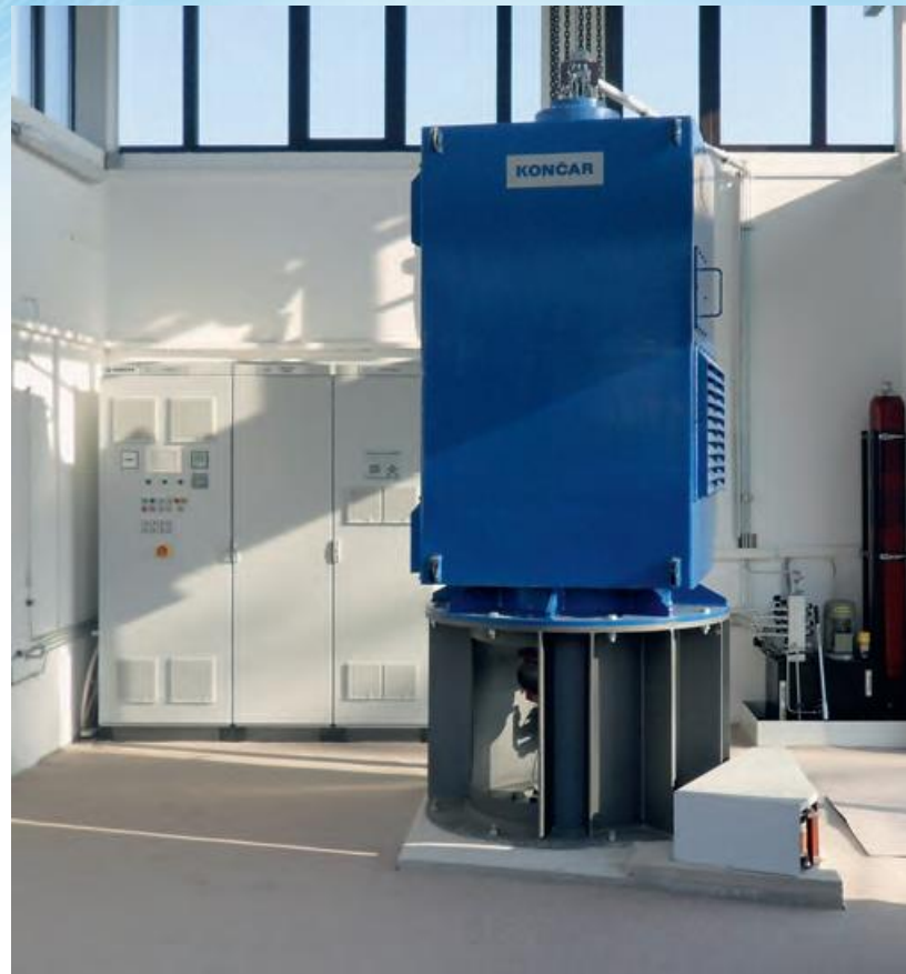
Mala hidroelektrana Pleternica (Republika Hrvatska)
