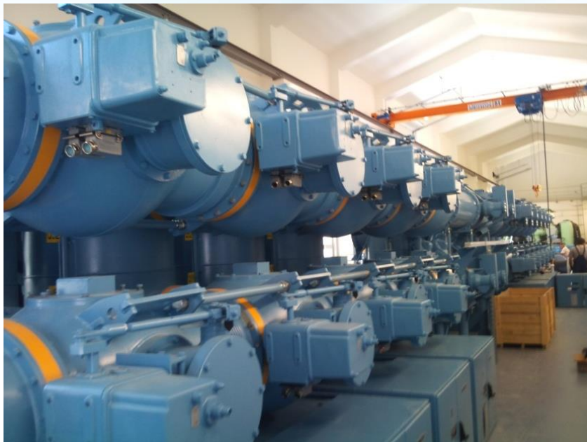
Rasklopno postrojenje 110 kV
