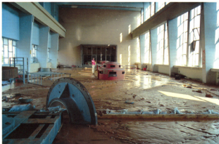
Unutrašnjost strojarnice HE Peruća kojoj je pod pokriven slojem glinovitog materijala debljine i do 0,50 m
