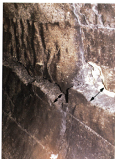
Nizvodni pomak betonskog svoda galerije od oko 15-20 cm
