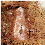
Dio djelomično razrušene galerije na desnom kraju brane
