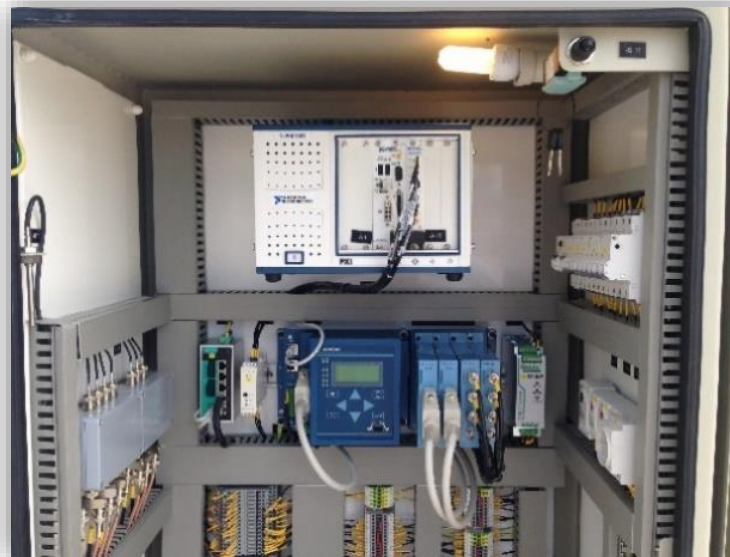
Sustav Končar TMS+ za snimanje prenapona (prigušnica 100 MVar, 110 kV TS Ernestinovo)
