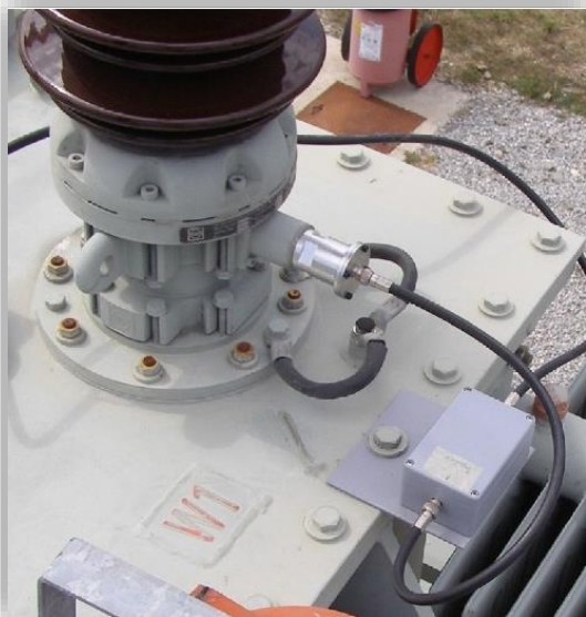
Spojno mjesto na provodnom izolatoru
