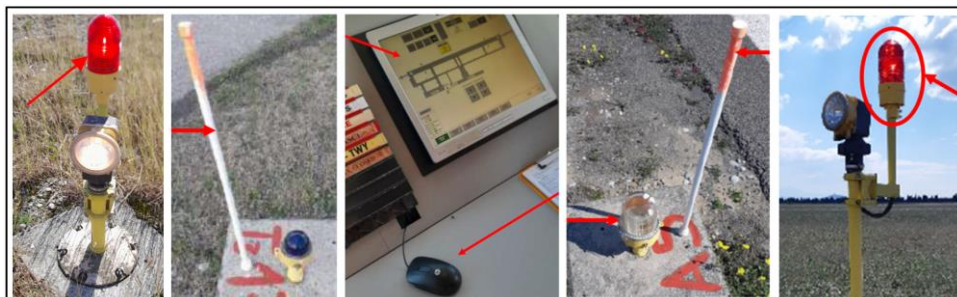
Sl.: 22. Komponente sustava svjetlosne signalizacije na AP TGD - fotografije izvedenog stanja s utvrđenom legislativnom nesukladnosti
