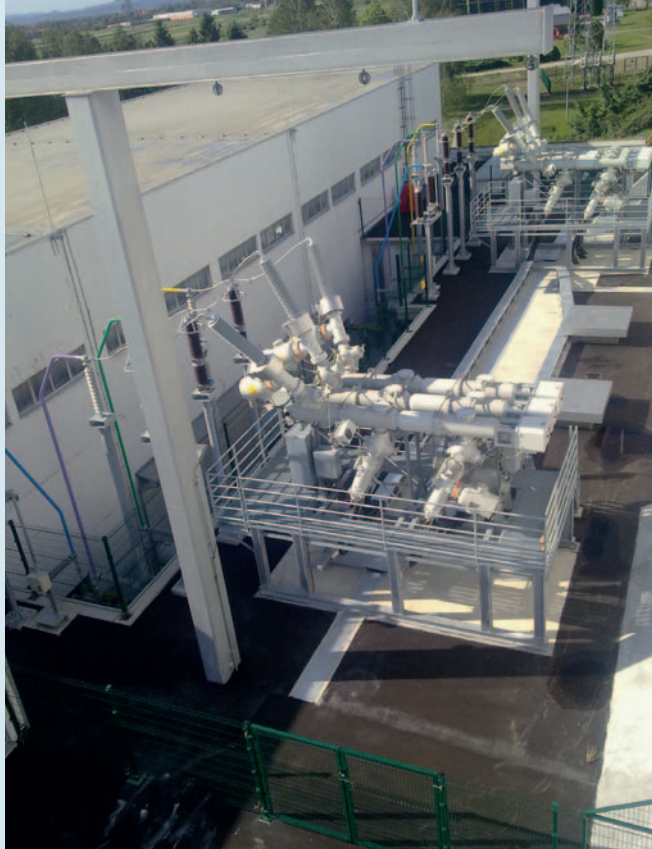
Rasklopno postrojenje 110 kV rekonstruirano je 2012. godine
