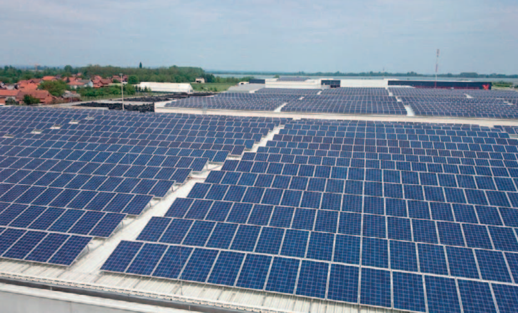
Integrirana sunčana elektrana Gumimpex-GRP priključne snage 1 MW u Slobodnoj zoni Varaždin
