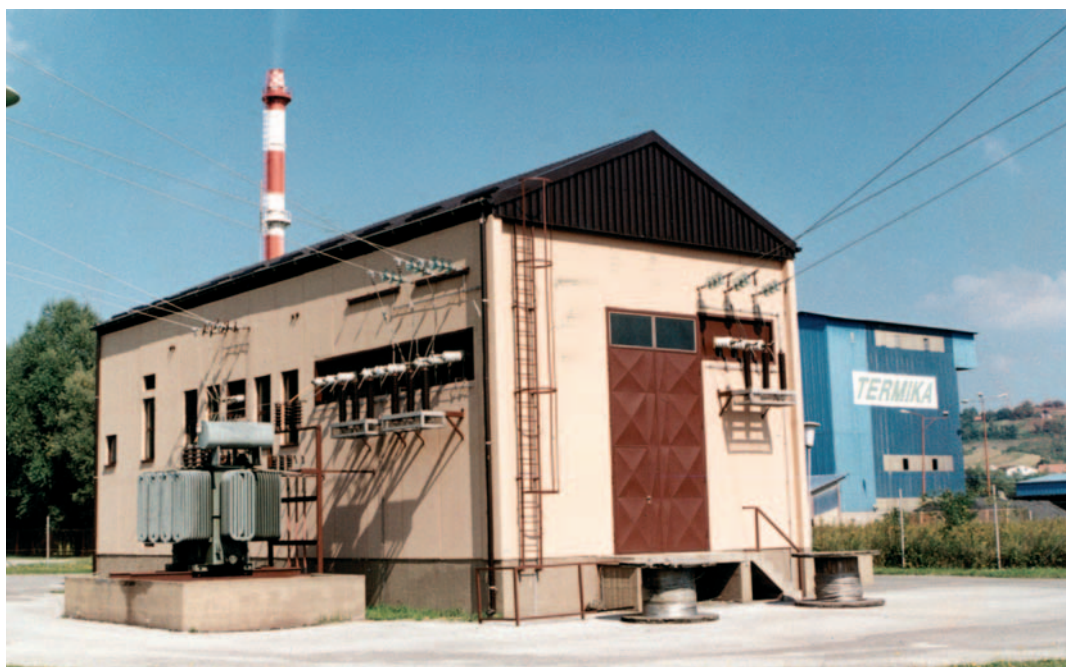
Transformatorska stanica 35/10 kV Novi Marof 2 izgrađena je 1980. godine za potrebe novih industrijskih pogona
