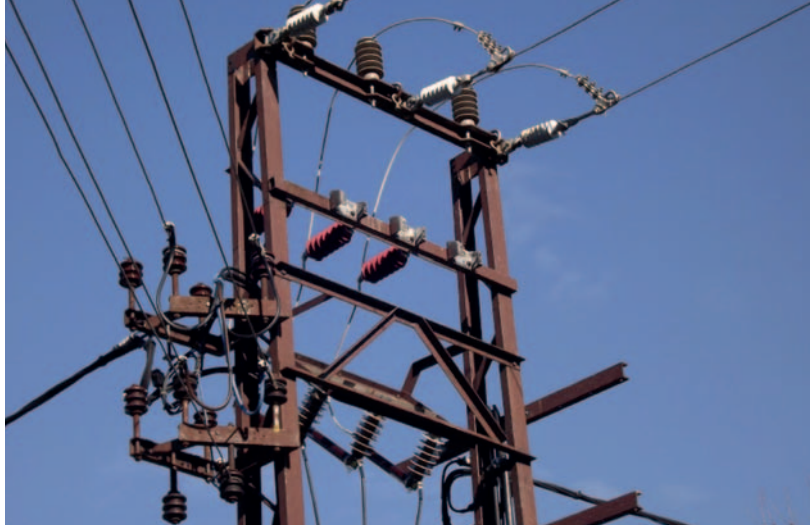
Stupna transformatorska stanica 10 kV s opremom napona 20 kV
