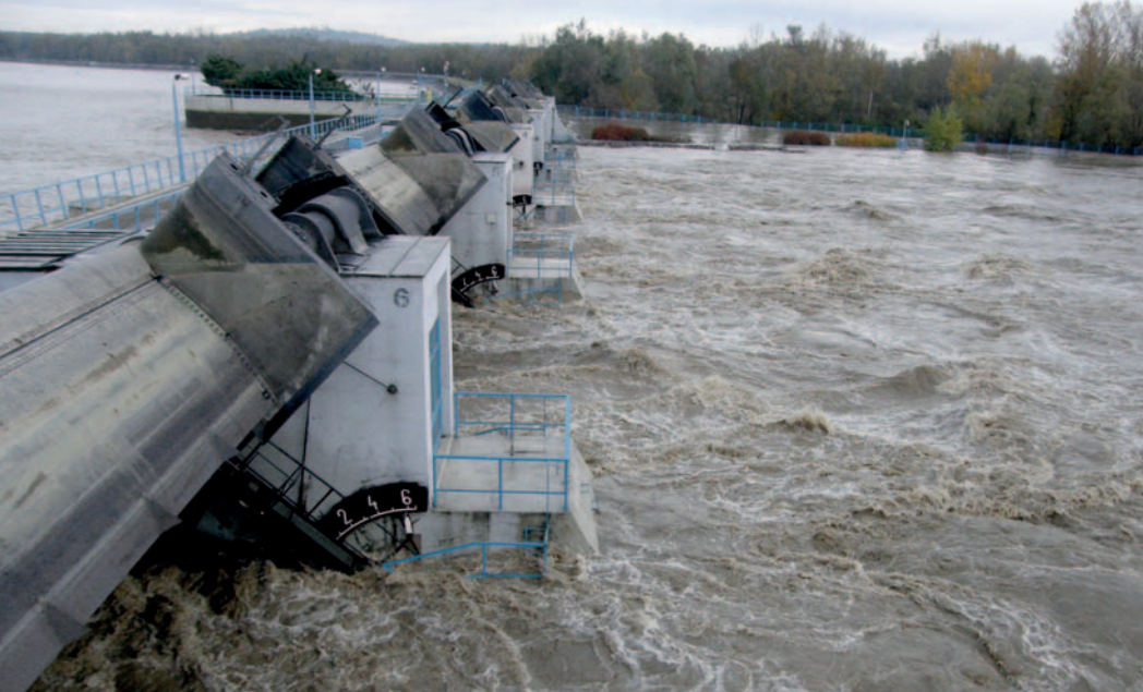
Potpuno otvorena pokretna brana Hidroelektrane Varaždin za vrijeme stogodišnje velike vode 6. studenog 2012. godine
