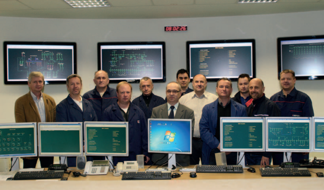
Nova oprema i programi izazov su za dispečere i zaposlenike Odjela za procesne sustave
