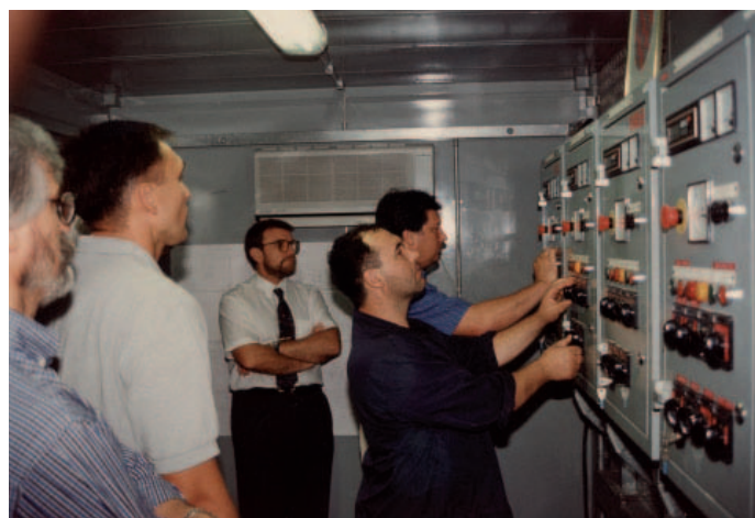
PRED PUŠTANJE U RAD INTERVENTNE DIZELSKJE ELEKTRANE U TRANSFORMATORSKOJ STANICI VUKOVAR II.
