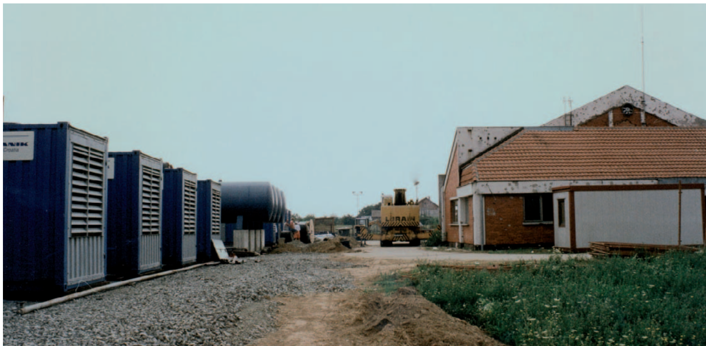
... U TRANSFORMATORSKOJ STANICI VUKOVAR III.
