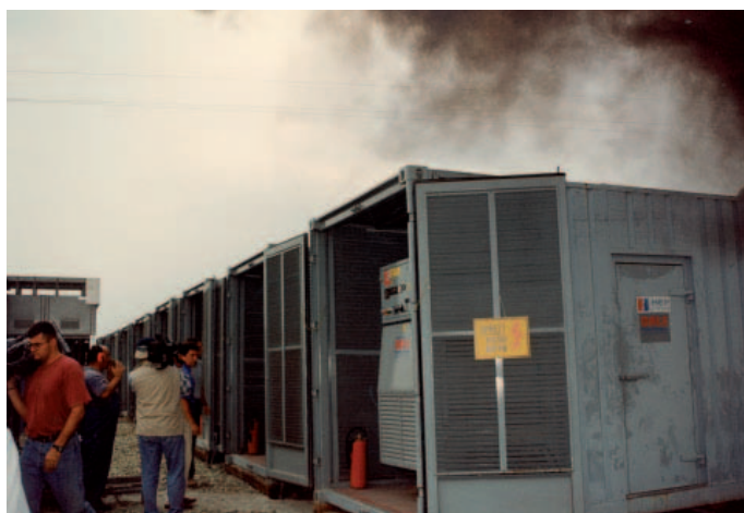
PUŠTENA JE U RAD INTERVENTNA DIZELSKA ELEKTRANA U TRANSFORMATORSKOJ STANICI 110/35 kV DALJ...
