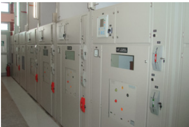
Slika 16/V. Unutrašnjost postrojenja TS 35/10(20) kV Slatina II
