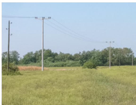
Slika 17/IV. 10(20) kV zračni dalekovod na armiranobetonskim stupovima pored starog dalekovoda na drvenim stupovima
