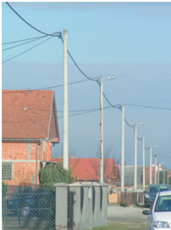
Slika 4/II. Niskonaponska zračna mreža na armiranobetonskim stupovima
