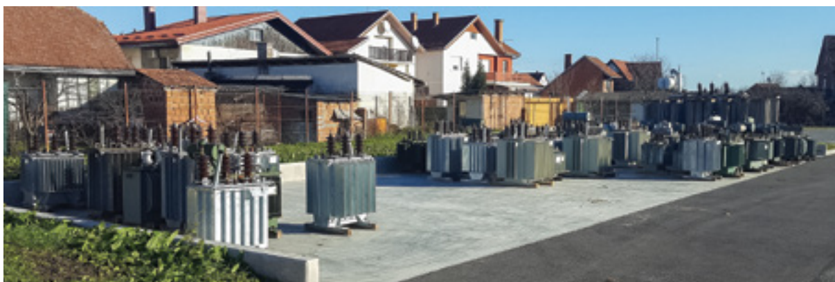
Slika 52/IV. Skladište transformatora
