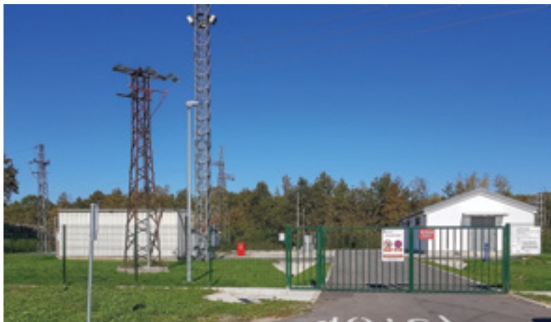
Slika 27/IV. TS 35/10(20) kV Voćin
