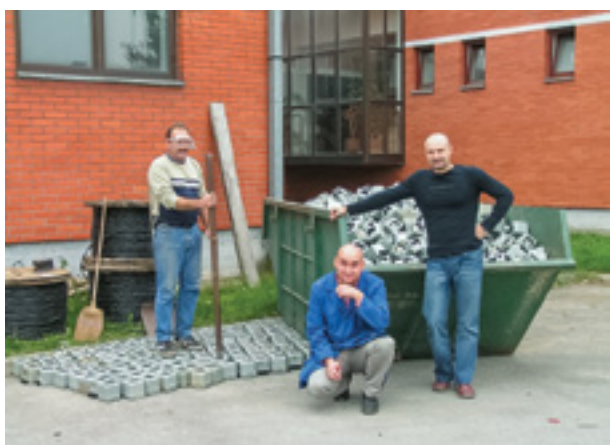
Slika 6/V. Izgradnjom MTU postrojenja u Pogonu Slatina zamijenjeno je oko 6000 uklopnih satova
