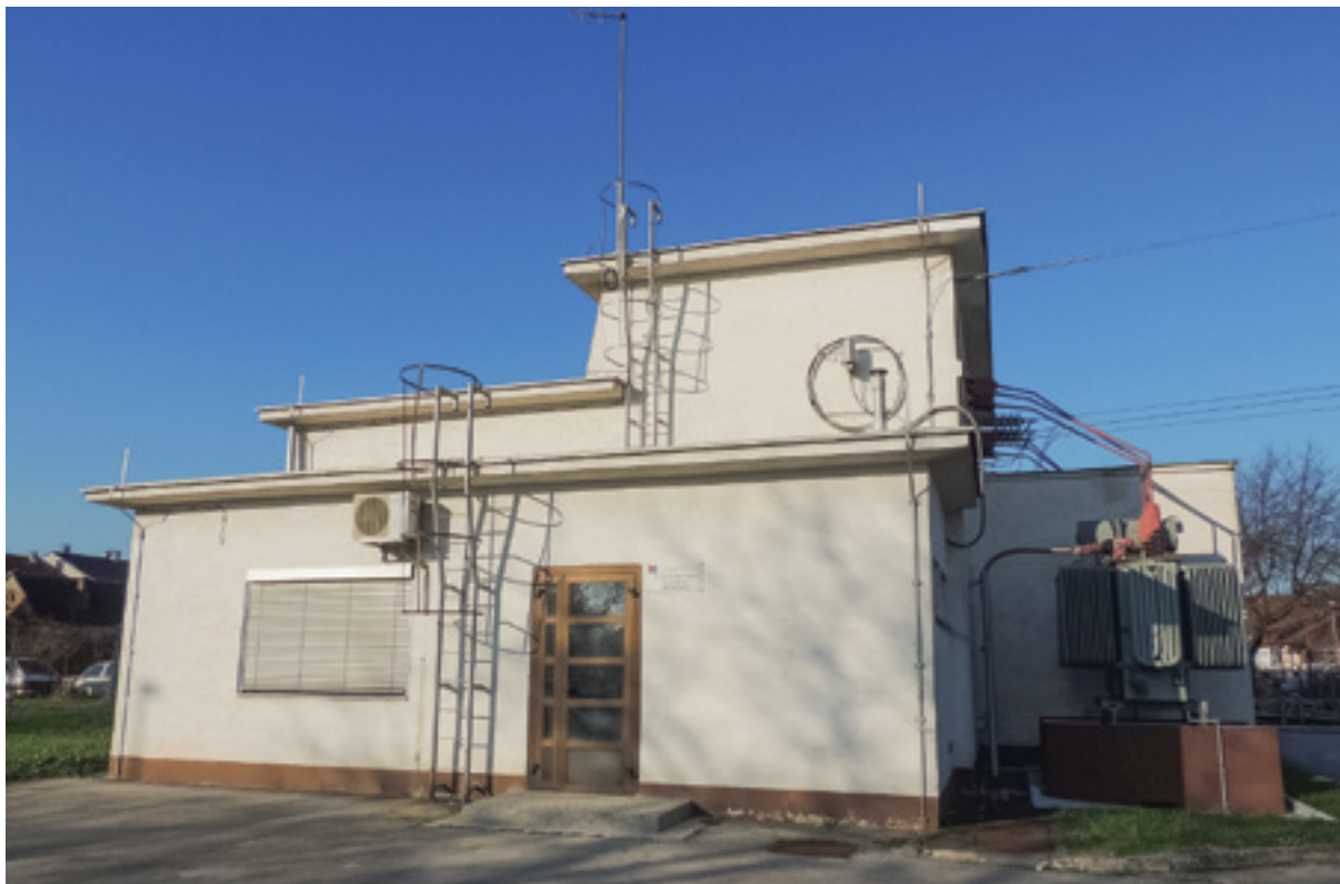
Slika 7/III. TS 35/10(20) kV Virovitica II
