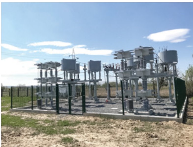
Slika 34/V. Nova 35 kV kompenzacija u TS 110/35/10(20) kV Virovitica 1
