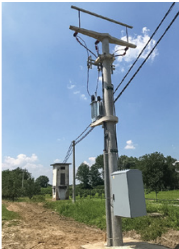
Slika 55/V. Zračna TS 10(20)/0,4 kV opremljena izolacijskim materijalima koji sprječavaju elektrokuciju ptica
