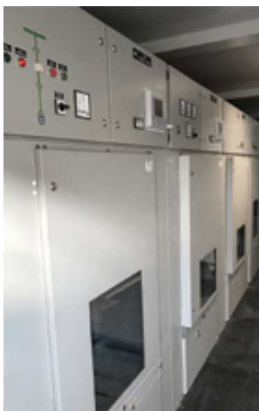
Slika 30/V. Unutrašnjost privremenog 35 kV postrojenja Virovitica
