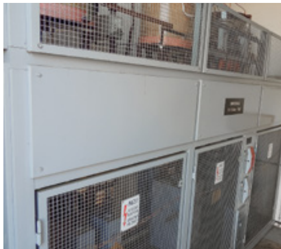
Slika 17/III. 10 kV kompenzacija na TS 35/10 kV Virovitica III
