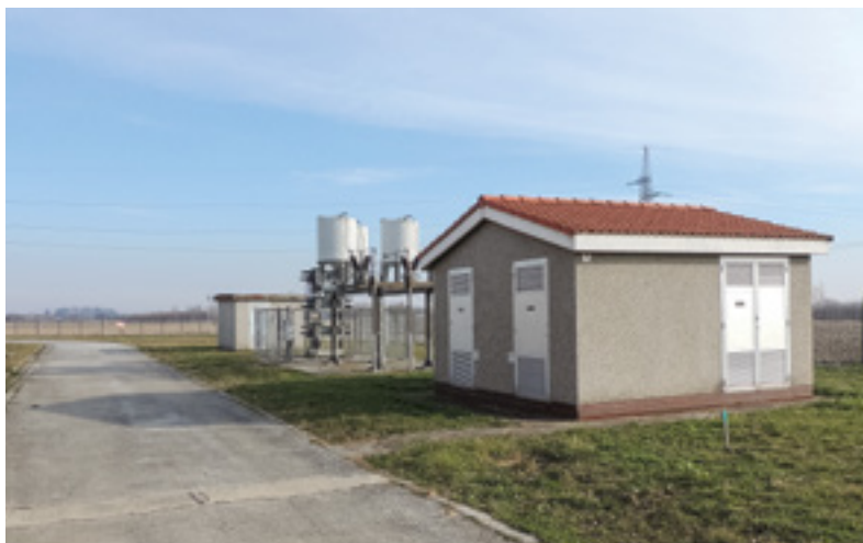
Slika 7/V. MTU, filtri, 10 i 35 kV kompenzacijsko postrojenje Slatina
