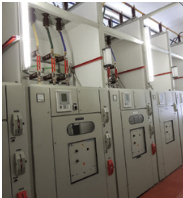
Slika 8/III. Unutrašnjost TS 35/10(20) kV Virovitica II
