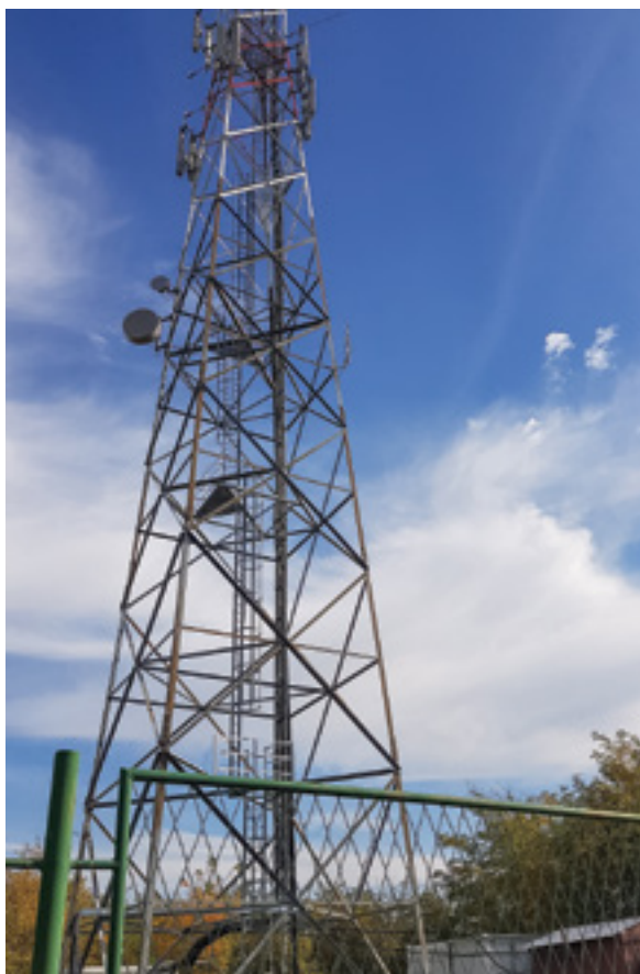
Slika 40/V. Bazna stanica PRKOS
