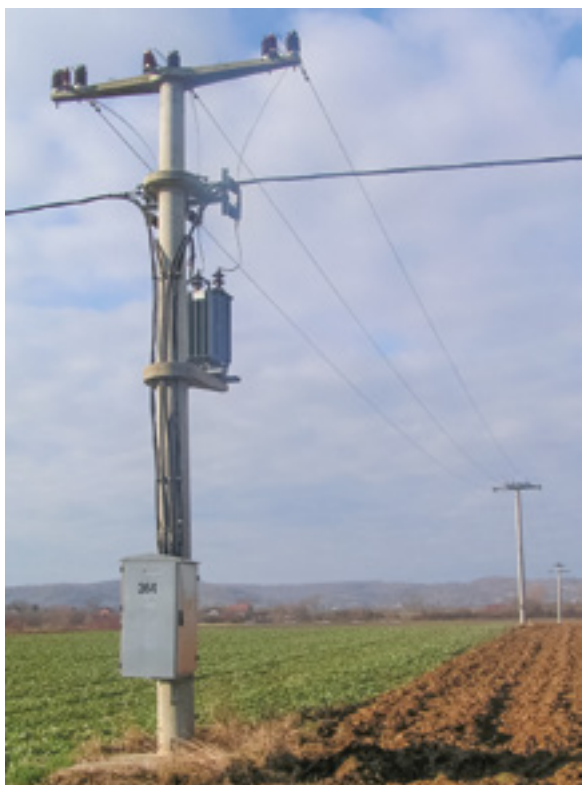
Slika 2/II. Transformatorska stanica 10/0,4 kV na armiranobetonskom stupu
