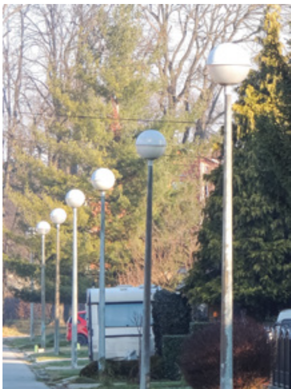
Slika 7/II. Stupovi javne rasvjete visine 5 m
