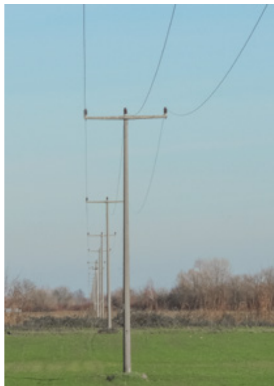
Slika 1/II. 10(20) kV dalekovod na betonskim stupovima
