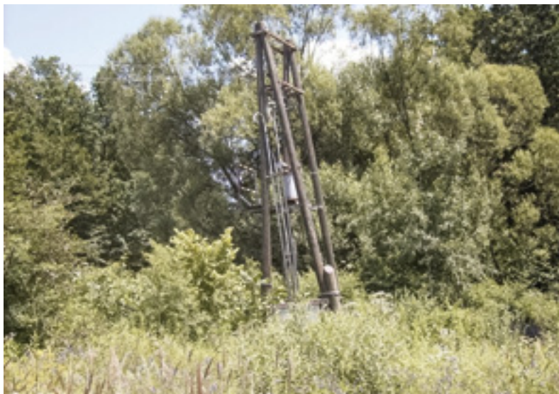
Slika 11/IV. Trafostanica 10/0,4 kV na drvenim stupovima (Lukavac II) u lošem stanju.
