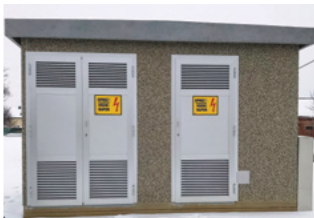
Slika 3/II. Kabelska transformatorska stanica 10/0,4 kV
