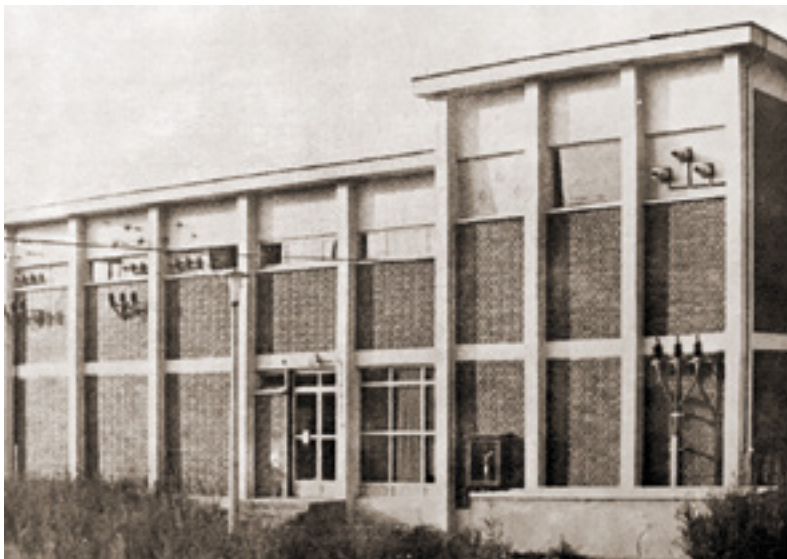
Slika 9/I. Trafostanica 35/10 kV u Suhopolju
