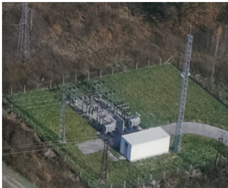
Slika 26/V. TS 35/10(20) kV Voćin, 2000. g.
