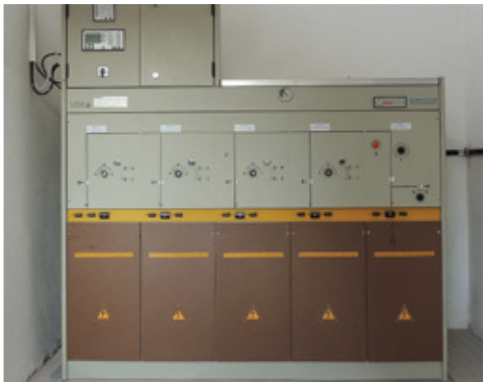
Slika 38/V. Daljinski upravljivi sklopni blok
