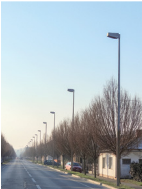
Slika 6/II. Stupovi javne rasvjete visine 10 m
