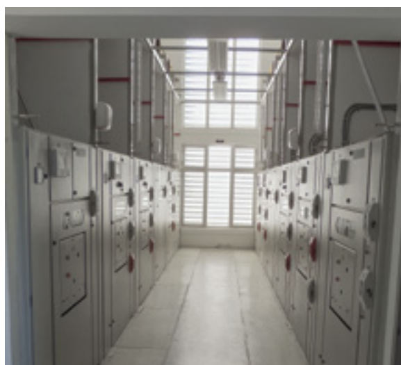
Slika 24/V. Unutrašnjost postrojenja 35/10(20) kV Špišić Bukovica
