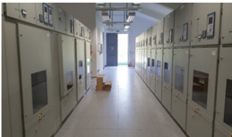
Slika 28/V. Unutrašnjost postrojenja TS 35/10(20) kV Voćin
