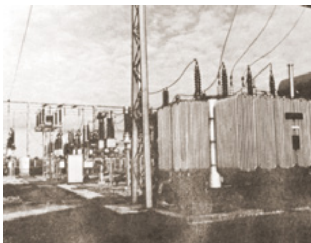
Slika 6/I. Energetsko postrojenje 110/35 kV trafostanice u Virovitici
