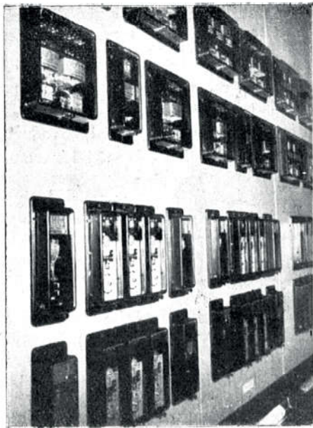
Sl. 17 — Relejske ploče glavne rasklopnice
