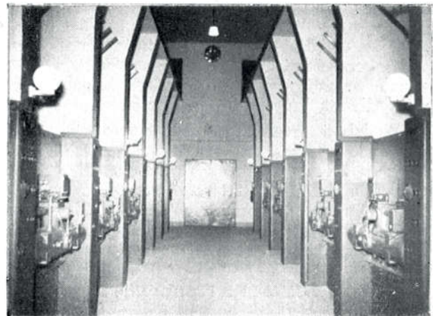
Sl. 14 — Rasklopno postrojenje 30 kV
