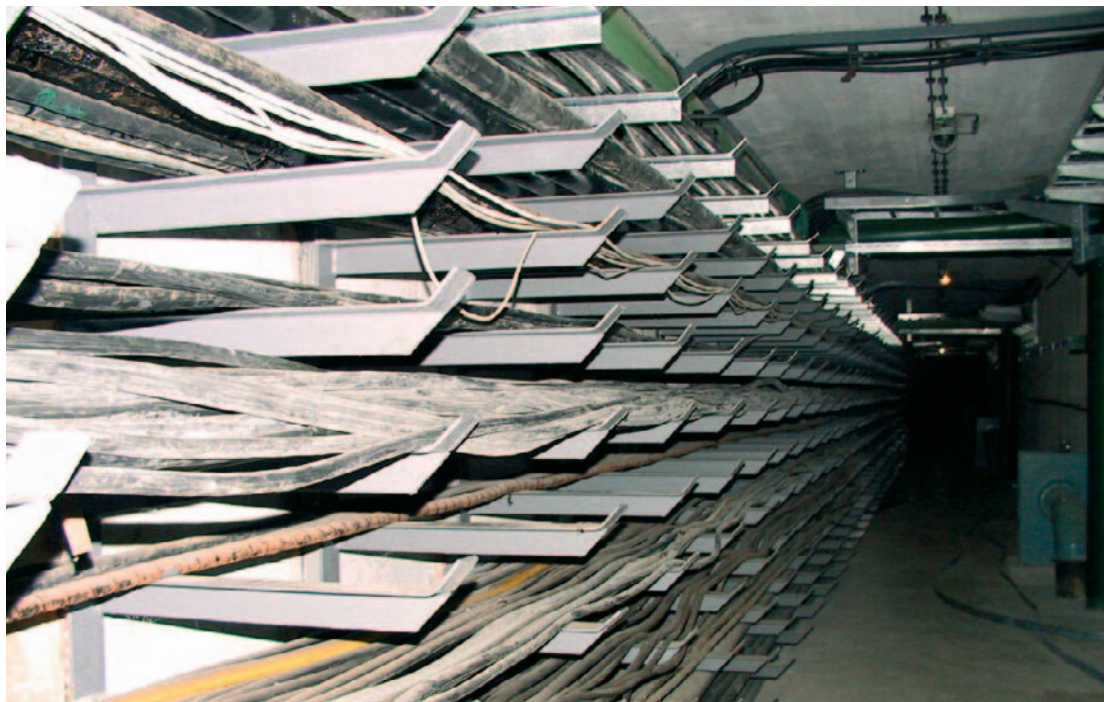
Snopovi kabela - poveznice naloga i izvršenja
