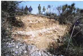
Foto 9. 16. veljače 1993 godine Krater na sta: 1+52,16 do 1+62,61 - pogled uzvodno
