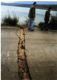
Foto 3. Poprečna pukotina na kruzi brani
