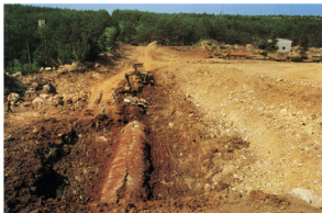
Foto 27. 2. srpnja 1994 Desni kraj brane - oštećenja tjemena injeckijske galerije od sta: 3+42,00
