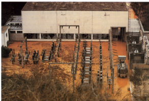
Foto 1. 29. siječnja 1993. godine - Pogled na drenažni bunar u rasklopnom postrojenju
