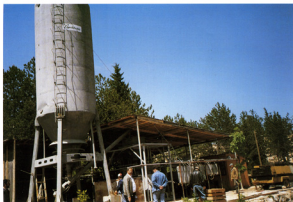
Foto 48. Glavna injekcijska stanica
