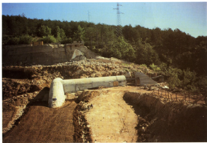
Foto 30. Djelomično zatrpana obnovljena galerija
