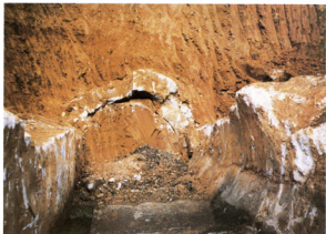
Foto 26. Srušeni dio galerije na lijevom boku brane
