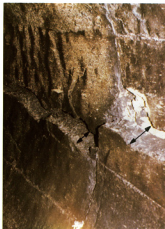
Foto 10. Nizvodni pomak svoda galerije od oko 10-20 cm
