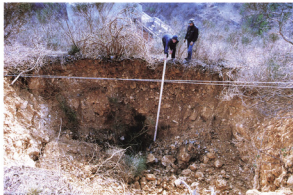
Foto 10. 16. veljače 1993 godine Krater na sta: 1+52,16 do 1+62,61 - pogled nizvodno
