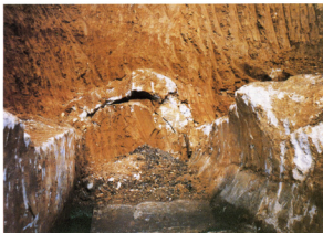
Foto 1. Glinena jezgra na najnižem dijelu iskopa lijevog kraja brane s razrušenom galerijom
