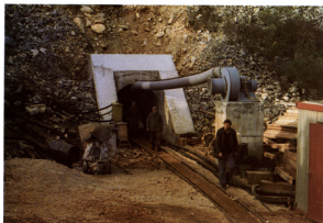
Foto 5. Ulaz u pristupni hodnik br. 2 s uređajem za ventilaciju
