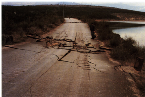
Foto 5. Ulegnuće krune na najvišem dijelu brane
