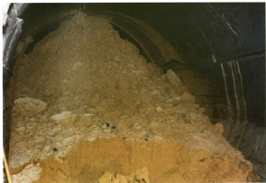
Foto 11. Urušena galerija na sta: 3+42,00
