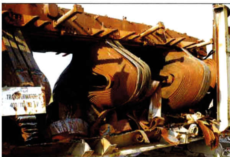
Transformator 400/110 kV, 300 MVA u TS Ernestinovo, razoren u ratu 1991. godine, bakar opljačkan pod privremeno- nom okupacijom nakon rata
