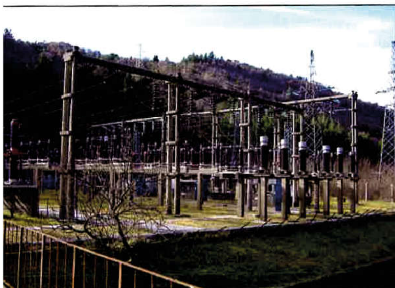
TS 110/35 kV Kraljevac, kao rasklopna stanica 110 kV u pogonu od 1955. godine (snimak iz 2006. godine)
