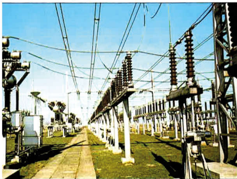
TS 220/110 kV Mraclin, postrojenje 220 kV, u pogonu od 1962. godine
