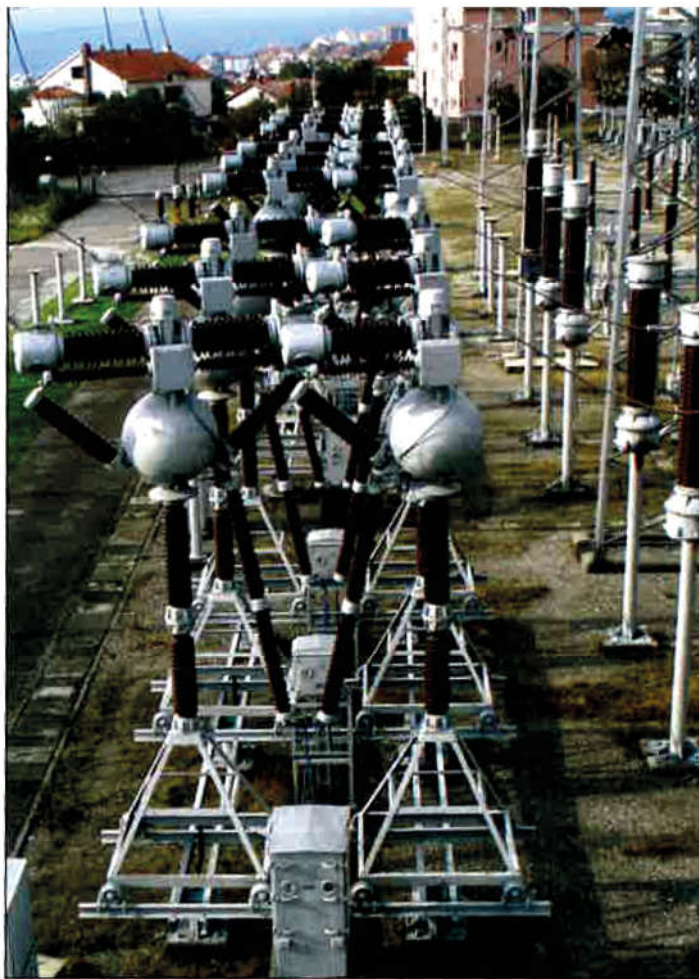
TS 220/110/35 kV Pehlin, postrojenje 220 kV (sadašnje stanje), u pogonu od 1970. godine
