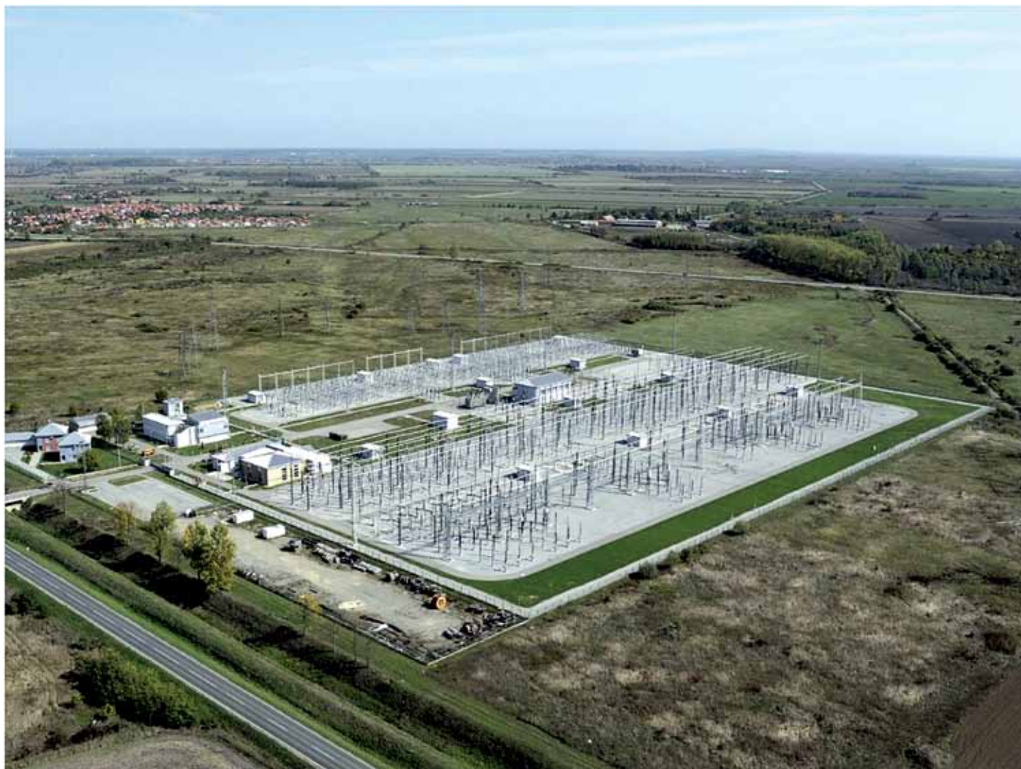
TS 400/110 kV Ernestinovo nakon obnove 2004. godine
