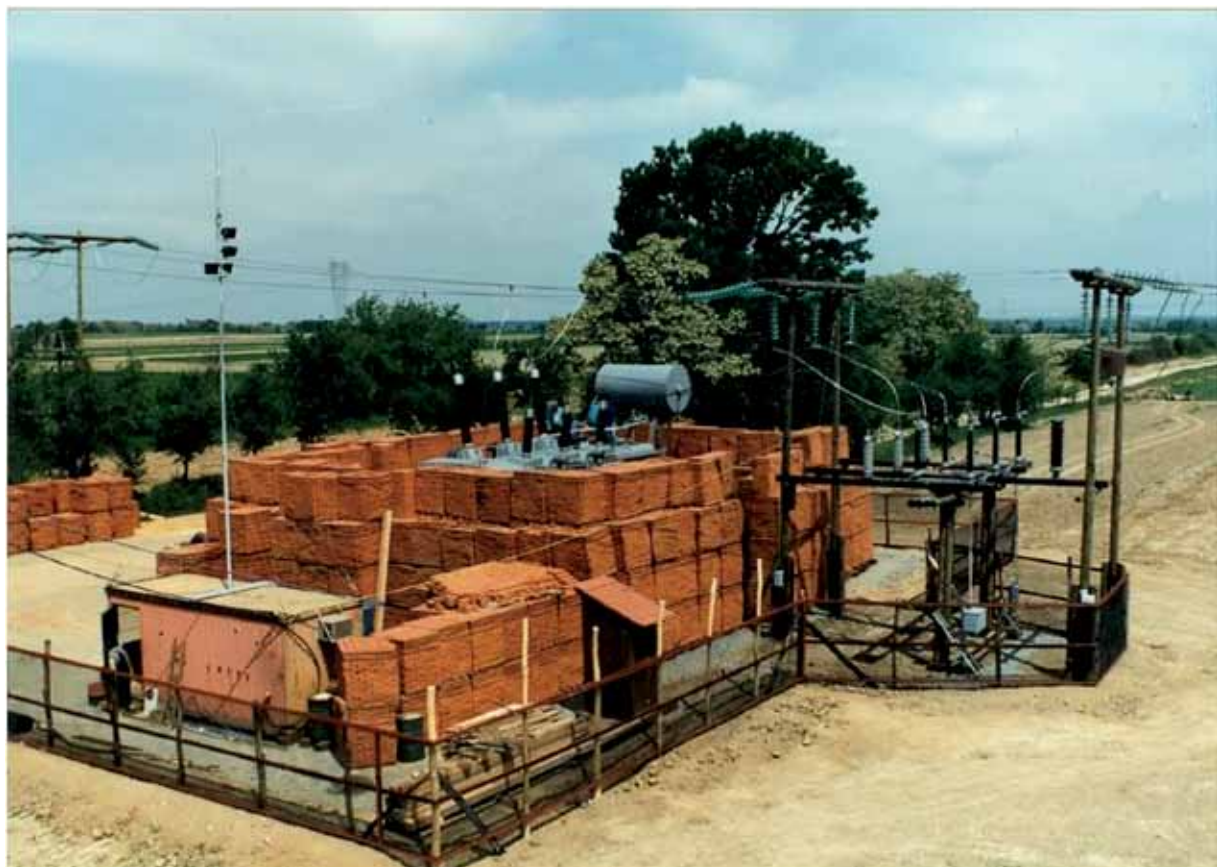
Najznačajniji privremeni objekt superponirane mreže Hrvatske: TS 220/110 kV „1505/2“, 150 MVA, u korištenju od 1992. do 2004. godine
