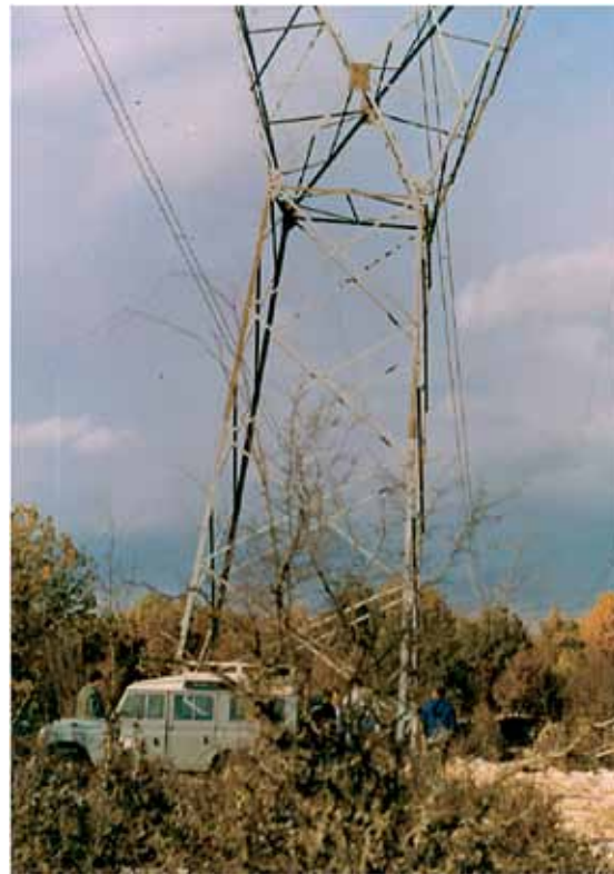
Minirani stup br. 245 dalekovoda 400 kV Konjsko–RHE Obrovac
