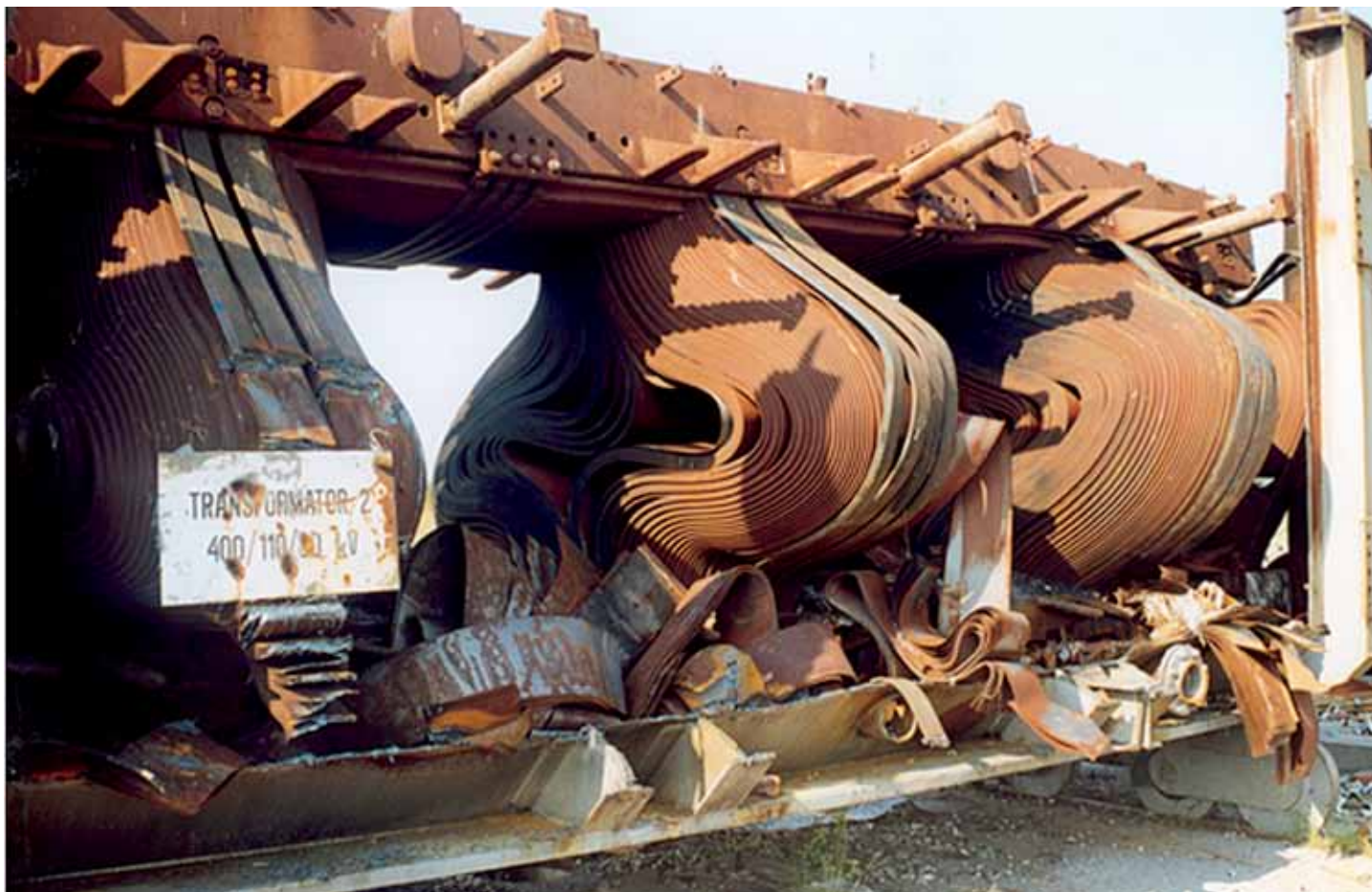
Pljačka bakra transformatora 400/110 kV, 300 MVA u TS Ernestinovo tijekom okupacije
