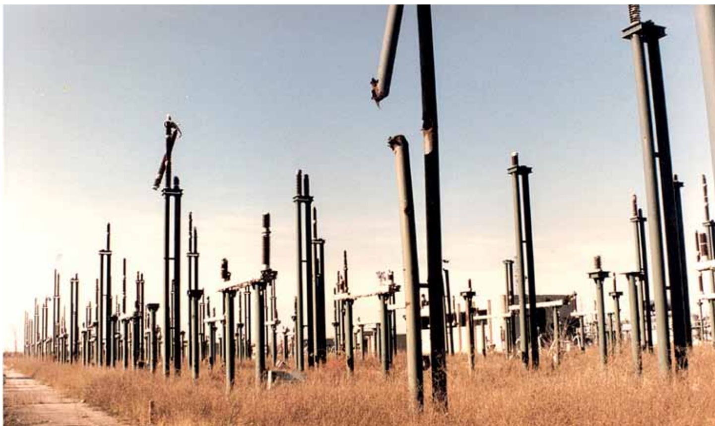
Razoreno postrojenje 400 kV u TS 400/110 kV Ernestinovo
