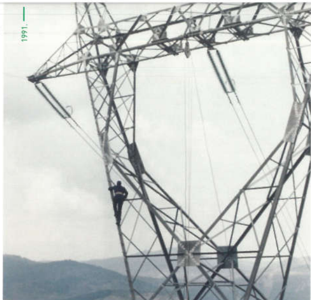
Jedna od novina na dalekovodu 400 kV Melina-Tumbri su stupovi sa suženom glavom, čime je postignuta ušteda u materijalu i prostornom koridoru
