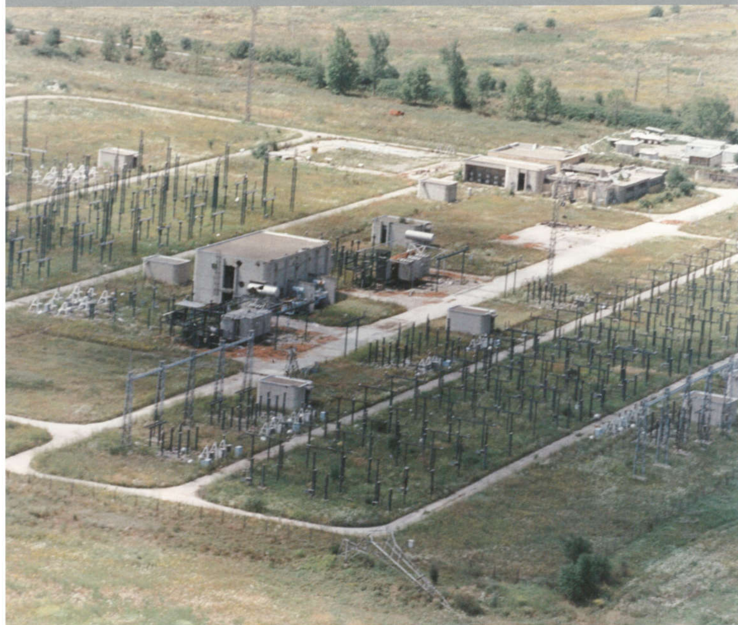
Razorena, uništena, opljačkana transformatorska stanica 400/110 kV Ernestinovo - ono što je od nje ostalo
