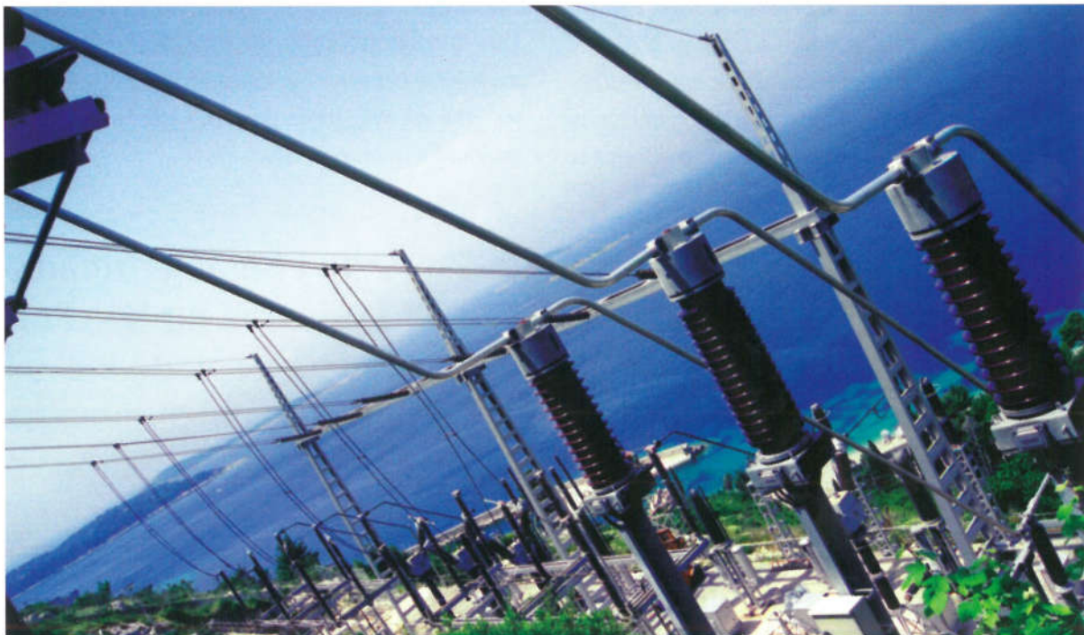
Rasklopno postrojenje Hidroelektrane Plat
