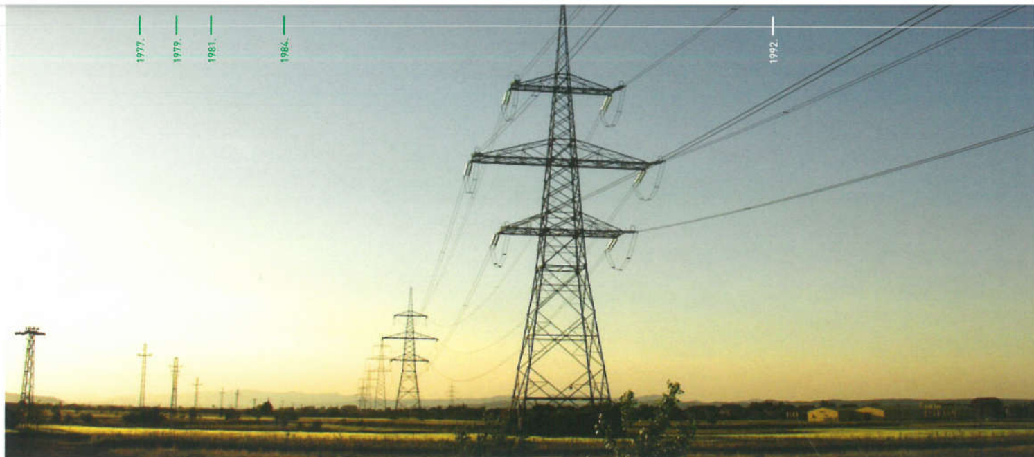
Dalekovod 400 kV Tumbri–Krško
