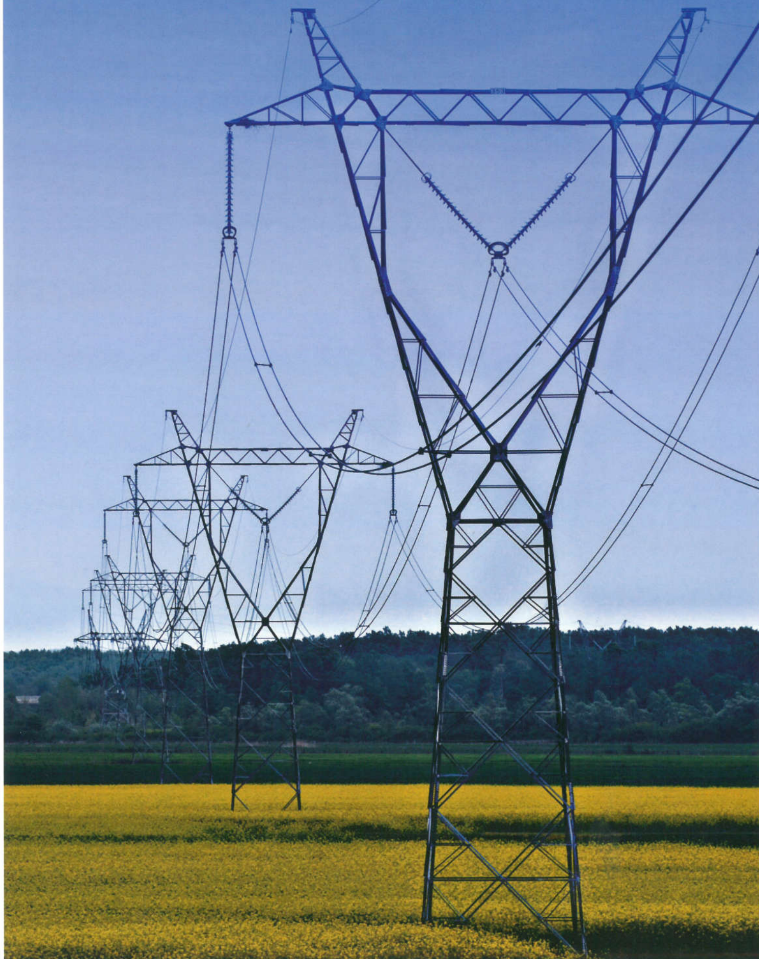
Dalekovod 400 kV Melina-Tumbri kod Jastrebarskog i...
