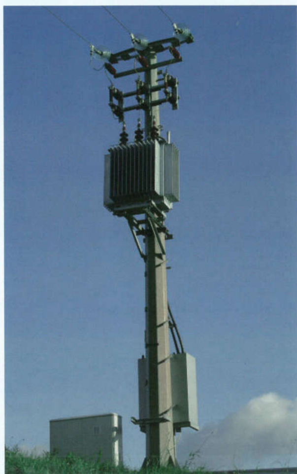
Zahvaljujući tipizaciji pojednostavljena je i ubrzana izvedba stupnih transformatorskih stanica 10(20)/0,4 kV
