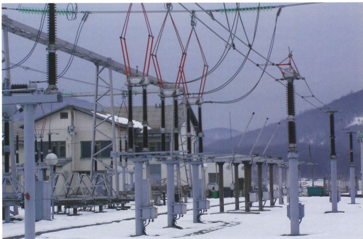
Rasklopno postrojenje 220 kV Brinje
