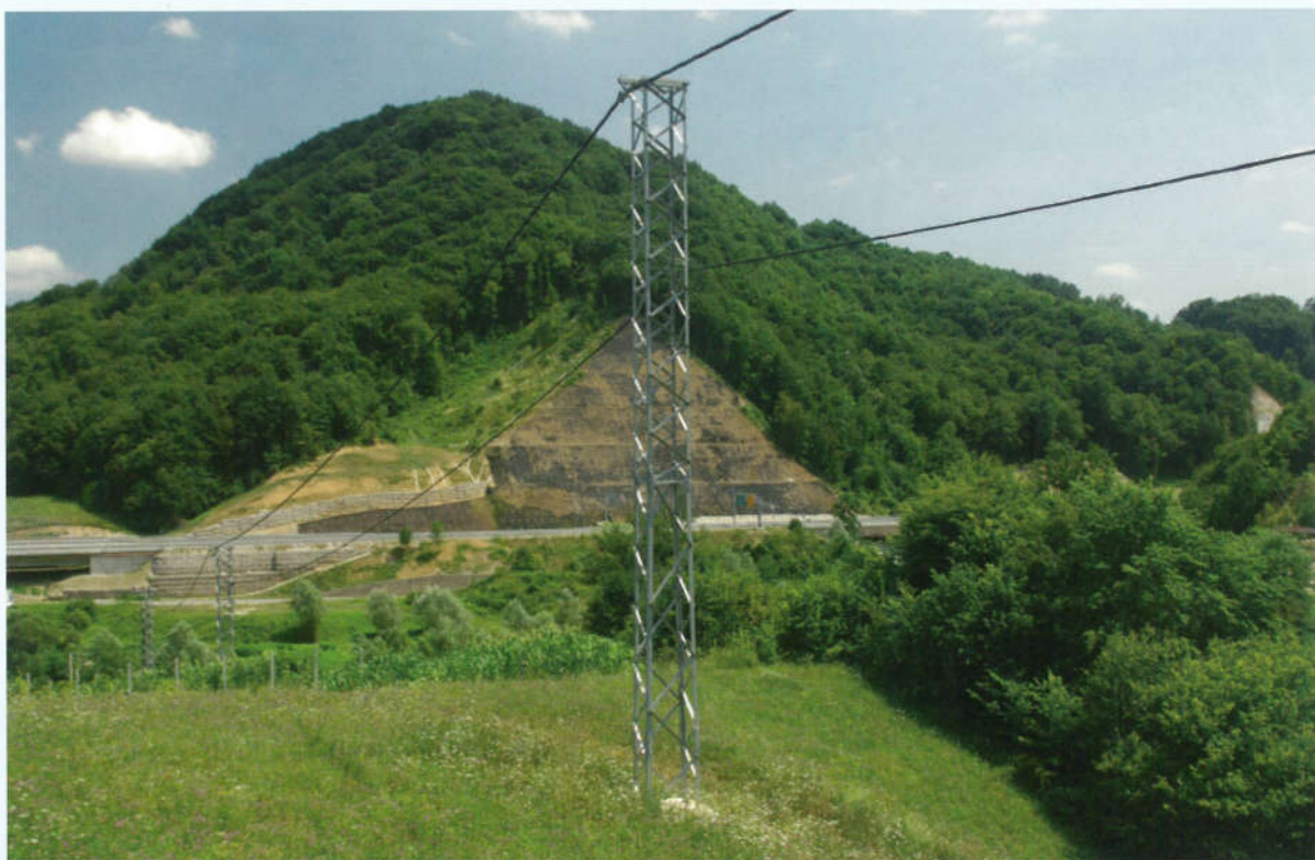
Dalekovod 20(10) kV na trasi Podgora-Đurmanec
