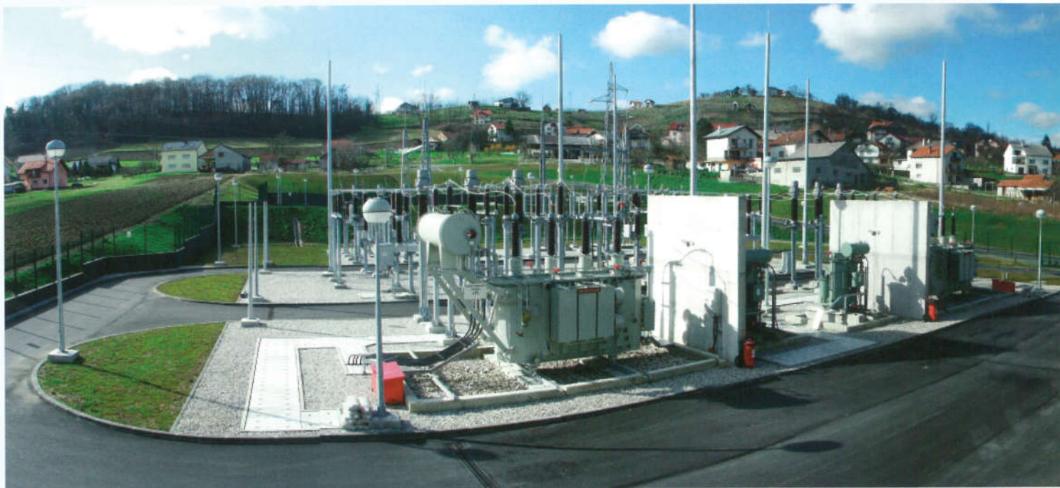
Transformatorska stanica 110/35 kV Bobovje
