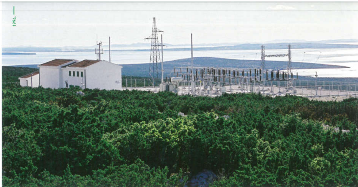
Transformatorska stanica 110/35/10 kV Novalja izgrađena u okviru Otočne veze , projekta koji je osiguravao rješenje za otočni rad Dalmacije i dvostruko napajanje Zadra električnom energijom
