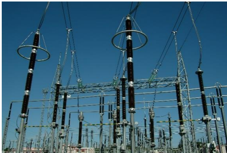
Transformatorske stanice do 400 kV
