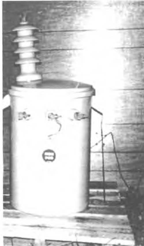
Abb. 2: Hochleistungstrafo aus den USA
