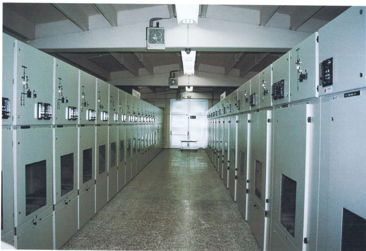
Uključeno postrojenje TS 35/10 kV u zgradi TS 110/35 kV trafostanice u Selniku kraj Ludbrega
