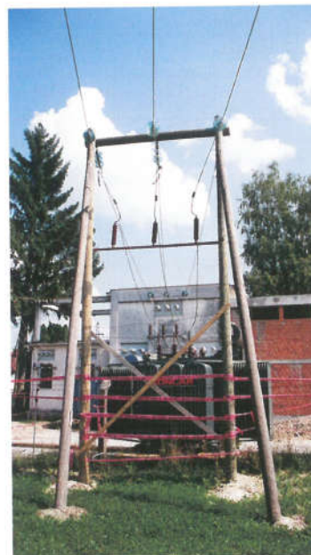
Dalekovod i transformatorsko postrojenje u TS 35/10 kV u Đurđevcu
