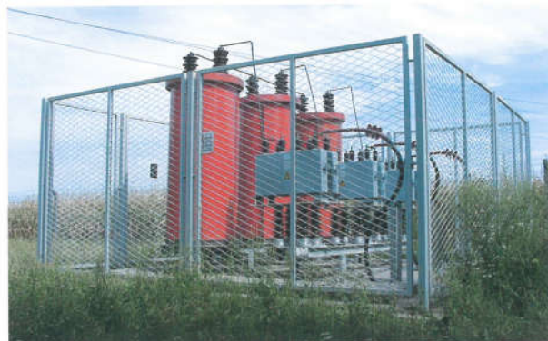
Dio opreme sustava mrežnotonfrekventnog upravljanja u sklopu postrojenja 110/35 kV trafostanice u Koprivnici
