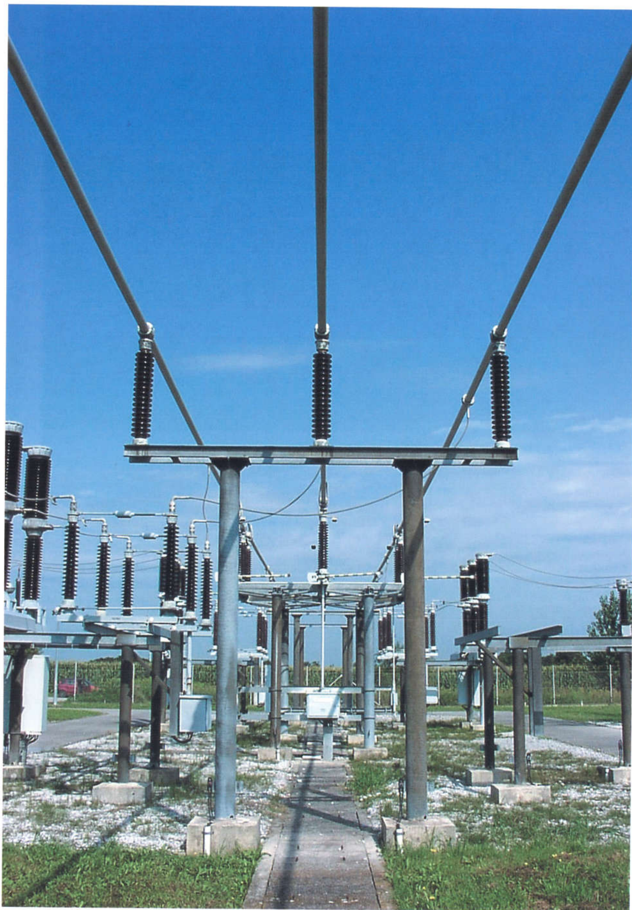
Dio trafostanice 110/35 kV i početak dalekovoda kod Virja
