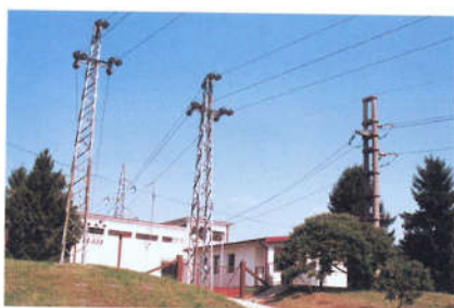
Obnovljena TS 35/10 kV u Pitomači
