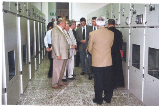
Unutrašnjost TS 35/10 kV u Selniku kraj Ludbrega
