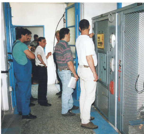
Dio unutrašnjeg postrojenja u TS 35/10 kV Novigrad
