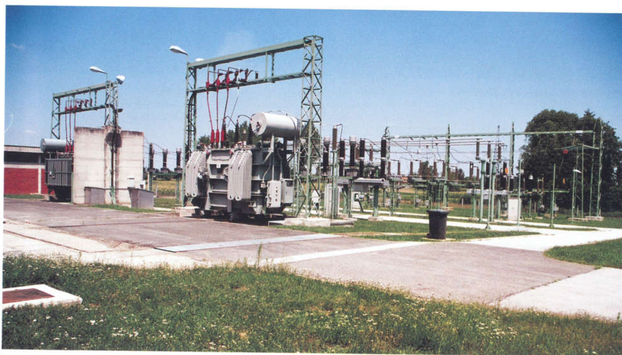
Suvremena transformatorska postrojenja u TS 110/35 kV u Selniku
