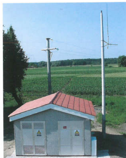
Pogled na rasklopište RS(TS) 10(20)/0,4 kV u Ferdinandovcu
