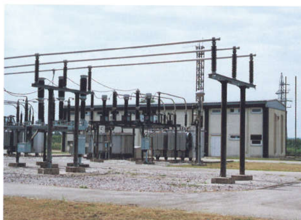
TS 110/35 kV u Virju sagrađena je 1986. godine uglavnom za potrebe opskrbe strujom postrojenja za eksploataciju zemnoga plina
