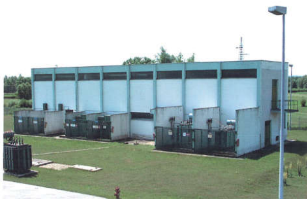
TS 35/10 kV za potrebe naftovoda JANAF sagrađena je 1980. godine
