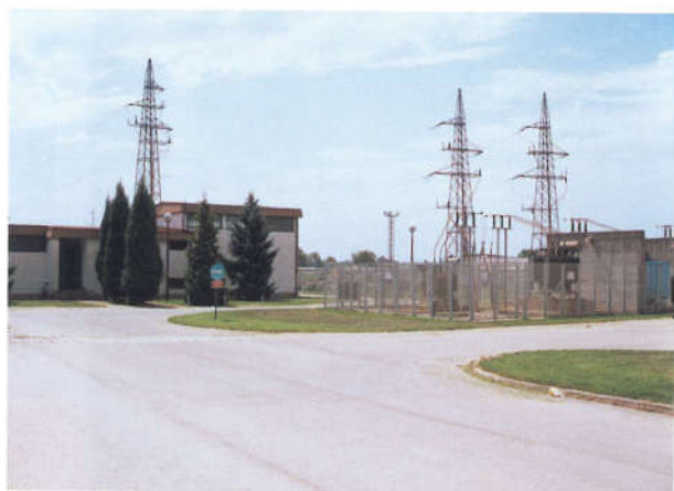
Trafostanica 35/6 kV za centralne plinske stanice u Molvama građena je 1980. i modernizirana 1985. godine
