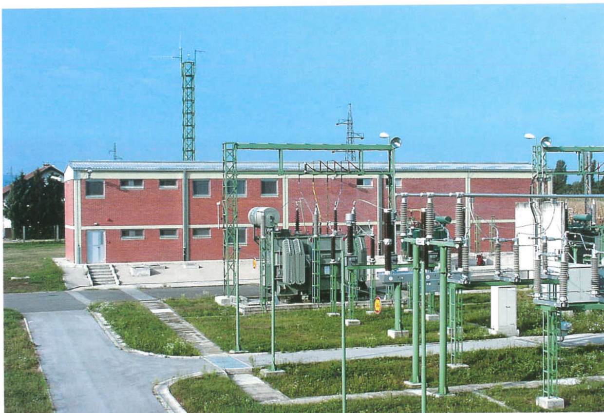
Trafostanica 110/35 kV u Selniku kraj Ljubrega
