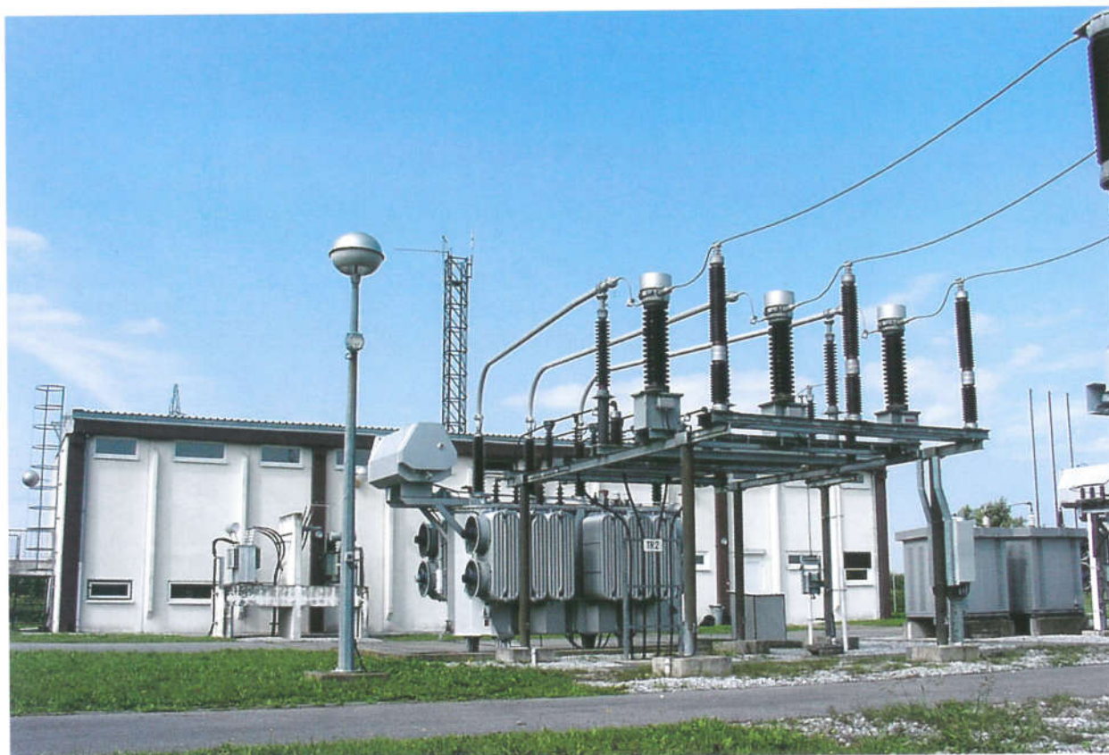
Trafostanica 110/35 kV u Virju
