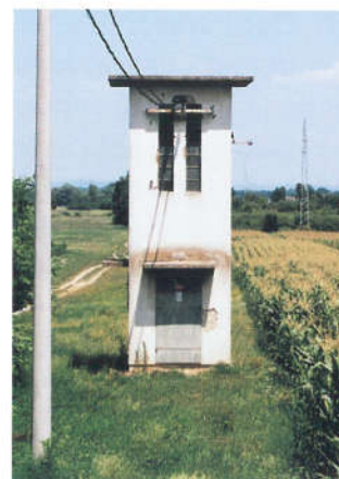
Trafostanica 10/0,4 kV između Cvetkovaca i Rasinje
