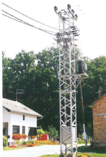
Trafostanica na željeznom stupu 10/0,4 kV - snimljeno u okolici Ludbrega
