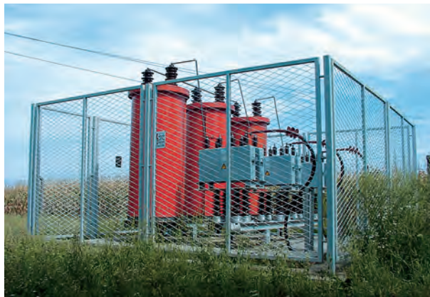
Dio opreme sustava mrežnotonfrekventnog upravljanja u sklopu postrojenja 110/35 kV trafostanice u Koprivnici
