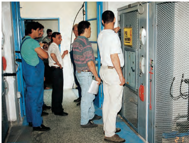
Dio unutrašnjeg postrojenja u TS 35/10 kV Novigrad
