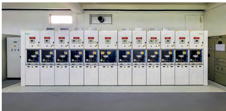
Postrojenje 35 kV u TS 110/35 kV Virje
