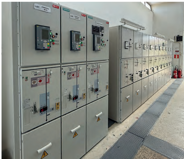
10(20) kV postrojenje u TS 35/10(20) kV Koprivnica II.
