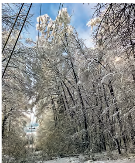
Primjer pada drveća opterećenog snijegom na zračni dalekovod koji samoobnavljajuća mreža sama izolira
