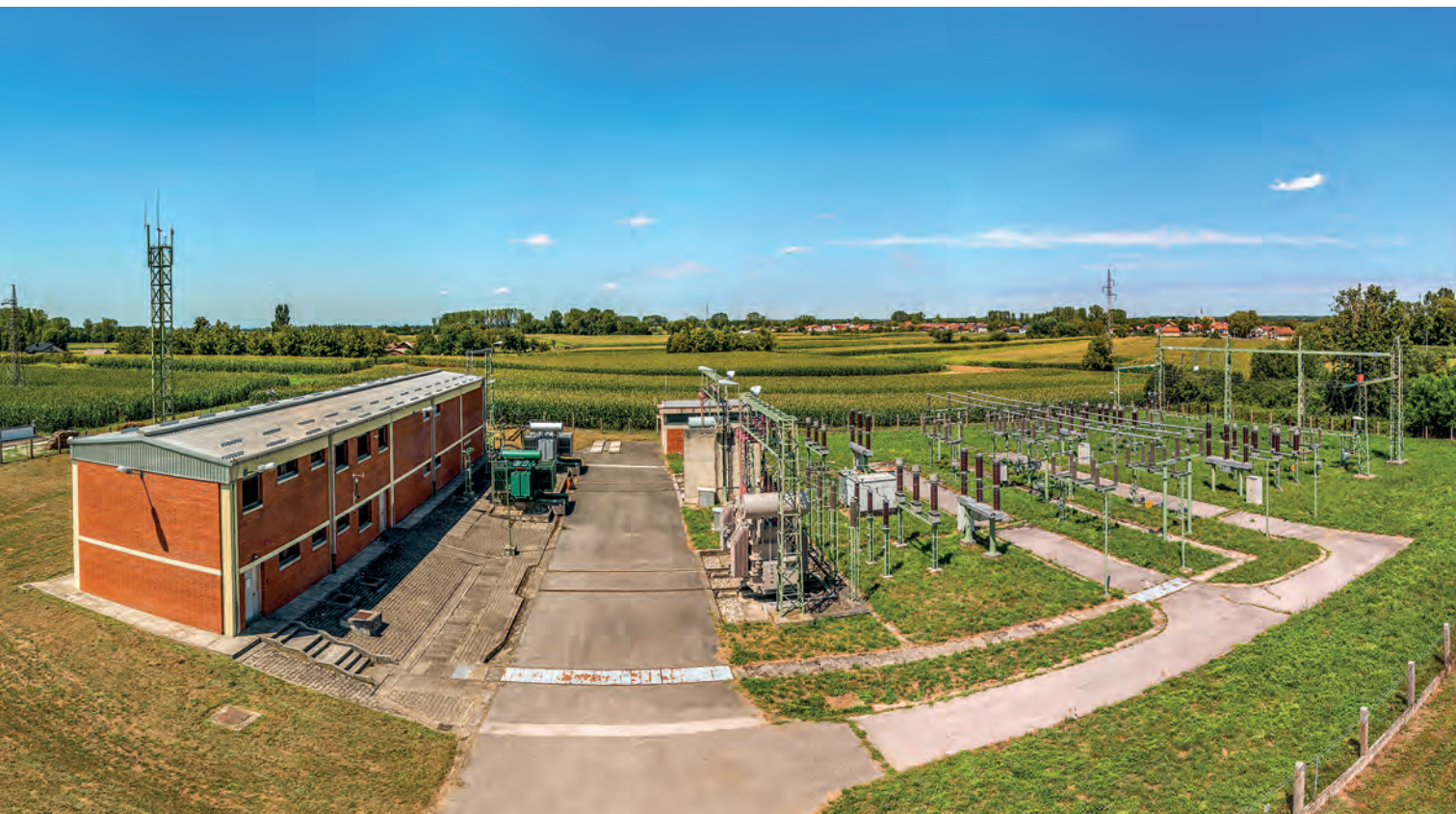
Trafostanica 110/35/20 kV Selnik kraj Ludbrega
