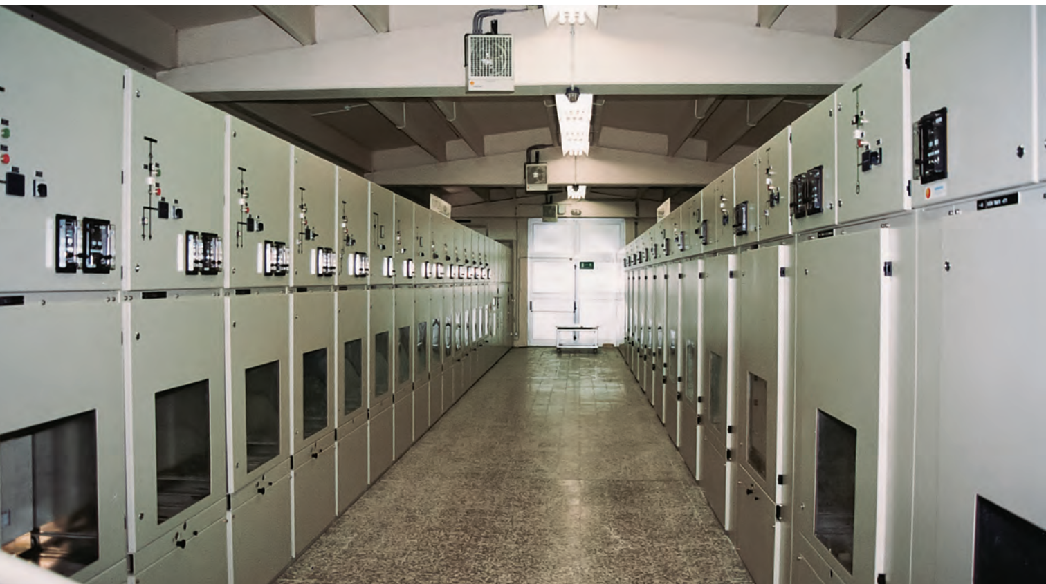
Oklopljeno postrojenje 35 kV i 20 kV u zgradi TS 110/35/20 kV Selnik
