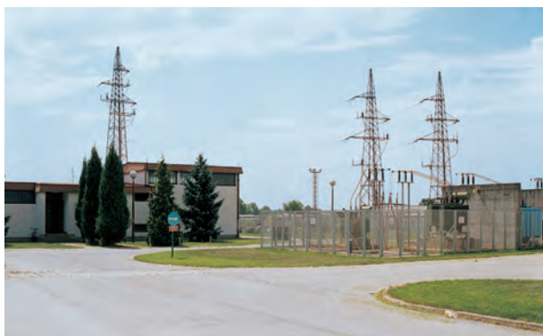
Trafostanica 35/6 kV za centralne plinske stanice u Molvama građena je 1980. i modernizirana 1985. godine
