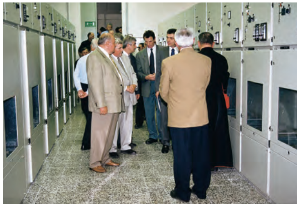
Unutrašnjost TS 110/35/10(20) kV Selnik kraj Ludbrega
