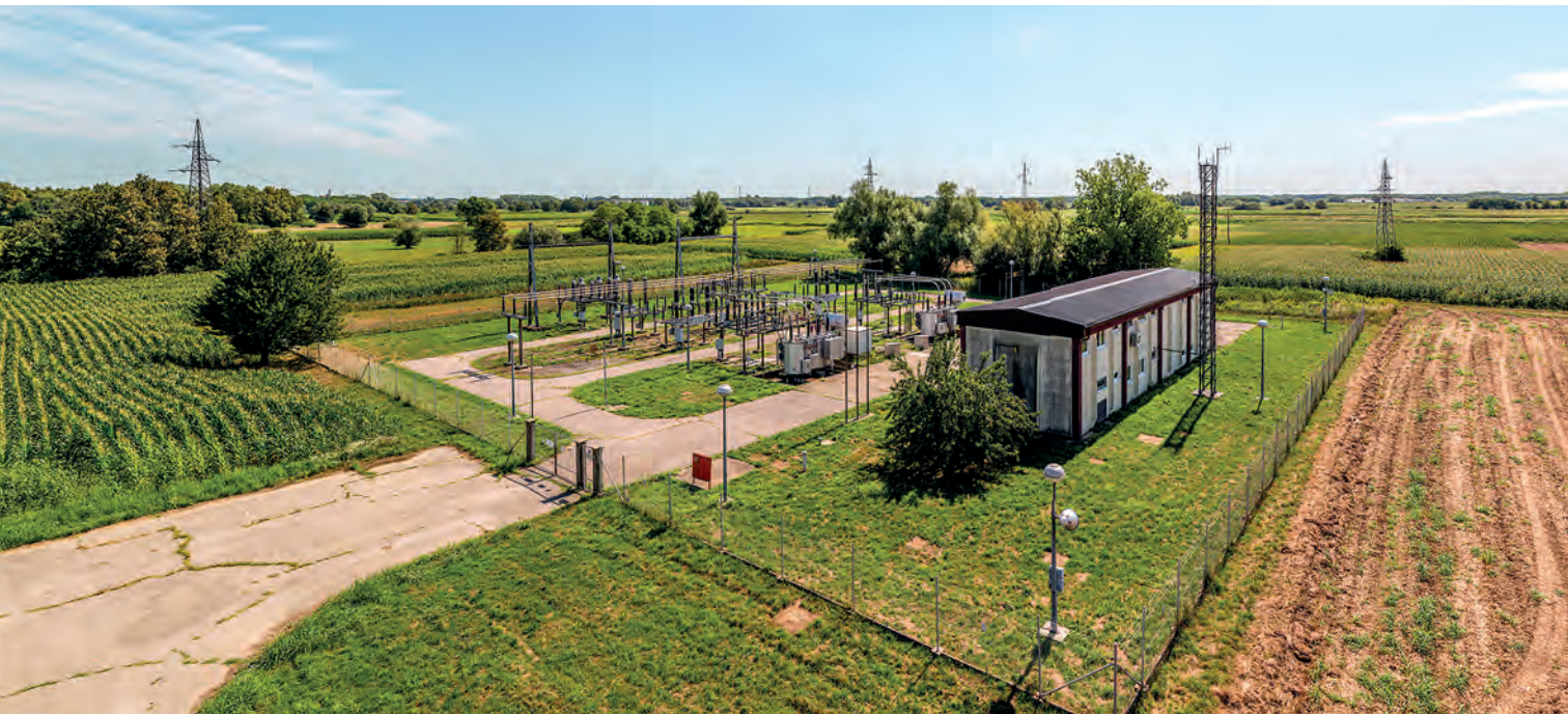
TS 110/35 kV Virje sagrađena je 1986. godine uglavnom za potrebe opskrbe strujom postrojenja za eksploataciju zemnoga plina
