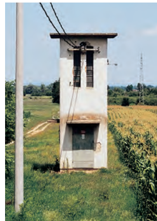
Trafostanica 10/0,4 kV između Cvetkovca i Rasinje
