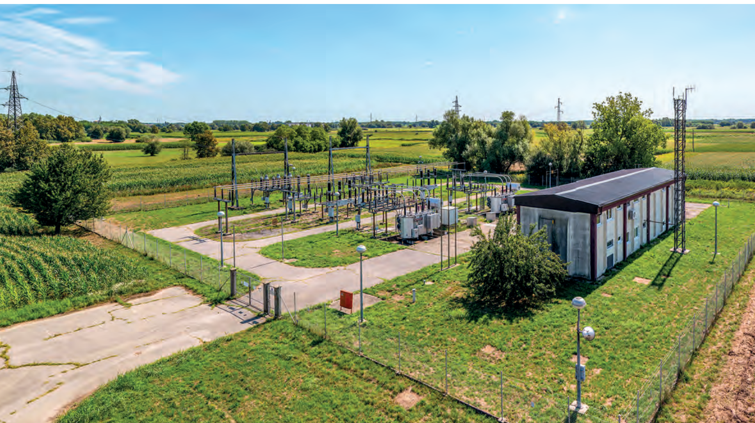
Trafostanica 110/35 kV Virje
