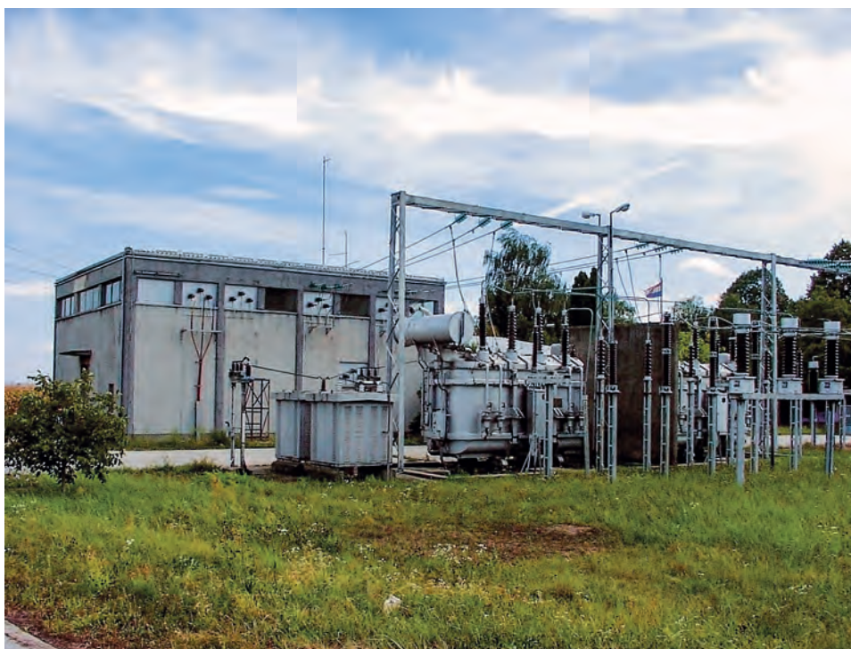
Pogled na 110/35 kV transformatorsku stanicu u Koprivnici koja je prvi put otvorena 1969. godine
