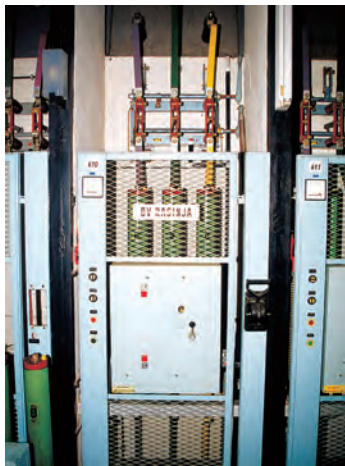
10 kV čelija u TS 35/10 kV
