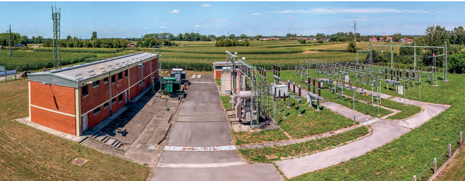
Suvremena transformatorska postrojenja u TS 110/35/10(20) kV Selnik
