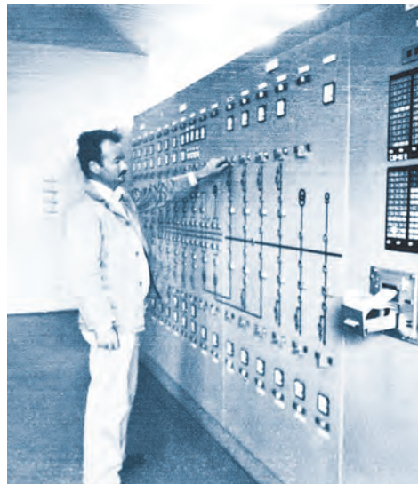
Komandna ploča u 110/35 kV trafostanici u Virovitici šezdesetih godina 20. stoljeća
