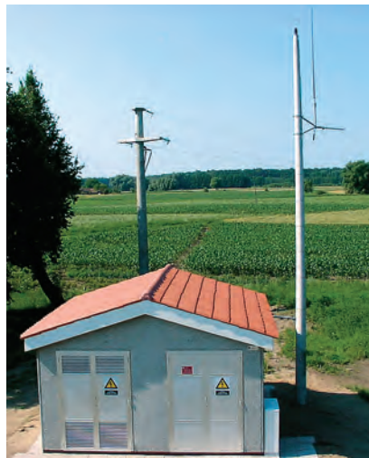
Pogled na rasklopište RS(TS) 10(20)/0,4 kV u Ferdinandovcu
