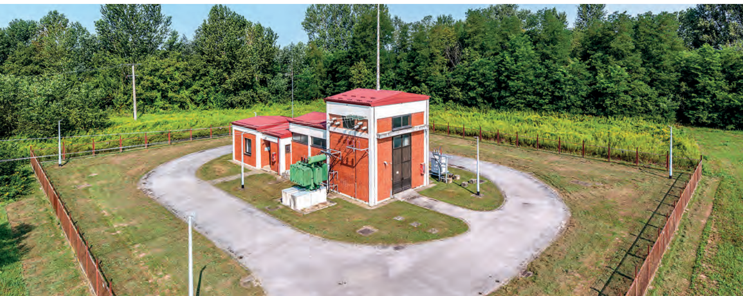
Pogled na obnovljenu 35/10 kV trafostanicu kod Legrada
