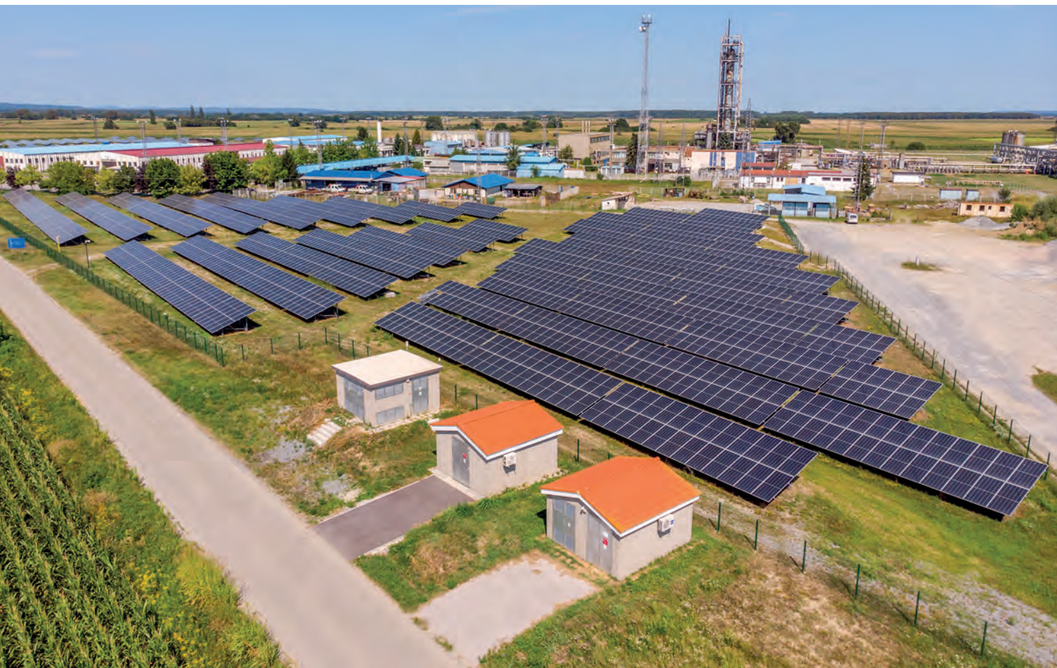
SE INA CPS i dva 35 kV susretna postrojenja
