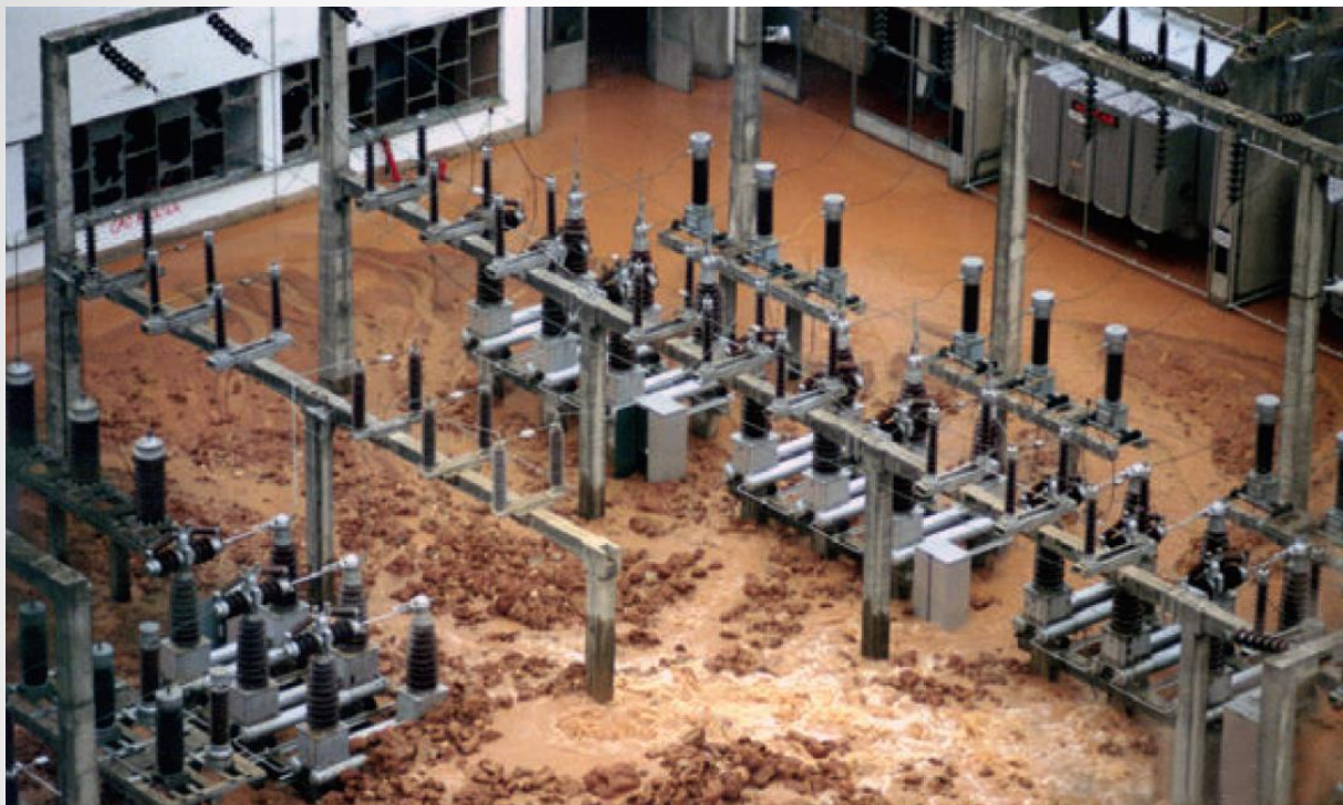
Poplavljeno postrojenje HE Peruća
