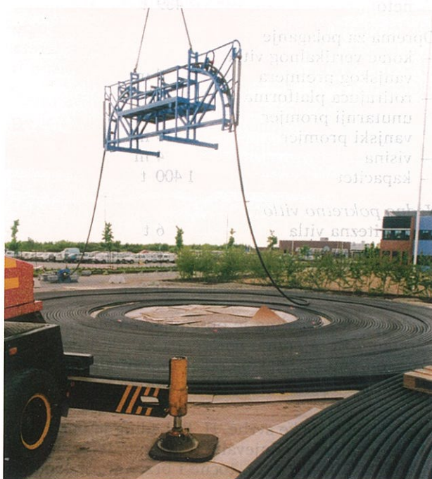
Slika 2. Kabel na platou tvornice
