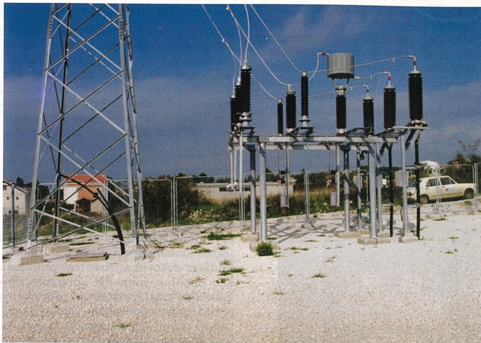
Slika 12. Kabela stanica Bili Brig
