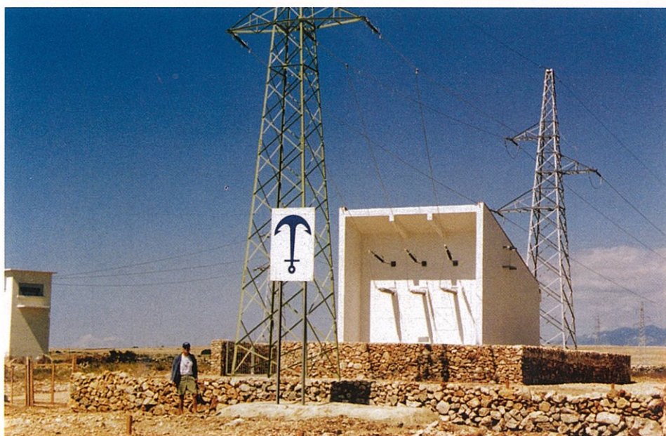
Slika 8. Kabeleska stanica za priključak podmorskog kabela 110 kV na zračni vod
