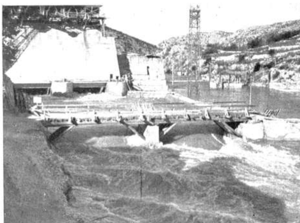
Poplava gradilišta u drugoj etapi
