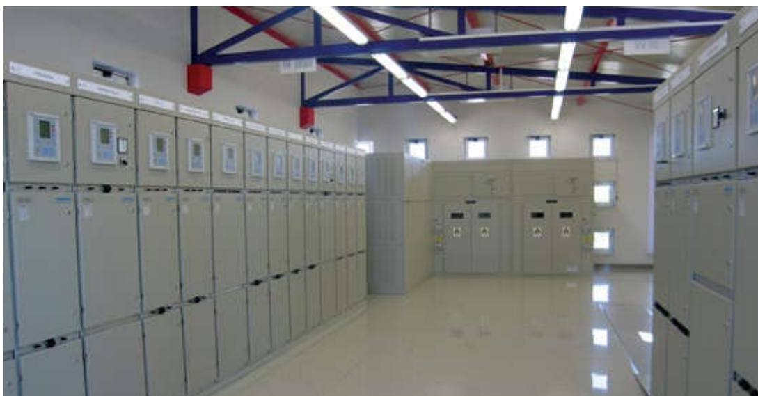
TS Istok Čakovec primjer je energetske infrastrukture koja je istovremeno i ukras prostoru
