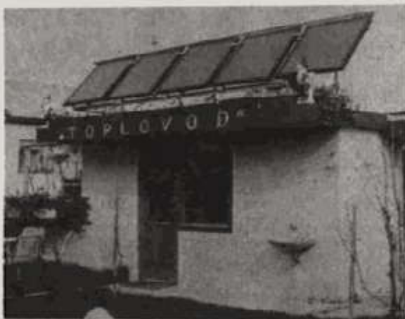
Sunčani kolektori na dvorišnoj prostoriji daju dovoljno topline za cijelu kuću za vrijeme sunčanih dana.
