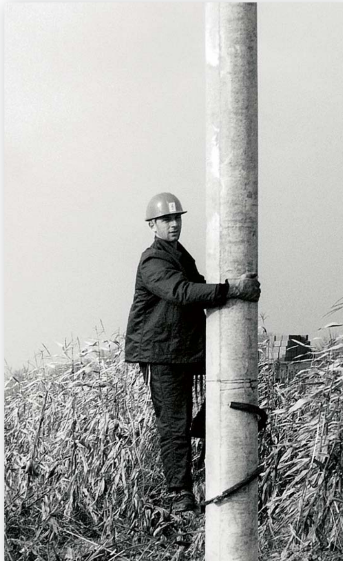
Primjenom armirano betonskih elemenata (nogara i stupova) trajnost nadzemnih mreža povećala se tri do četiri puta
