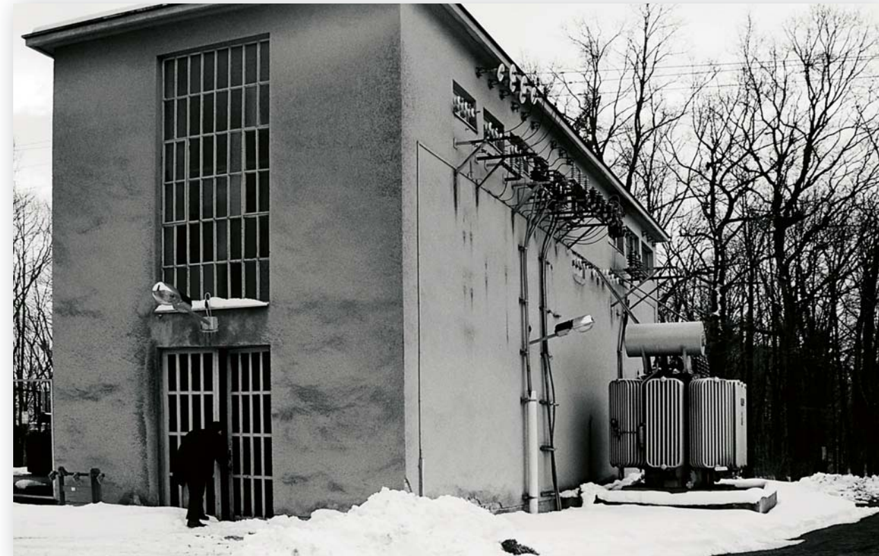
Transformatorska stanica 30 kV Novi Dvori u Zaprešiću
