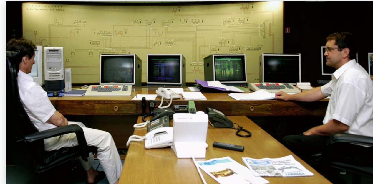
Središte distribucijskog sustava Elektro Zagreb – Dispečerski centar, iz kojeg se upravlja radom postrojenja
