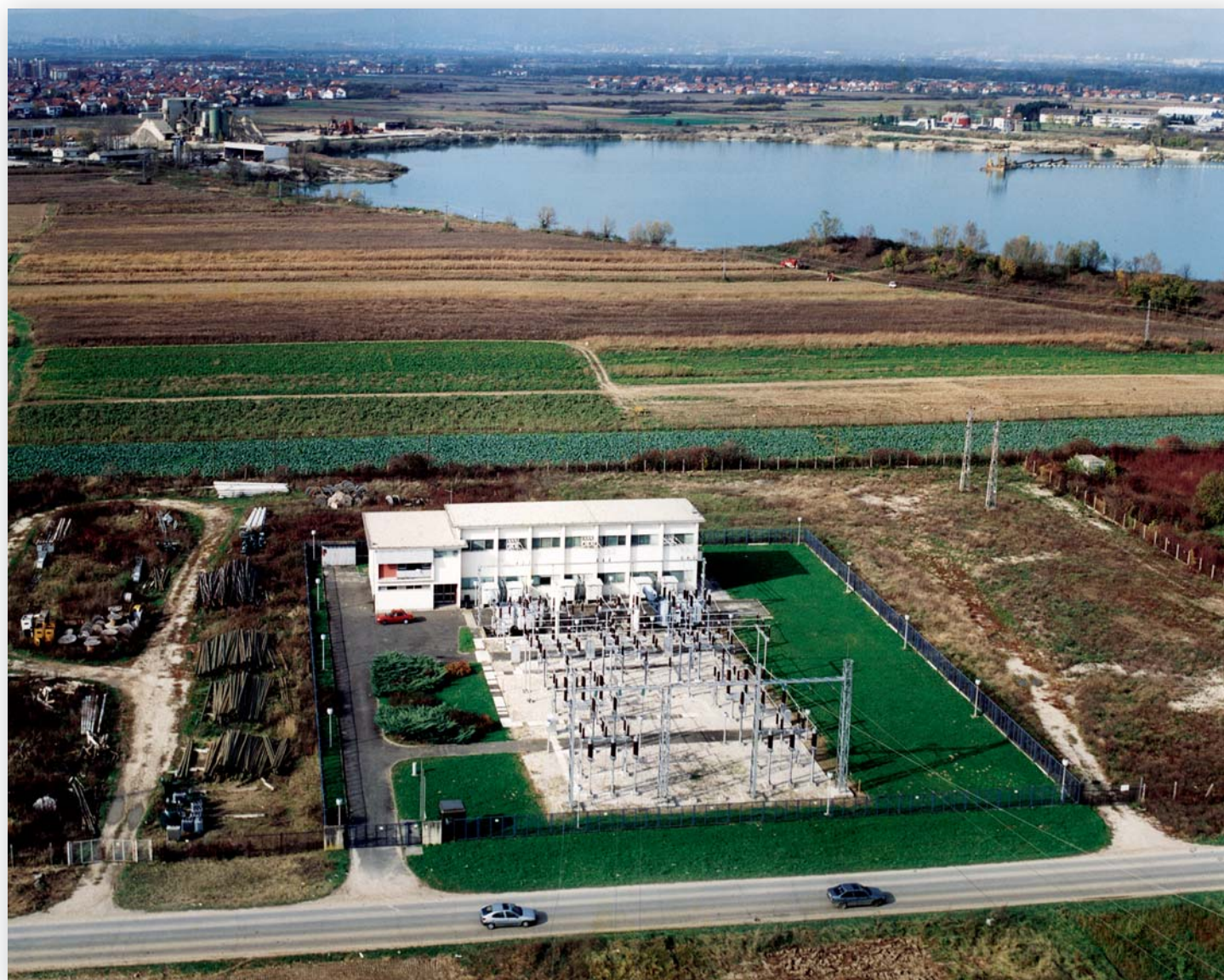
Transformatorska stanica 110/10(20)kV Velika Gorica
