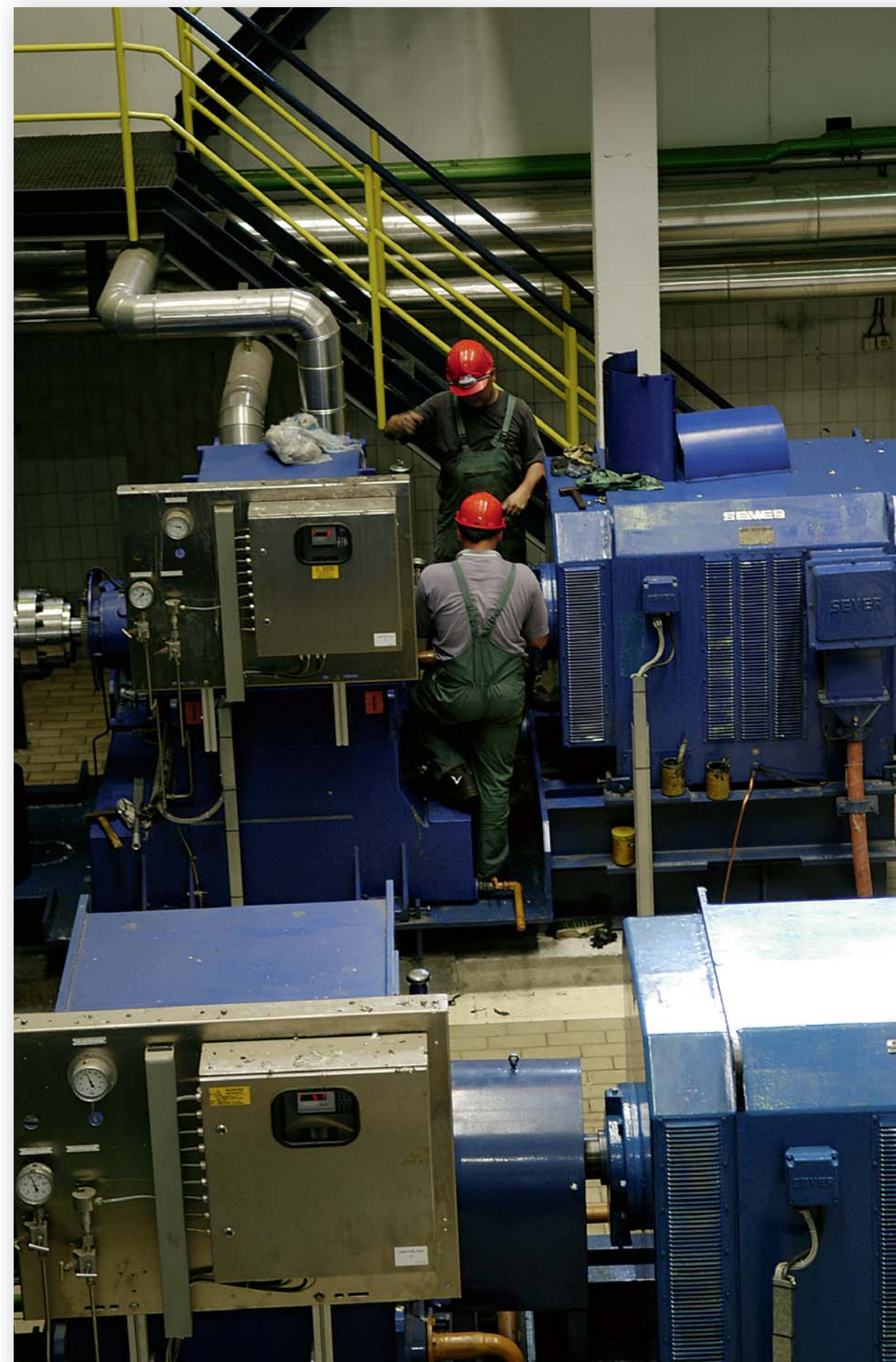
Cirkulacijske crpke toplinske stanice Elektrane - toplane
