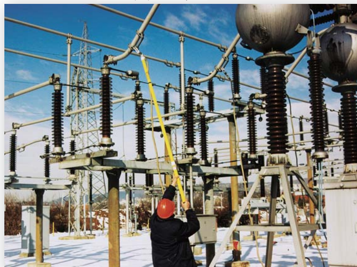
Trafostaničari u transformatorskoj stanici 110/10 (20) kV Stenjevec
