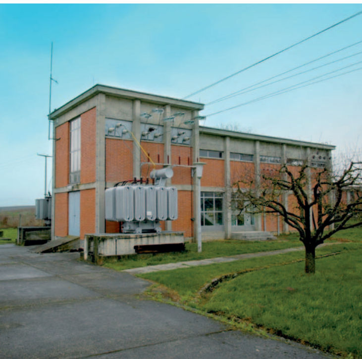
Trafostanica 35/10 kV Ferovac puštena je u pogon 1975. godine
