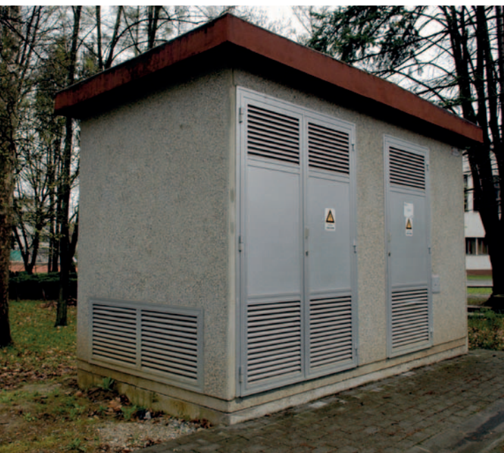
Kabelska trafostanica Požega 65
