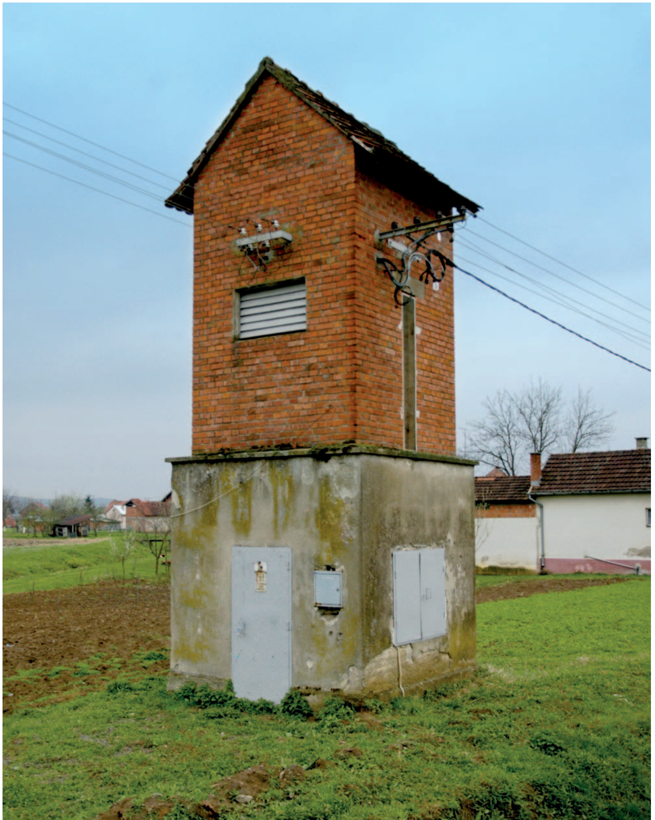
Trafostanica 10 0,4 kV Gradac 1
