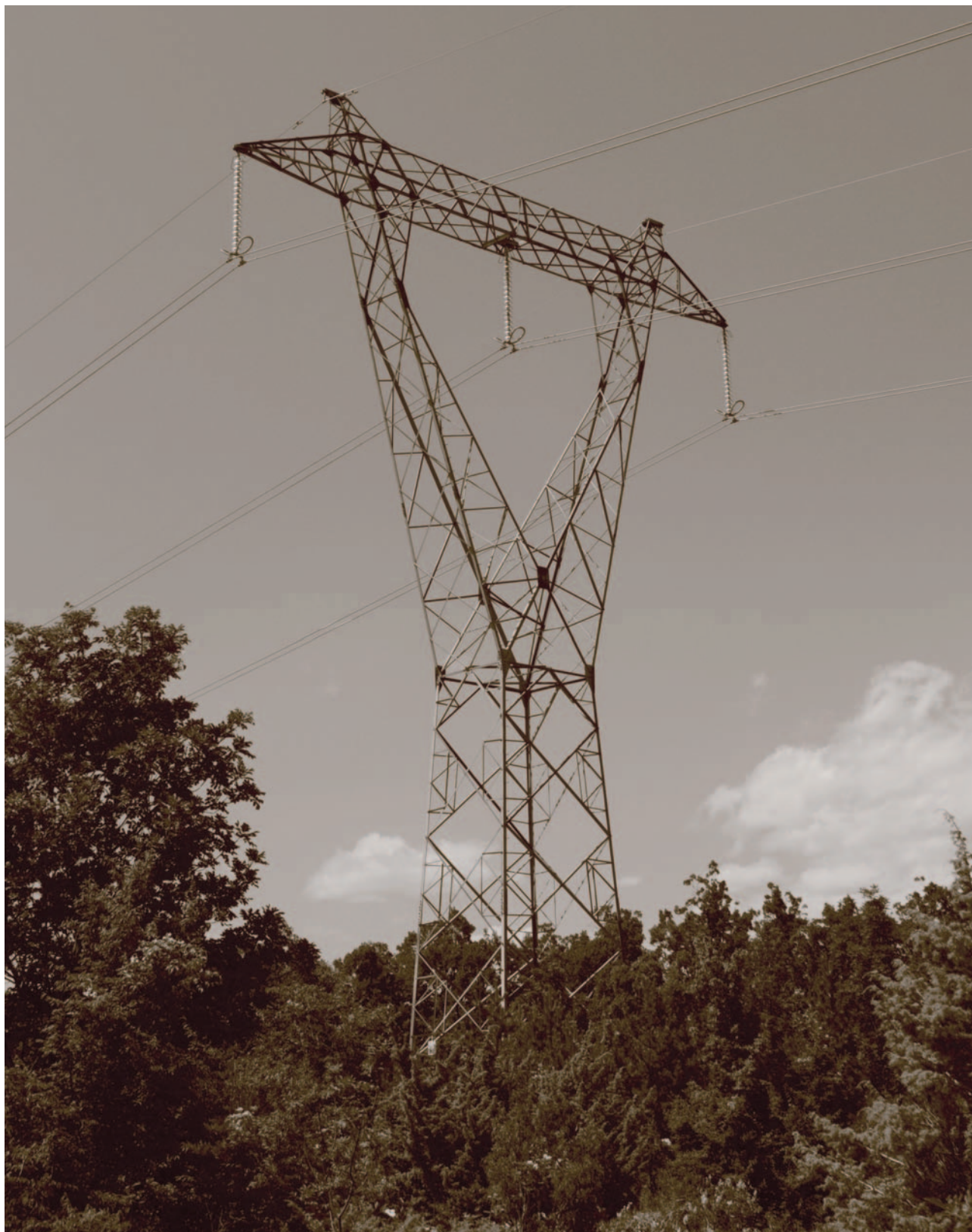
Čeličnorešetkasti stup dalekovoda 400 kV
