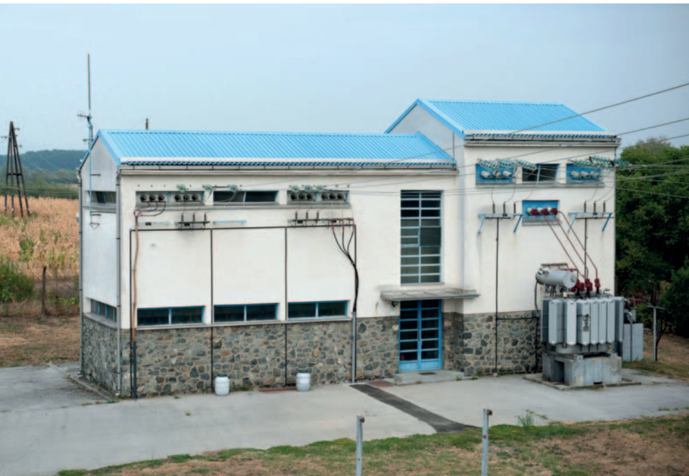
Trafostanica Požega I. u potpunosti je opremljena numeričkom zaštitom najnovije tehnologije
