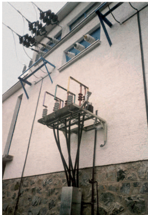
Trafostanica 35/10 (20) kV Požega I., izgrađena još 1956., rekonstruirana je i uključena u SDV
