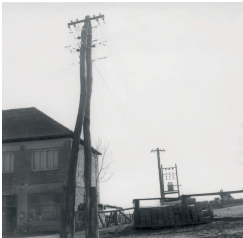
Jedna od 65 trafostanica na drvenim stupovima koju treba zamijeniti
