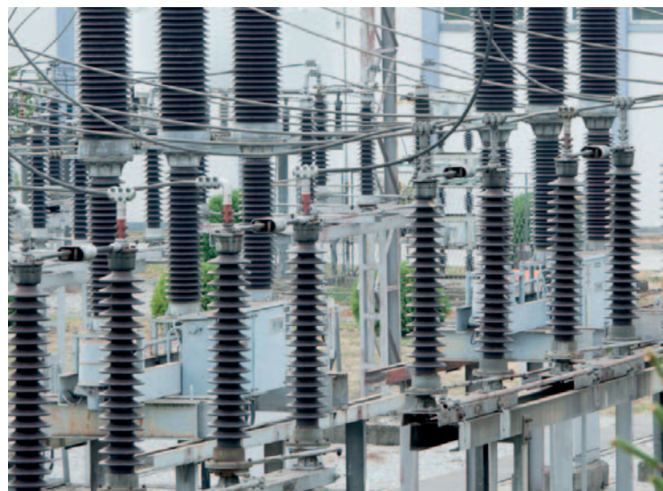
Trafostanica 110/35/10 kV Požega II. osuvremenjena je SF6 prekidačima
