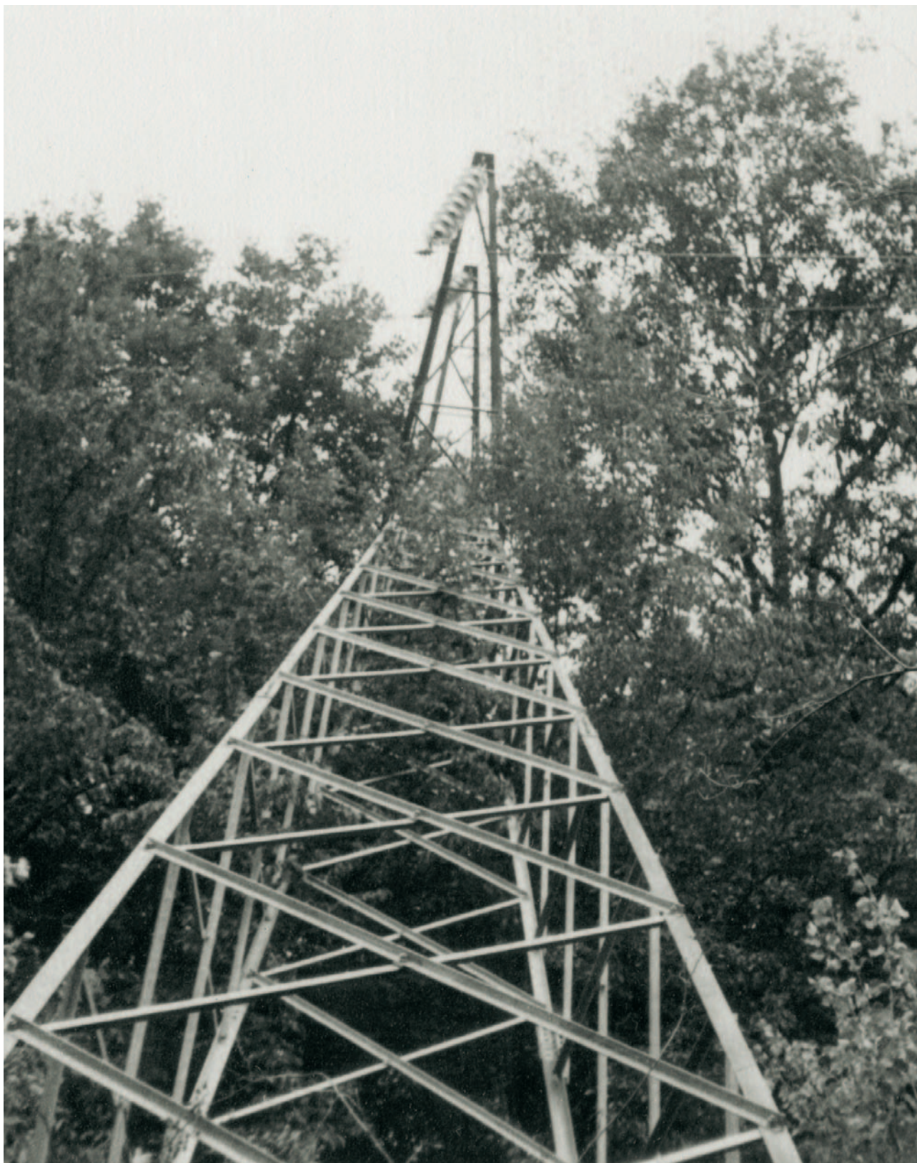
Srušeni stup dalekovoda 110 kV Požega-Nova Gradiška
