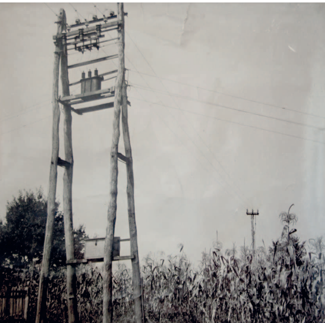
Trafostanica na drvenim stupovima
