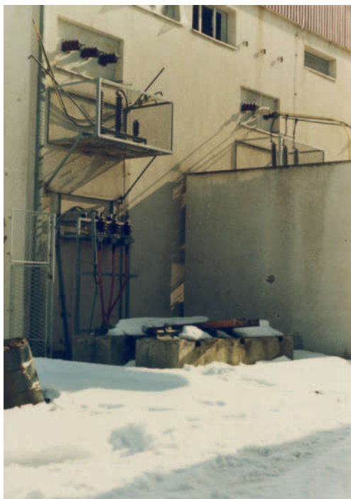
U žestokim napadima agresora na Gospić (17. rujna grad su napali i napalm-bombama) grad je razoren, ali ga četnici i tzv. JNA nisu uspjeli zaposjesti: u dvorištu upravne zgrade sjedišta Elektrolike oštećena je trafostanica.
