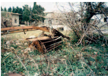
Ono što je ostalo od stupne trafostanice u selu Krković
