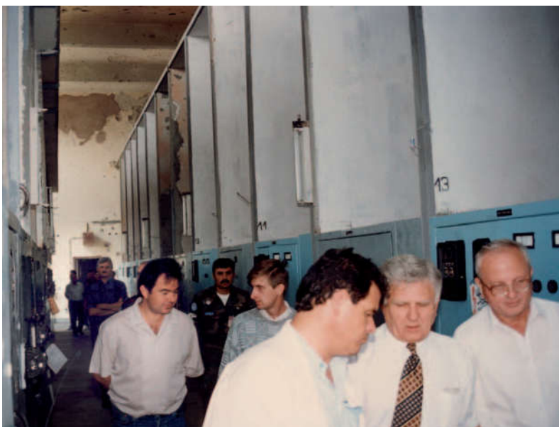
Timovi Hrvatske elektroprivrede, Elektrobaranje i Elektrokrajine pregledavaju transformatorske stanice i popisuju štete
