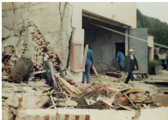
U eksploziji su potpuno razoreni zgrada zatvaračnice, servomotori s uređajem i pomoćni pogoni (dizelski agregat, aku-baterije...)
