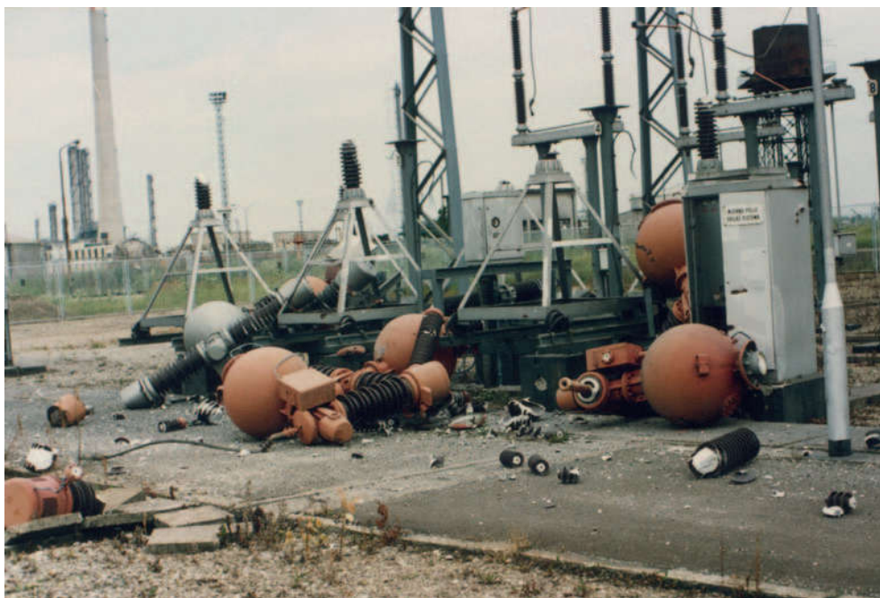
Sredinom studenog 1991. stradala su skoro sva postrojenja i zgrade Termoelektrane Sisak, a najviše rasklopno postrojenje
