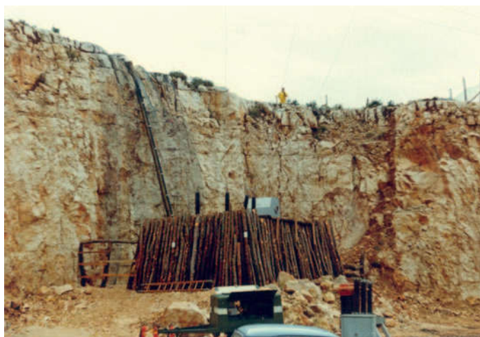
Privremena trafostanica 110/35 kV Kava, izgrađena u tajnosti i skrivena u kamenolomu
