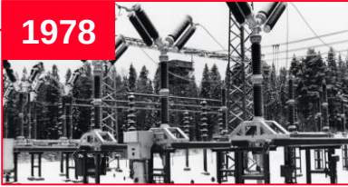
SF6 circuit-breaker 420 kV
