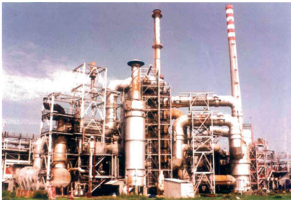
Sl. 3.: Detalj postrojenja Amonijak-2
