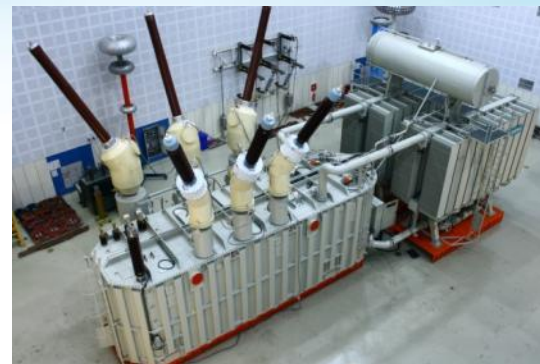
Prijenosni autotransformator 505 MVA 400/132 kV, UAE
