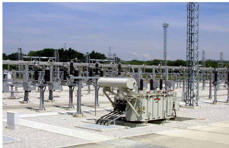
TS ŽERJAVINEC 400/220/110 kV
