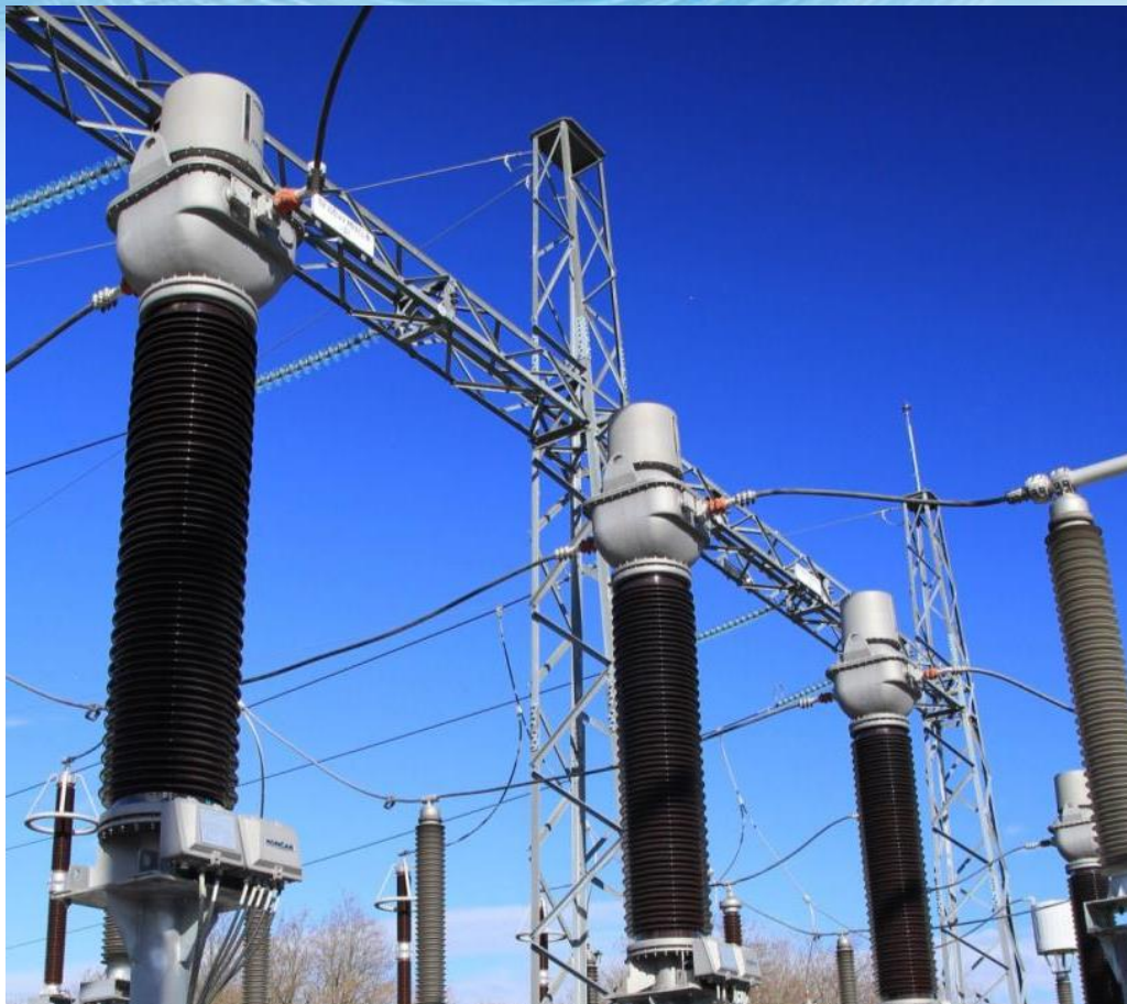
245 kV kombinirani mjerni transformator tip VAU-245
