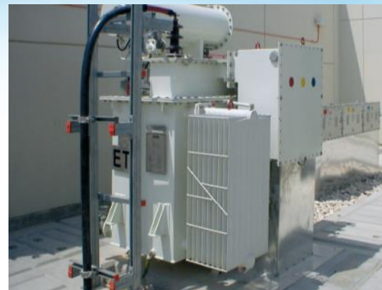
Transformator za uzemljenje 315 kVA, Katar
