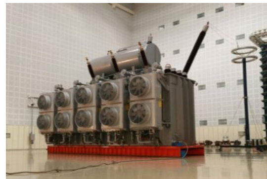
Trofazni autotransformator 350 MVA, Češka
