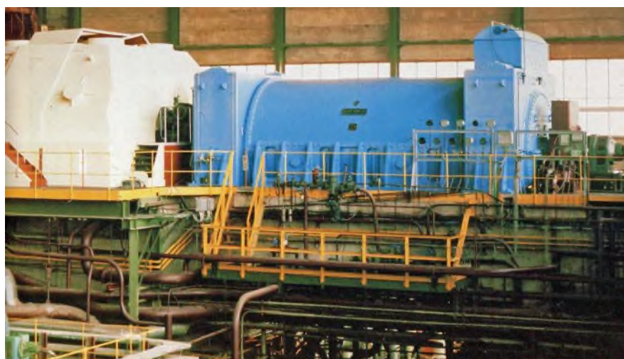
TE Ugljevik I s turbogeneratorom 353 MVA, 20 kV u Bosni i Hercegovini, puštena u rad 1985.
