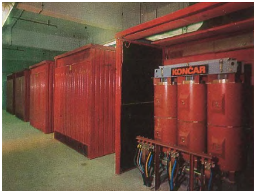
Epoksidni energetske transformatori u postrojenju visoke pogonske sigurnosti, 1984.
