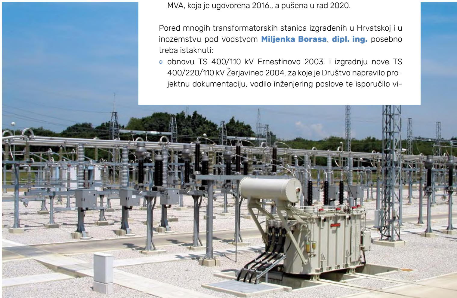
Transformatorska stanica 400/220/110 kV Žerjavinec, 2004.
