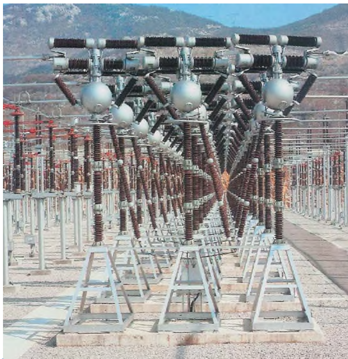
Rasklopno postrojenje 420 kV u transformatorskoj stanici 400/220/110 kV Melina izgrađena 1981.
