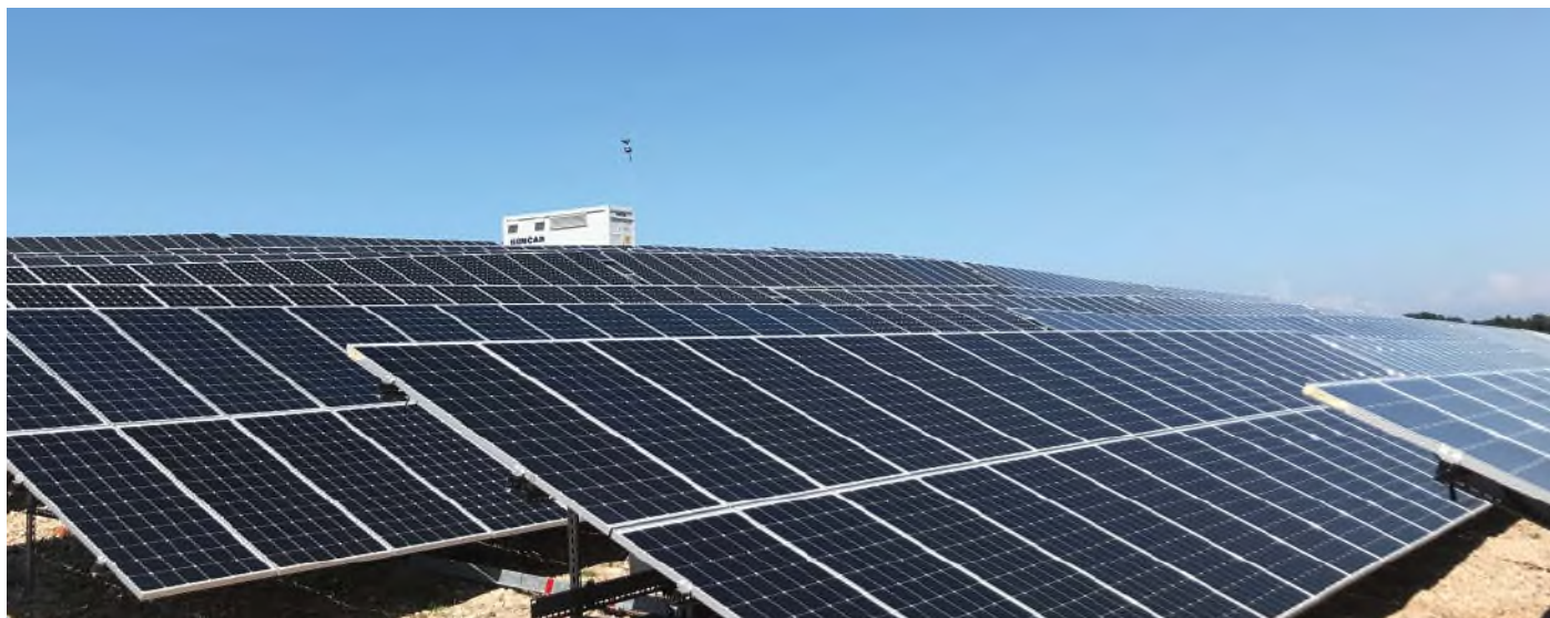
Sunčana elektrana na otoku Visu snage 3,5 MW, puštena u rad 2020.
