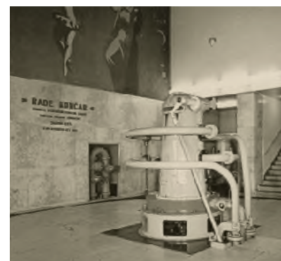
Strojarnica HE Mariborski otok s prvim proizvedenim generatorom 24 MVA u Tvornici RADE KONČAR i puštenog u pogon 1948.
