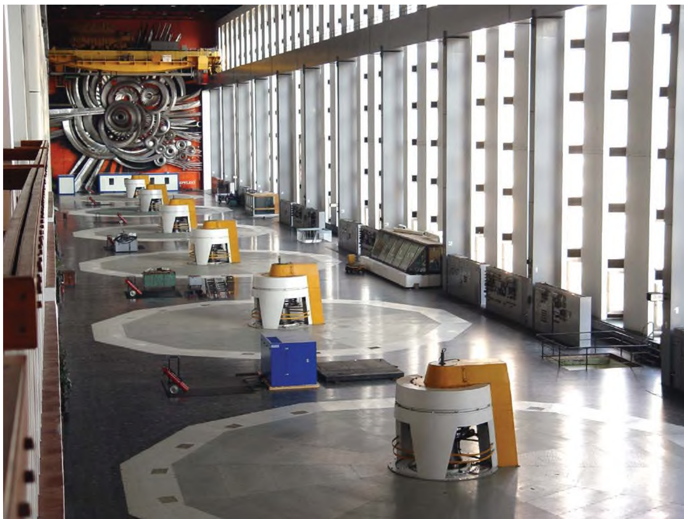
Strojarnica HE Đerdap puštena u pogon 1972. s generatorima snage po 190 MVA
