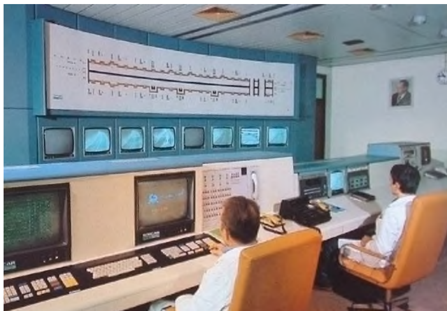
Sustav daljinskog upravljanja tunelom Učka , 1981.
