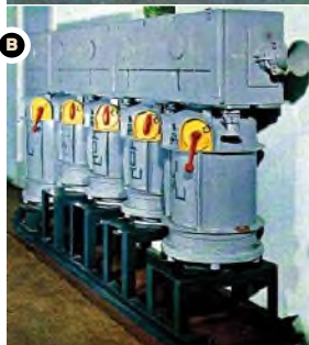
Visokonaponska rudnička sklopna jedinica s ugrađenim malouljnim prekidačem (A) i niskonaponska protueksplozijski zaštićena baterija za razvod energije i sklapanje (B)
