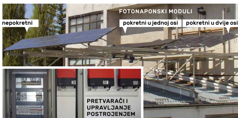
Eksperimentalna fotonaponska elektrana s nepokretnim modulom, pokretnim modulom u jednoj osi i pokretnim modulom u dvije osi ukupne instalirane snage 10 kW
