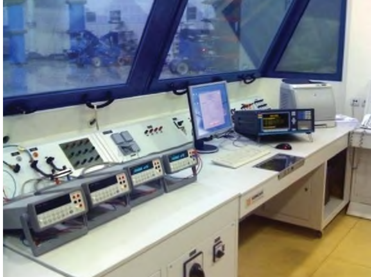
Automatizirano ispitivanje transformatora: povećan kapacitet ispitne stanice, ispitni izvještaji neposredno nakon ispitivanja, veća točnost i pouzdanost mjernih rezultata te smanjeni troškovi ispitivanja, 2008.
