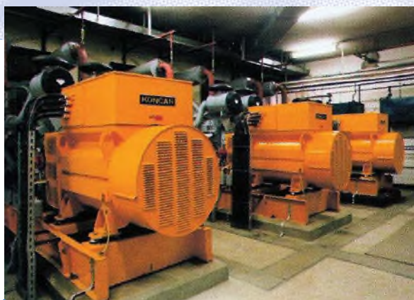
Agregatsko postrojenje sa sinkronim generatorima s mogućnošću istodobnog rada u Kliničkoj bolnici u Osijeku
