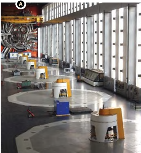
HE Đerdap s 2 puta po 3 generatora snage 190 MVA, 71,5 1/min u Srbiji, puštena u rad 1972. (A) i sastavljanje generatora u HE Haditha 6 x 128 MVA, 15,75 kV, 100 1/min u Iraku, puštena u rad 1987. (B)
