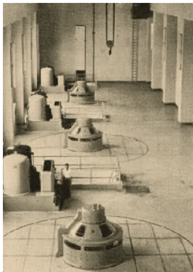
Strojarnica s tri generatora snage 5500 kVA u HE Chichoki Mallian u Pakistanu, prvi energetska objekt u inozemstvu s KONČAREVOM elektroopremom, koji je 1959. izgradila jugoslavenska industrija putem poslovnog udruženja INGRA, osnovanog 1953.
