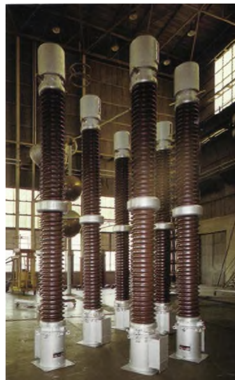
Mjerni transformatori 400 kV, 1980.
