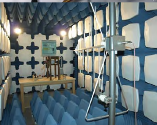
Mala i velika komora s apsorberima za ispitivanje elektromagnetske kompatibilnosti, instalirane 2010. i 2015.
