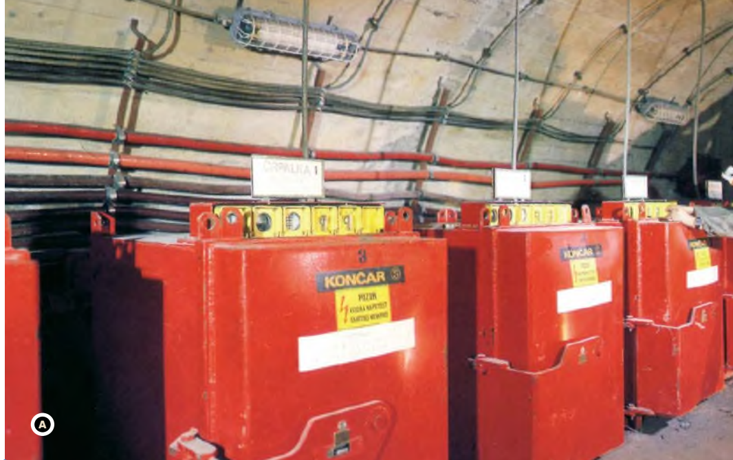
Visokonaponski (A) i niskonaponski protueksplozijski zaštićeni blokovi (B) iz 1980-ih
