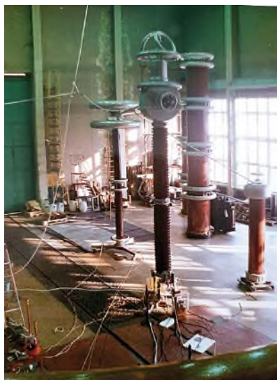
Istraživanje na mjernim transformatorima u Visokonaponskom laboratoriju, 2005.
