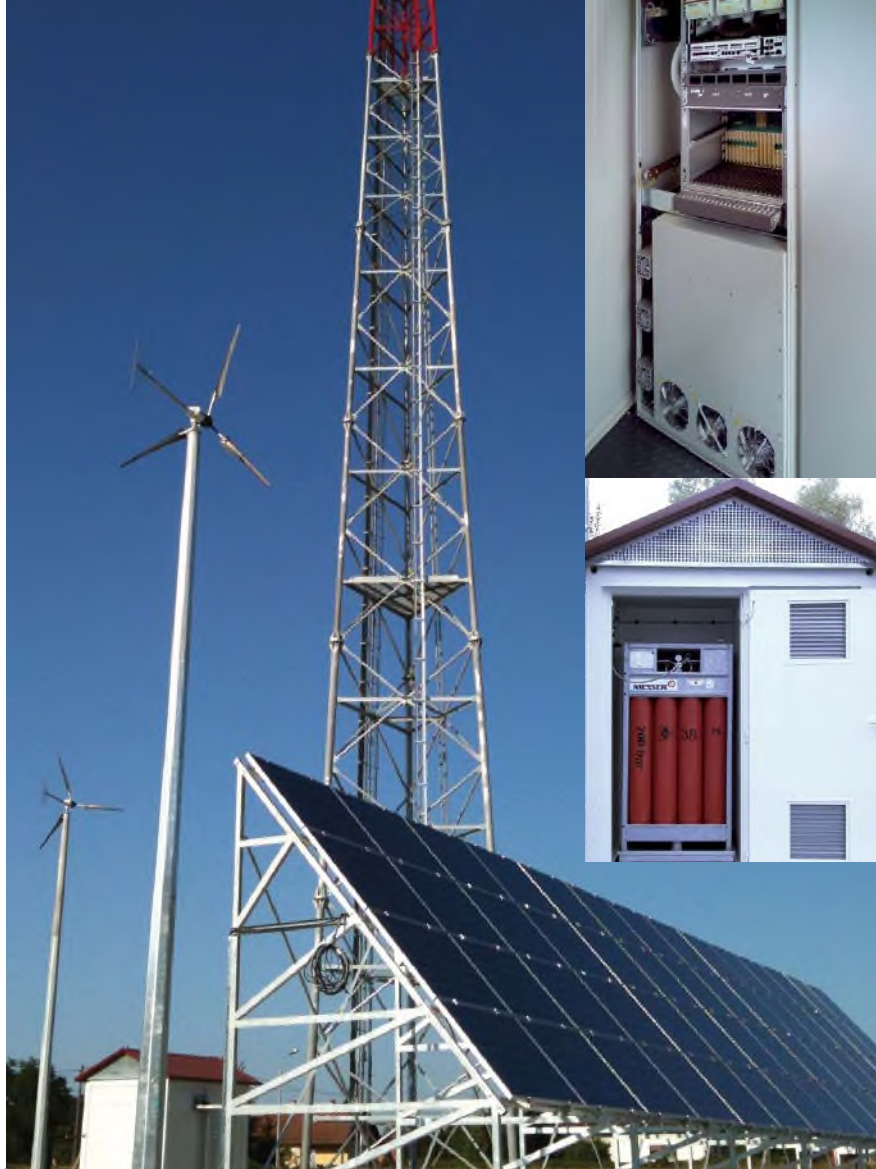
Autonomni izvor napajanja iz obnovljivih izvora i primjena vodikove tehnologije (Hybrid Box®) za baznu stanicu u Ladimircima, 2011.
