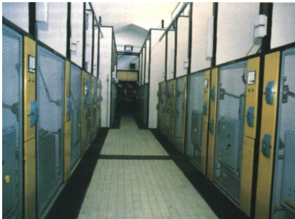
TS35/10 kV Poreč 2, unutrašnjost
