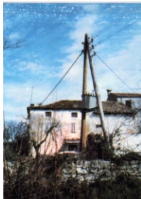
Sl. 5 Smještaj transformatora 0,95/0,4 kV na drvenom A-stupu
