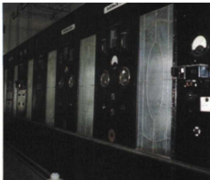
Slika 24. Komandna ploča trafostanice Karojba prije rekonstrukcije.
