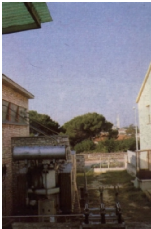
TS 35/10 kV Rovinj
