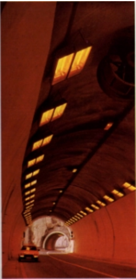
Javna rasvjeta u tunelu "Učka"
