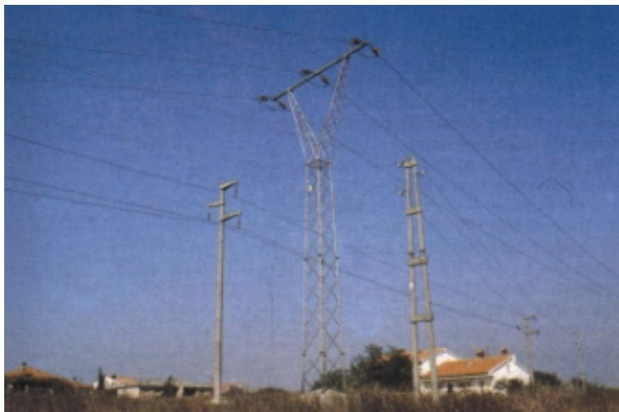
Slika 34. DV 40kV Raša-Pula. 10kV na betonskim stupovima "SCAC".
