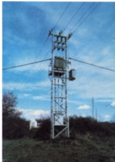
Sl. 4 Smještaj transformatora 0,38/0,95 kV na čeličnom rešetkastom stupu TS 10 (20)/0,4 kV
