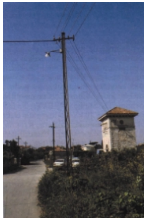
Slika 35. Niskonaponska mreža na rešetkastim stupovima "BATES".
