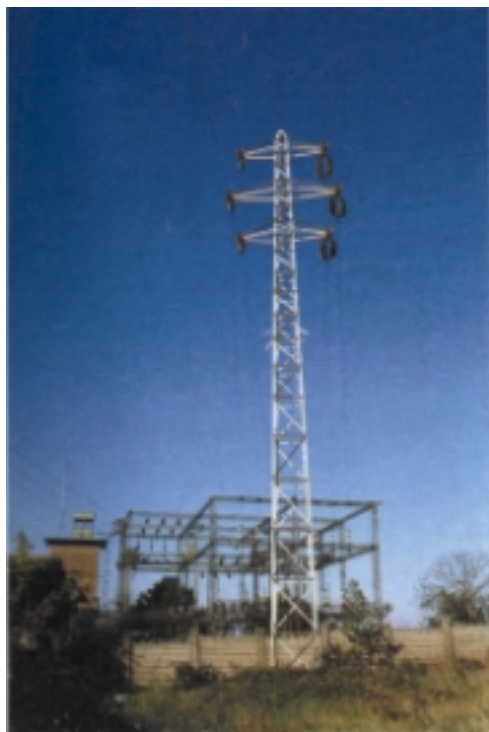
Slika 22. Dalekovod i trafostanica Savičenta 1990. g.
