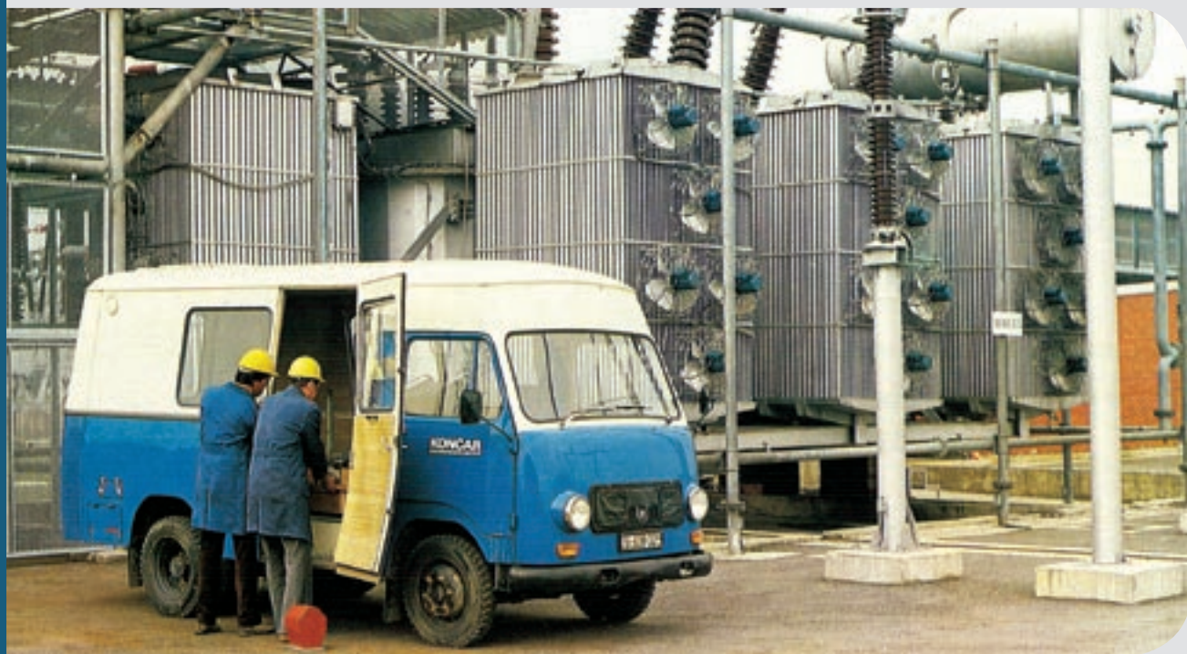
S.4.34. Pokretna ispitna stanica za dijagnostiku transformatora iz sedamdesetih
