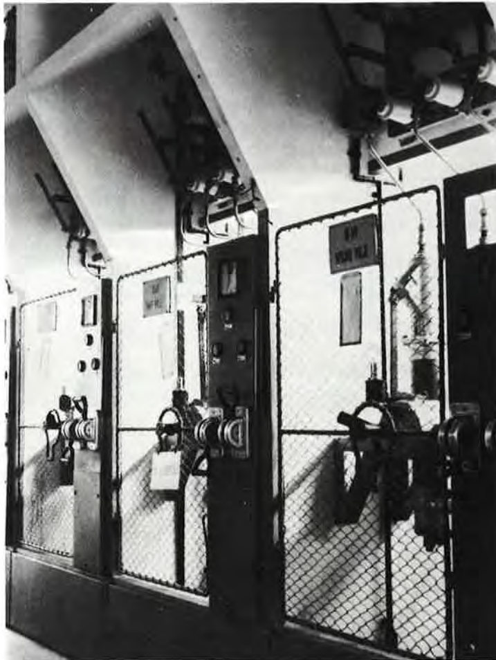
Detalj unutrašnjosti TS 35/10 kV
