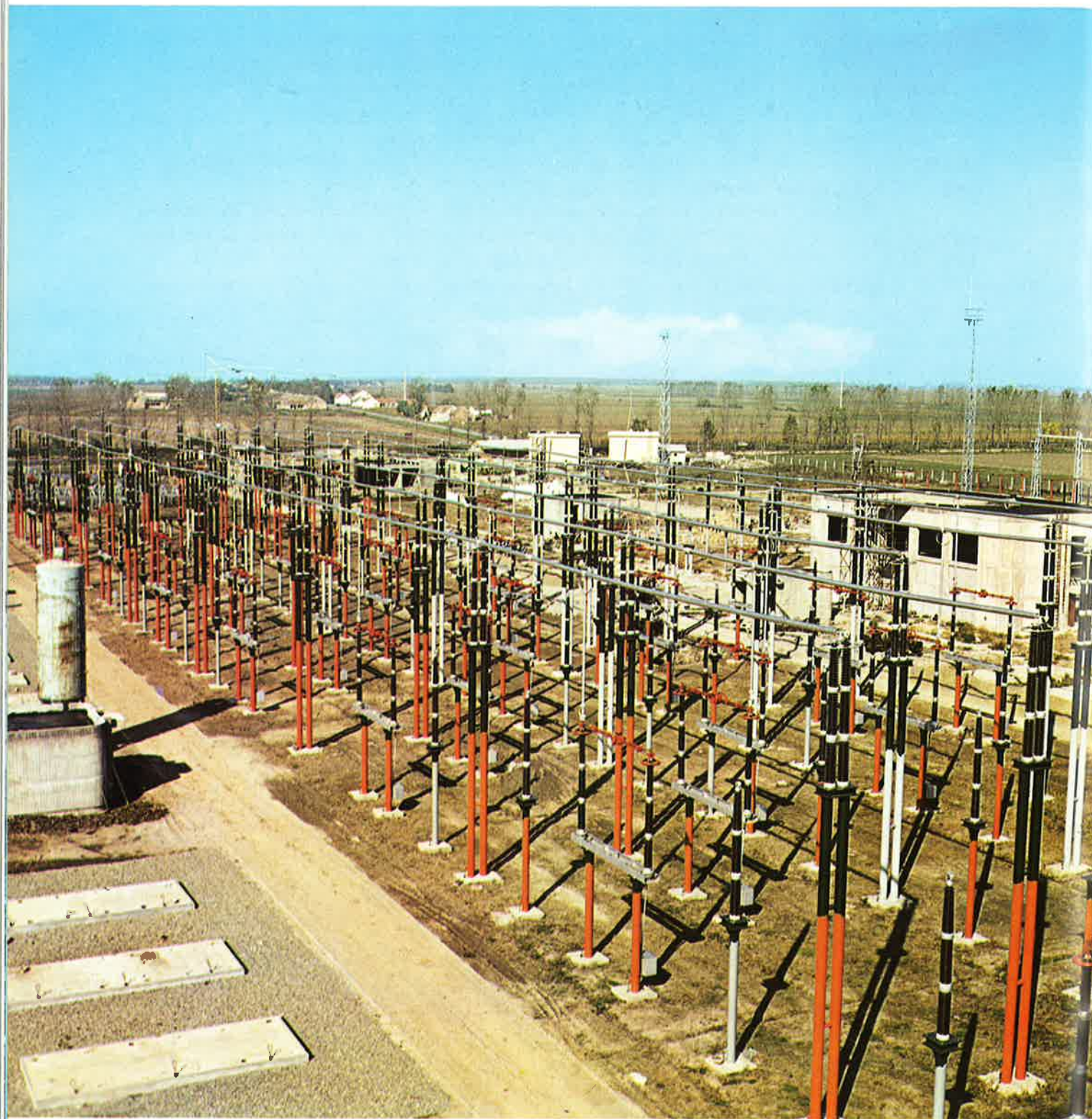
Rasklopno postrojenje TS 380/110 kV Ernestinovo
