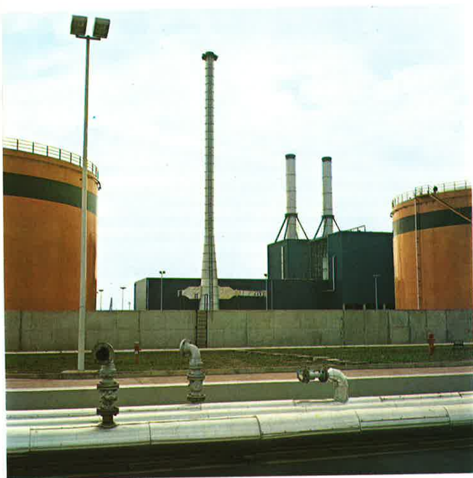
Spremnici za tekuća goriva, zgrada kotlovnice i PTE
