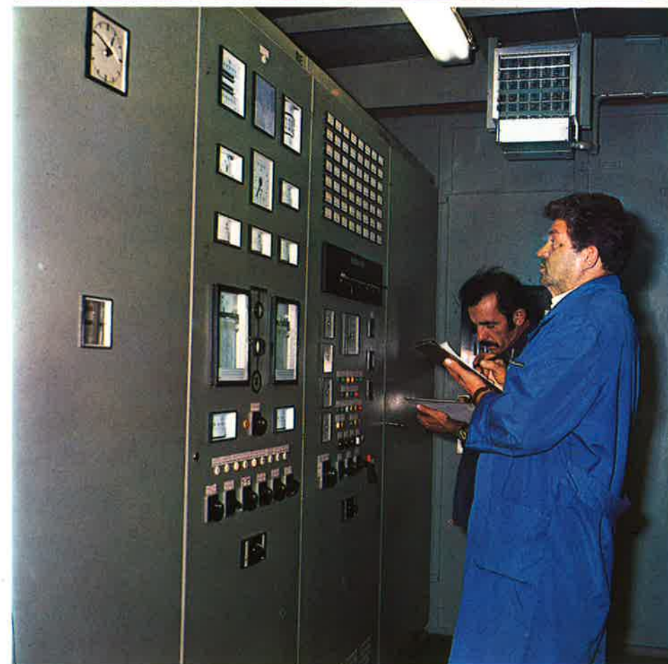
Kontrola stanja na mjernim instrumentima PTE Osijek
