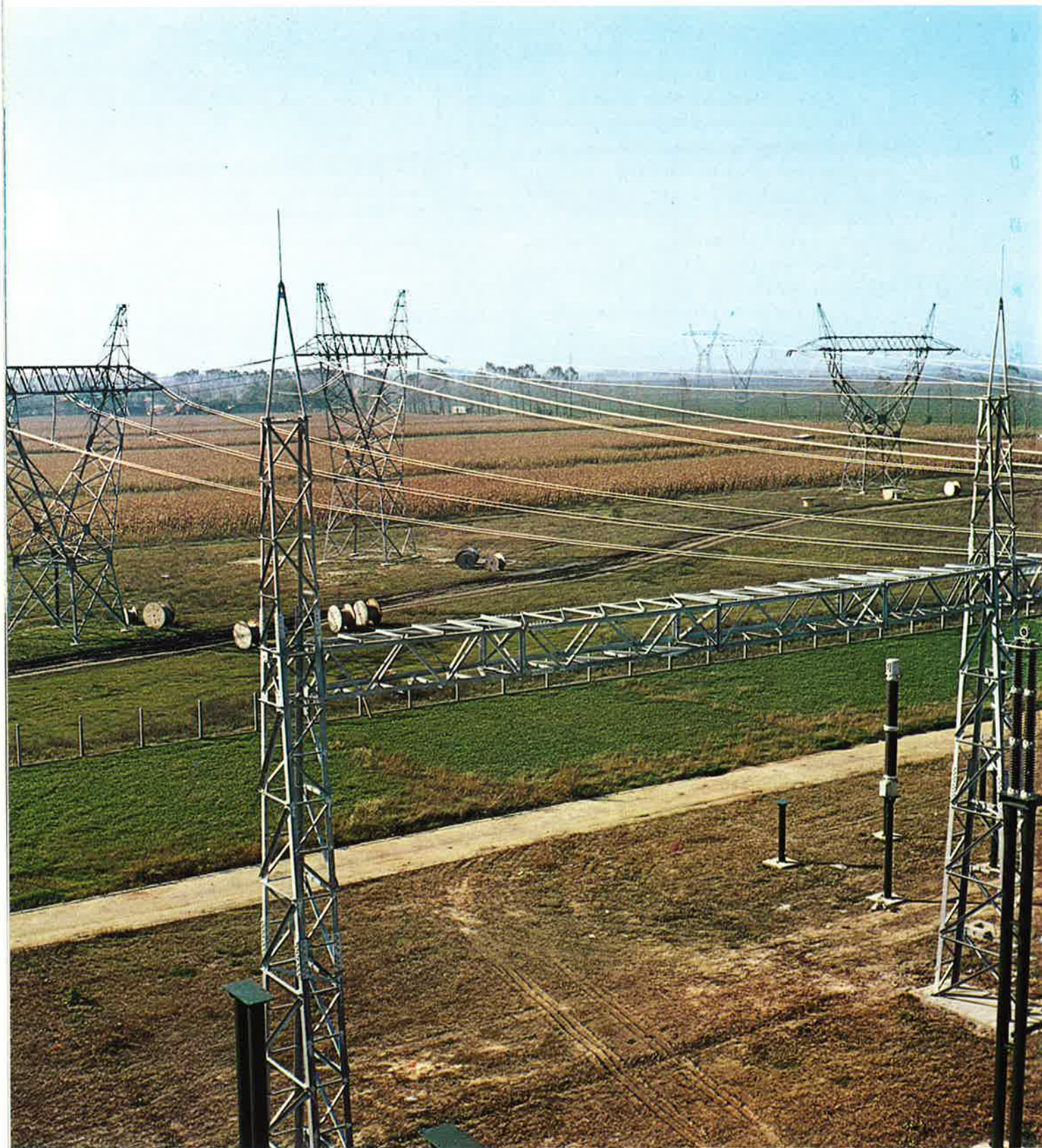
Rasplet dalekovoda 380 kV kod TS Ernestinovo
