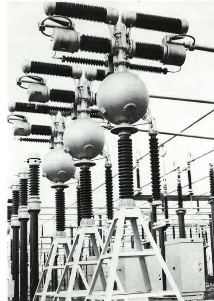
Detalj rasklopnog postrojenja u TS 110/35/10 kV
