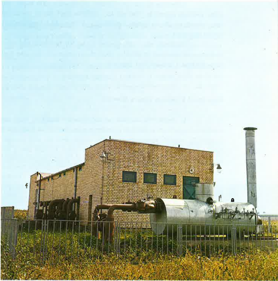
Prva plinsko-redukciona stanica izgrađena u Osijeku
