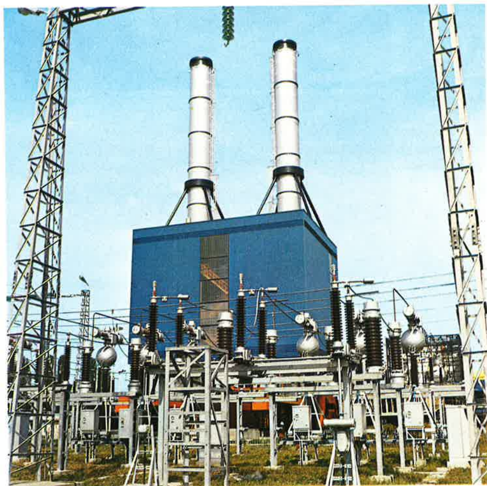
Plinsko-turbinska elektrana i rasklopno postrojenje 110 kV
