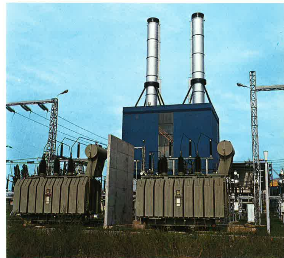
Pogled na PTE Osijek i transformatore
