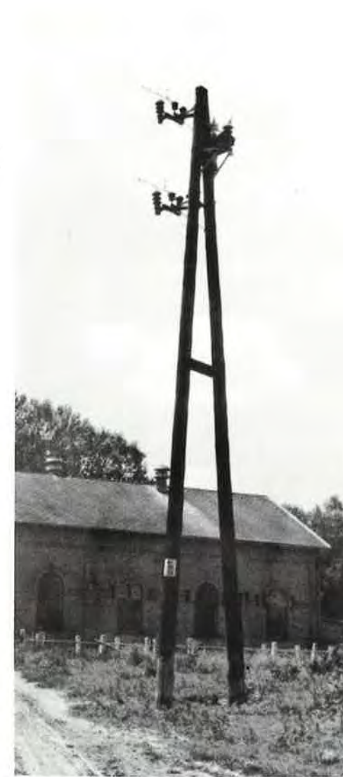
Nekadašnja mreža 10 kV na drvenim stupovima
