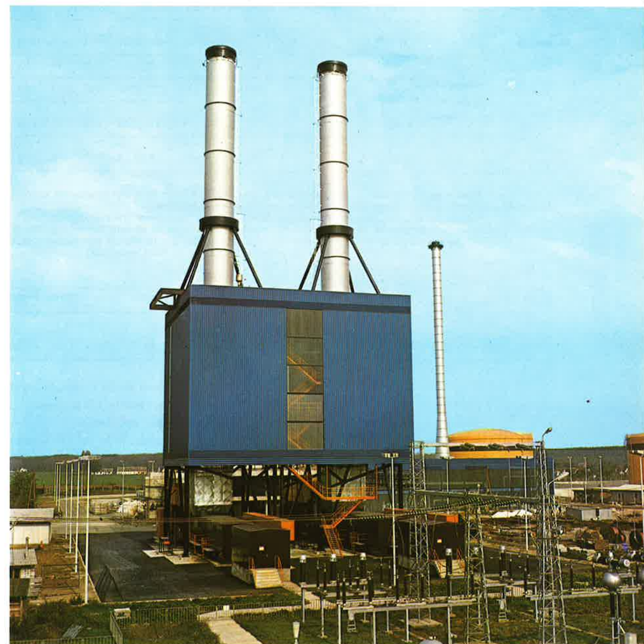
Pogled na postrojenje Plinsko-turbinske elektrane u Osijeku
