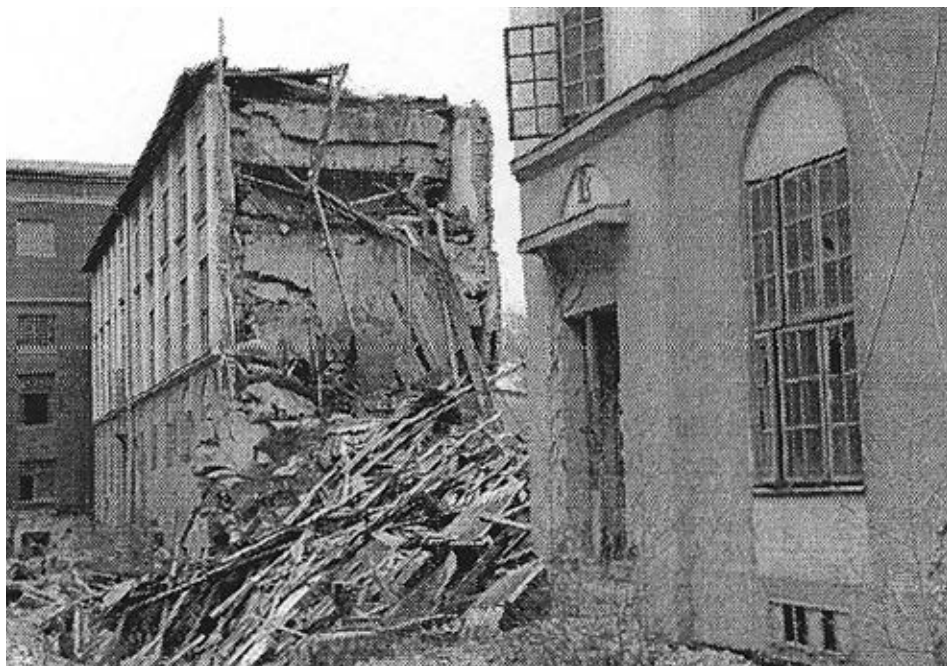
Slika 5.: Urušeni središnji dio dvorišne zgrade (duge oko 50 m i široke manje od 5 m) nekadašnje tvornice Penkala-Moster d. d. Crvena zgrada na koju se naslanja urušena zgrada ima pročelje na Branimirovu ulicu (slika 4.). To se dogodilo 1. listopada 2007., tijekom kopanja jame za podzemnu garažu Poslovnog centra Krešimir . (izvor: internet)
