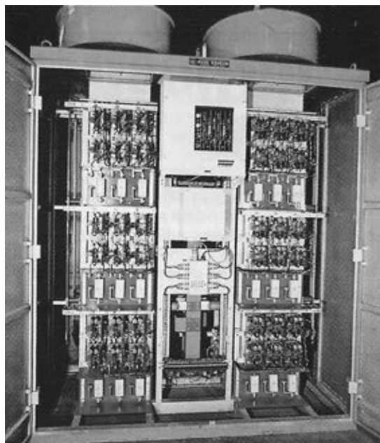
Slika 5.: Tiristorski usmjerivač za napajanje uzbude sinkronog generatora 190 MVA u HE Đerdap. Sastoji se od šest trofaznih usmjerivačkih mostova spojenih u paralelu.
