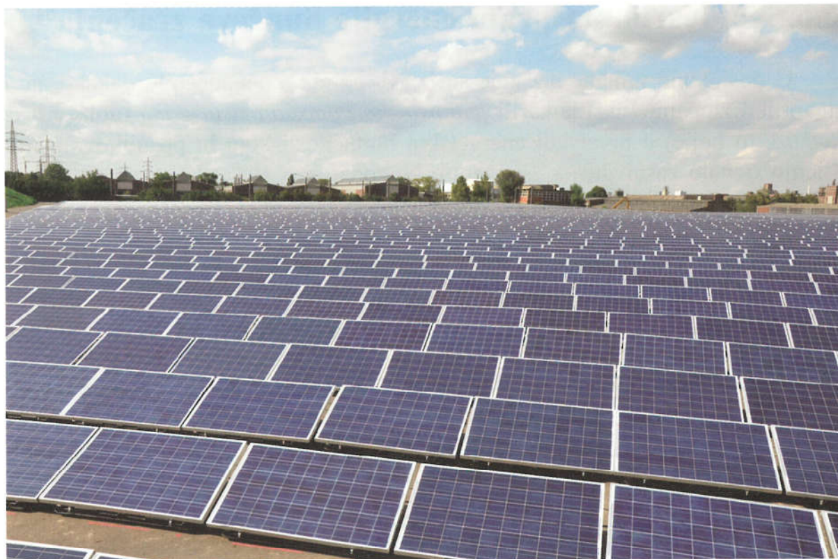
Fotonaponsko postrojenje u Ludwigshafenu na 41 000 m 2 vršne snage 2,2 MW
