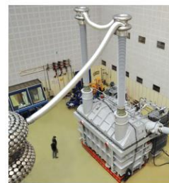
Slika 13.18. 90,8 MVA (za visokonaponsku istosmjernu mrežu) 332/√3 kV, Ukupna masa 155 t – Proizvodnja: KONČAR KPT – Zagreb
