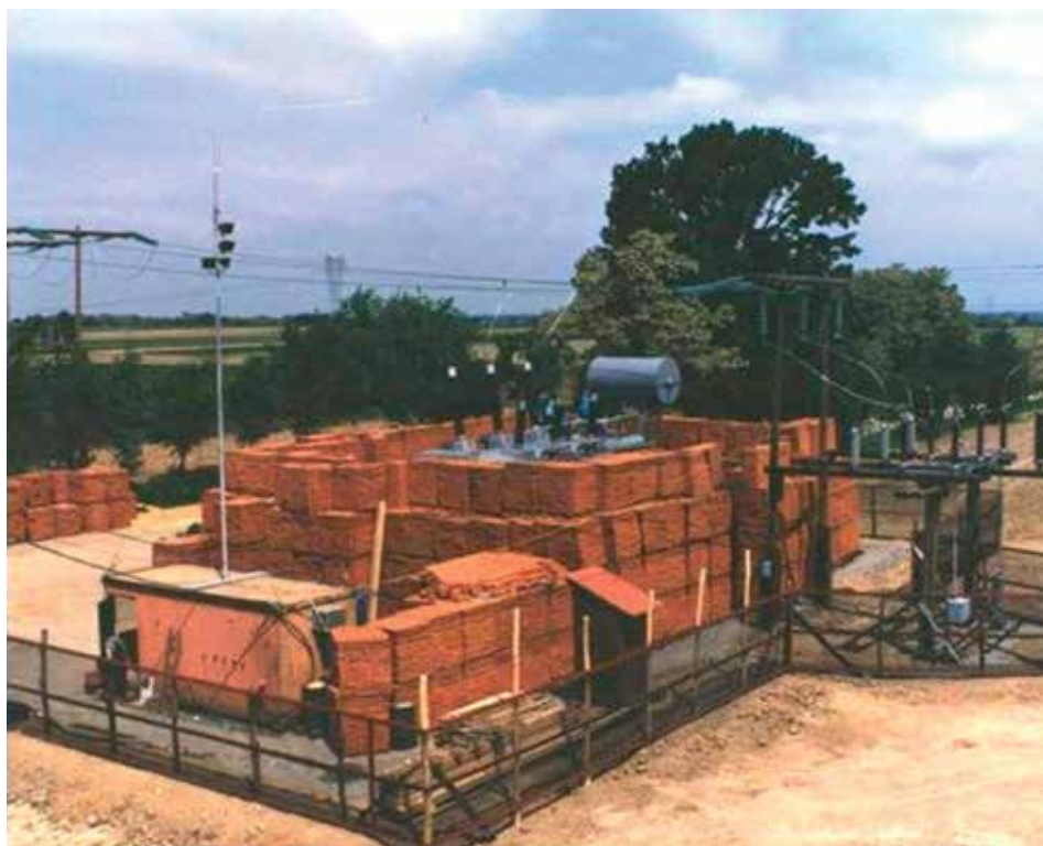
Slika 9.: TS 220/110 kV “1505/2”, 150 MVA
