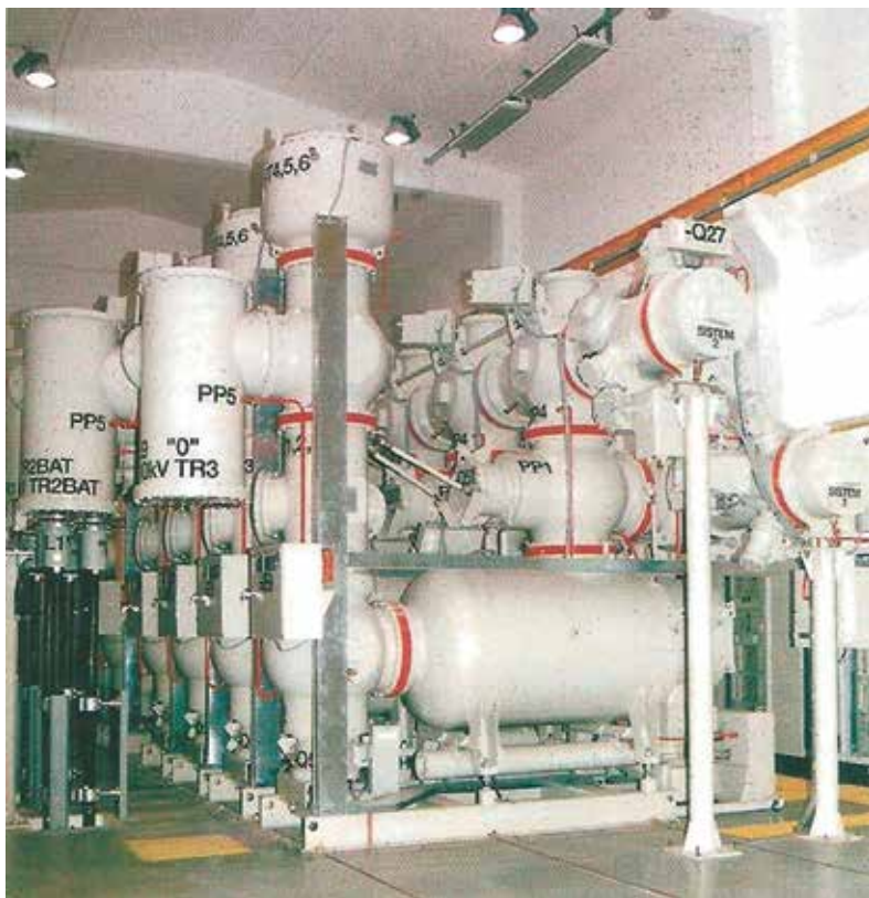
Slika 13.: Visokonaponsko SF 6 rasklopno postrojenje, 1999. (Končar)
