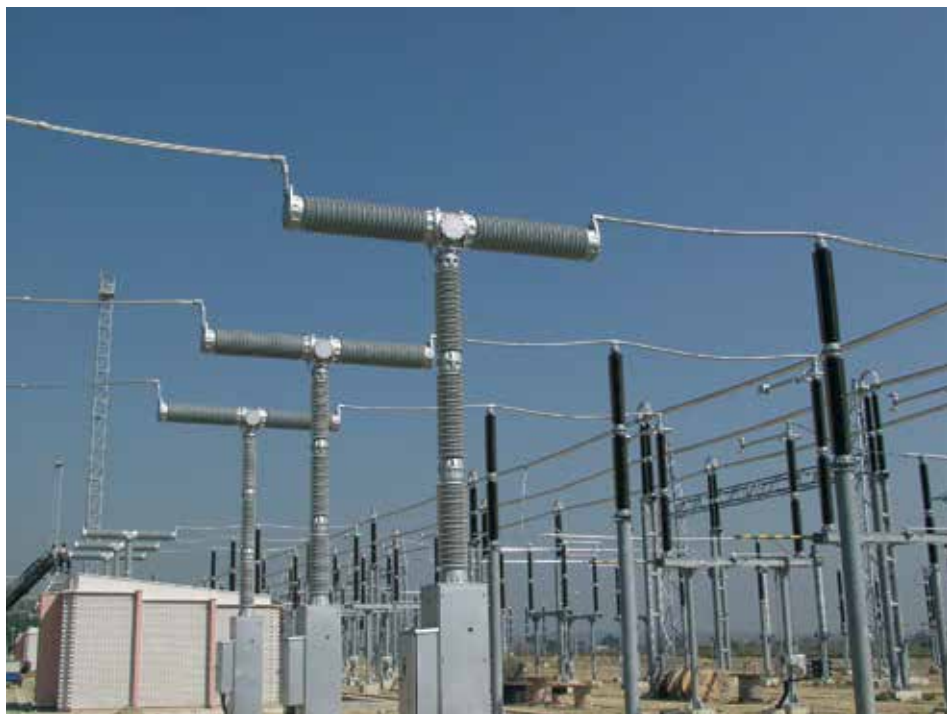
Slika 10.: Visokonaponska transformatorska stanica TS 420/220/110 kV Žerjavinec, Hrvatska (nakon obnove 2004.)
