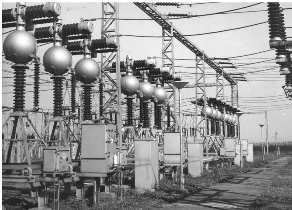
Slika 6.: TS 220/110 kV Đakovo
