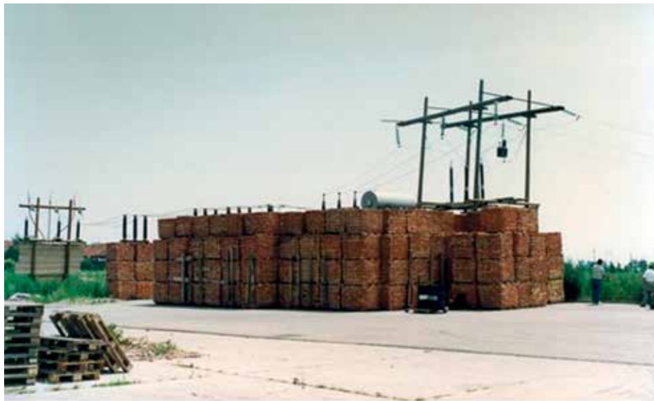
Slika 8.: TS 110/35 kV “505”, 22 MVA
