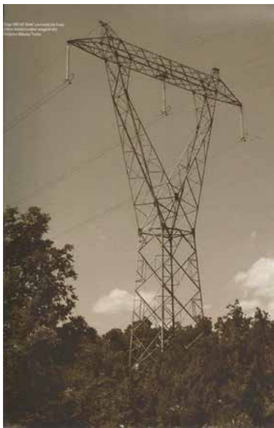
Slika 12.: Stup 400 od kV (kod Lovreća u Hrvatskoj) na trasi južne dalekovodne magistrale Prstena Nikola Tesla , u radu od 1981. (Dalekovod)
