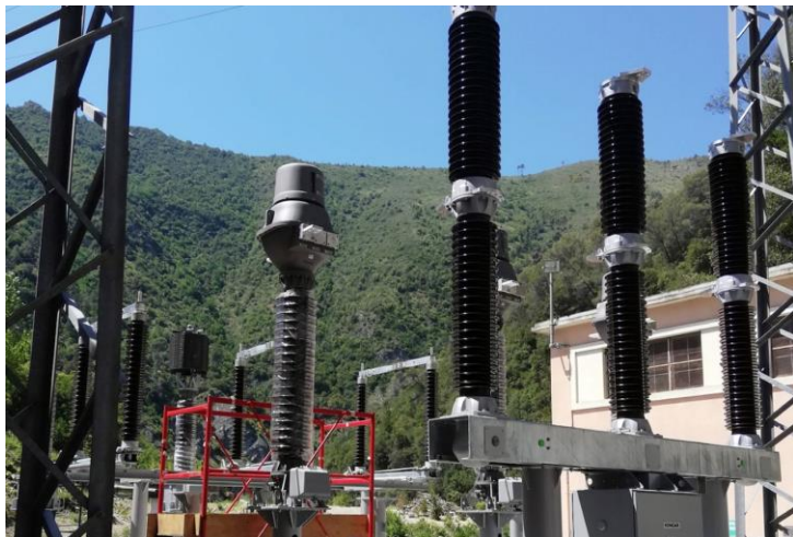
Visokonaponski prekidači i rastavljači 145 kV Italija
