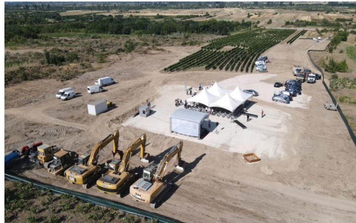
TS 400/110 kV Ohrid Sjeverna Makedonija
