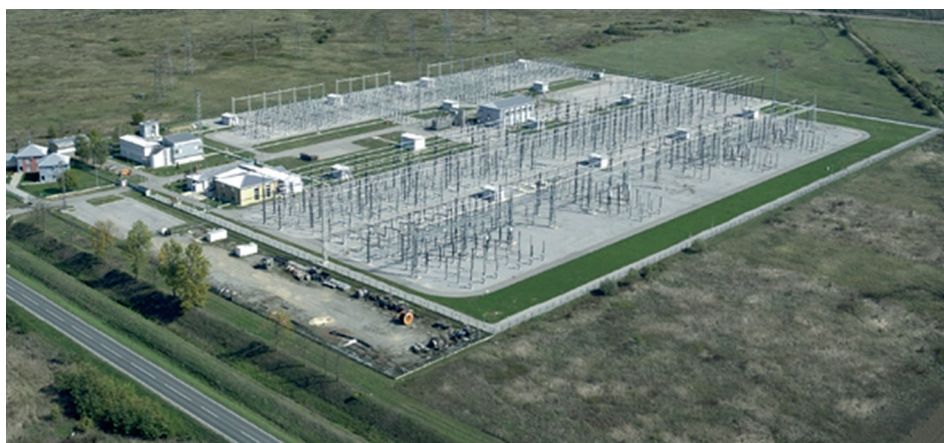
Sl. 5.: Obnovljena TS 400/110 kV Ernestinovo
