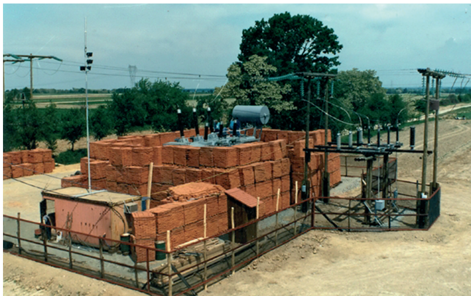
Sl. 3.: Privremena transformatorska stanica 220/110 kV "1505/2" u Slavoniji
