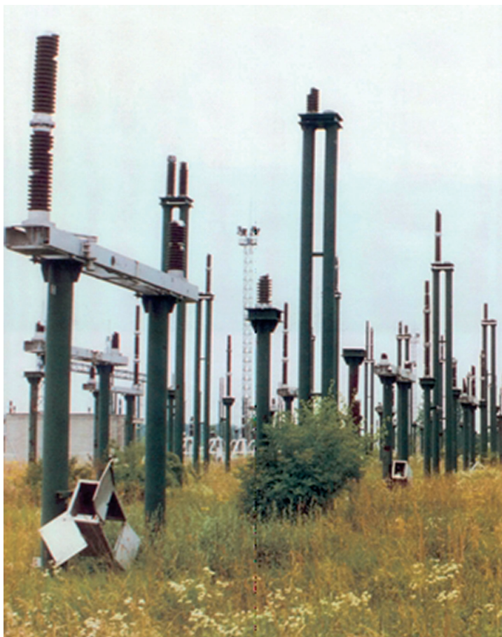
Sl. 2.: TS 400/110 kV Ernestinovo – razoreno i opljačkano postrojenje 400 kV
