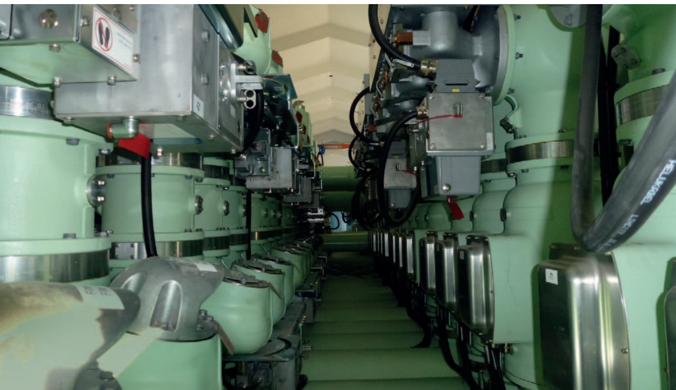
Tehnološko čudo —GIS 220 kV rasklopno postrojenje
