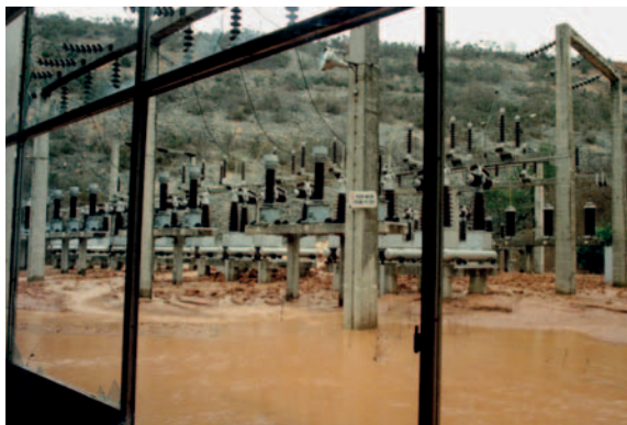
...rasklopno postrojenje Hidroelektrane Peruća
