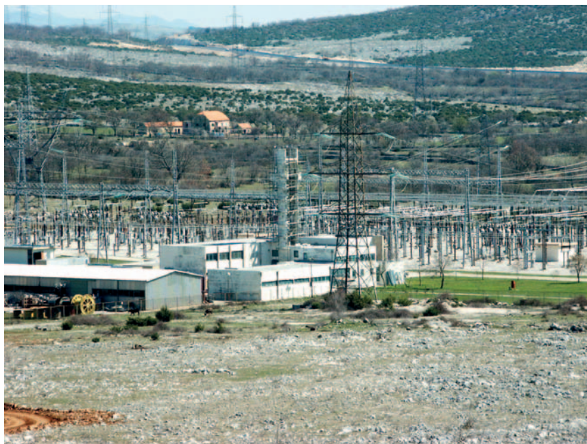
Za najvažniji događaj u elektroenergetskom sustavu Hrvatske — mrežu 400 kV, Projektni biro je izradio studije, Idejni i Izvedbeni projekt te nadzirao izgradnju jedinog dalmatinskog 400 kV čvorišta: trafostanice 380/220/110 kV Konjsko
