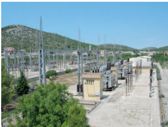
Rasklopno postrojenje 110 kV TS Bilice
