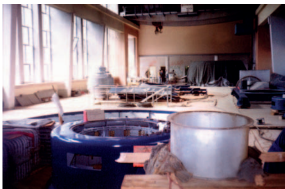
Poplavljena strojarnica i...
