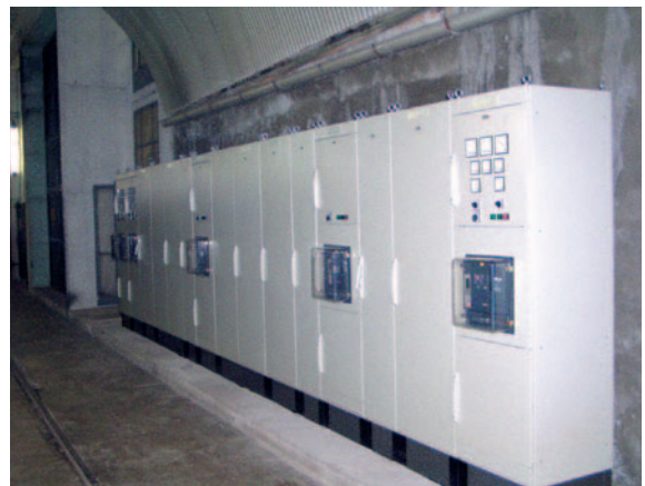
Nova ploča vlastite potrošnje 0,4 kV Hidroelektrane Senj
