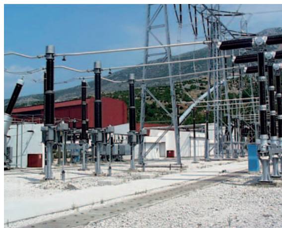
Rasklopno postrojenje RHE Velebit (u pozadini strojarnica i čelični tlačni cjevovod)
