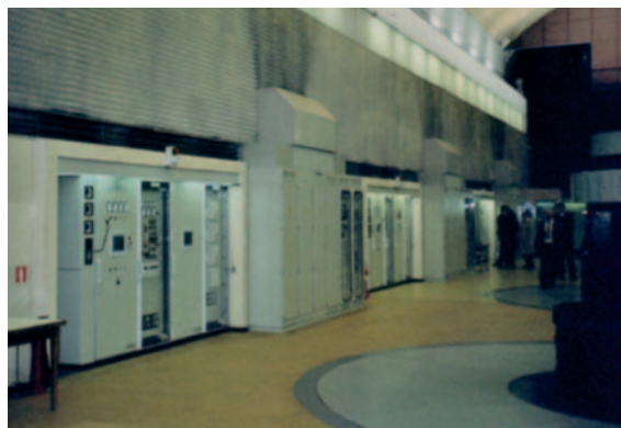
Strojarnica HE Senj — upravljačka ploča agregata
