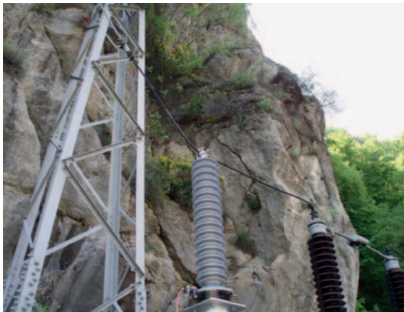
Novi odvodnici 110 kV u Hidroelektrani Sklope
