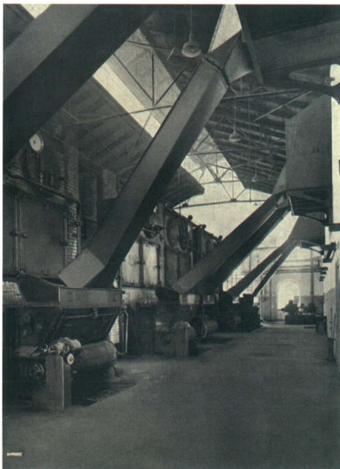
Kotlovnica u Termoelektani na Zviru (DAR)
