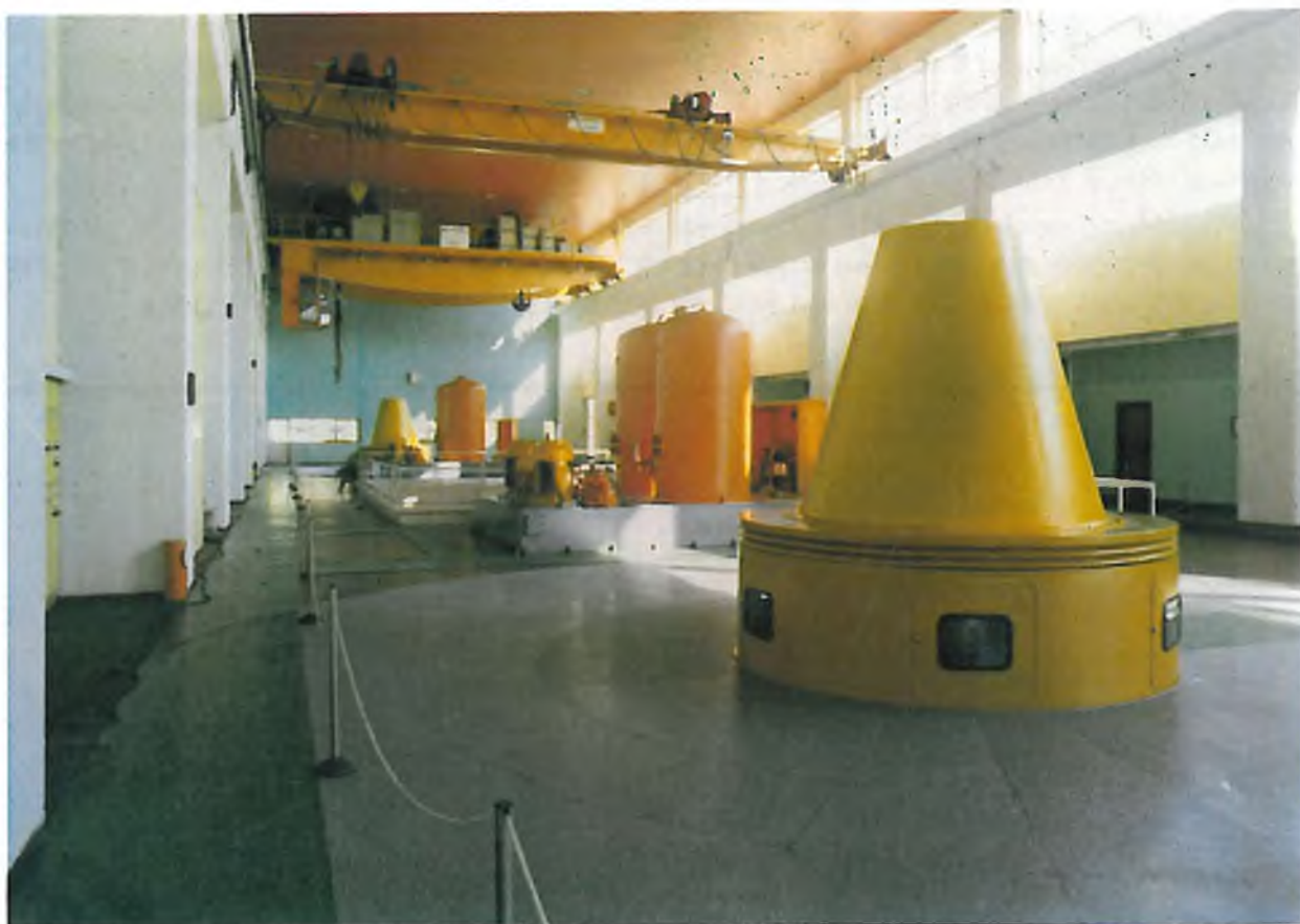
Sl. 6. 30. HIDROELEKTRANA VARAŽDIN. STROJARNICA
