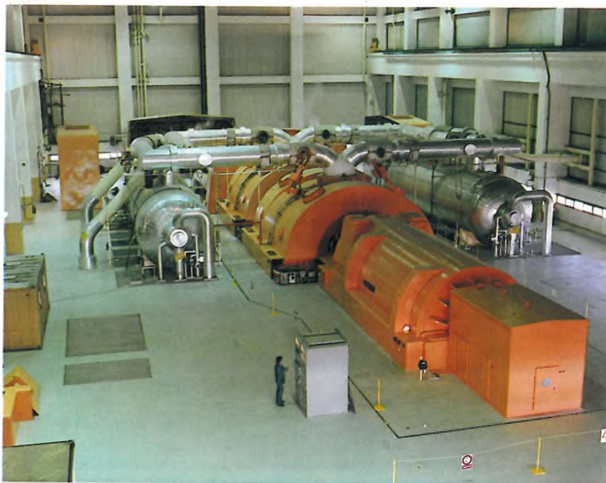
Sl. 6. 38. NUKLEARNA ELEKTRANA KRŠKO, AGREGAT 813 MVA
