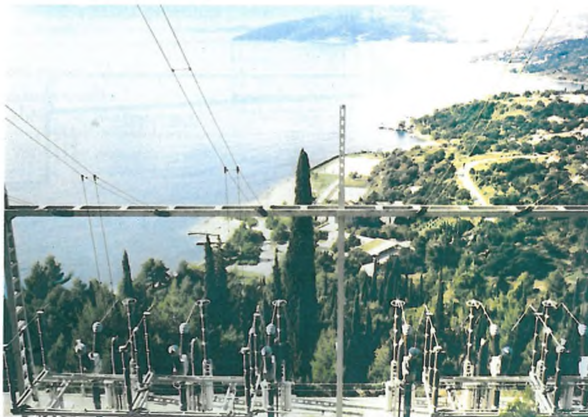
SI. 6. 22. HIDROELEKTRANA DUBROVNIK, RASKLOPNO POSTROJENJE 220 kV
