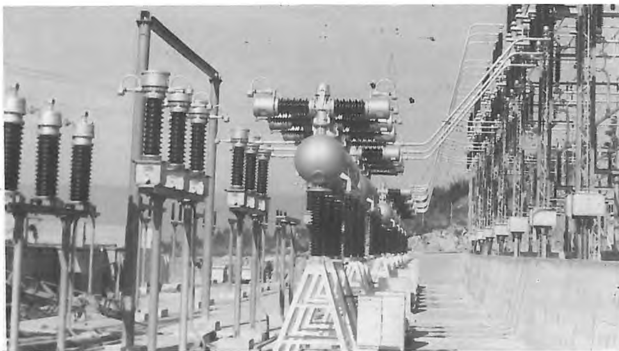
SI. 12. 6. RASKLOPNO POSTROJENJE HE RIJEKA (KATARINA) 110/35 kV S APARATIMA TVORNICE »RADE KONČAR« (1968. G.)
