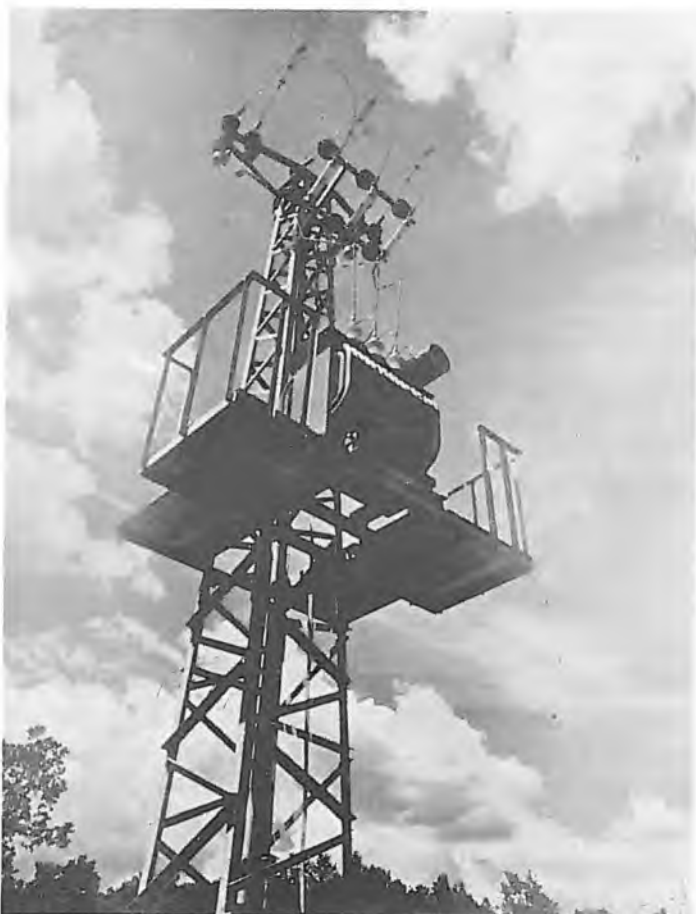
Sl. 8. 15. TRANSFORMATORSKA STANICA 10/0,4 KV NA STUPU ZA SEOSKU ELEKTRIFIKACIJU
