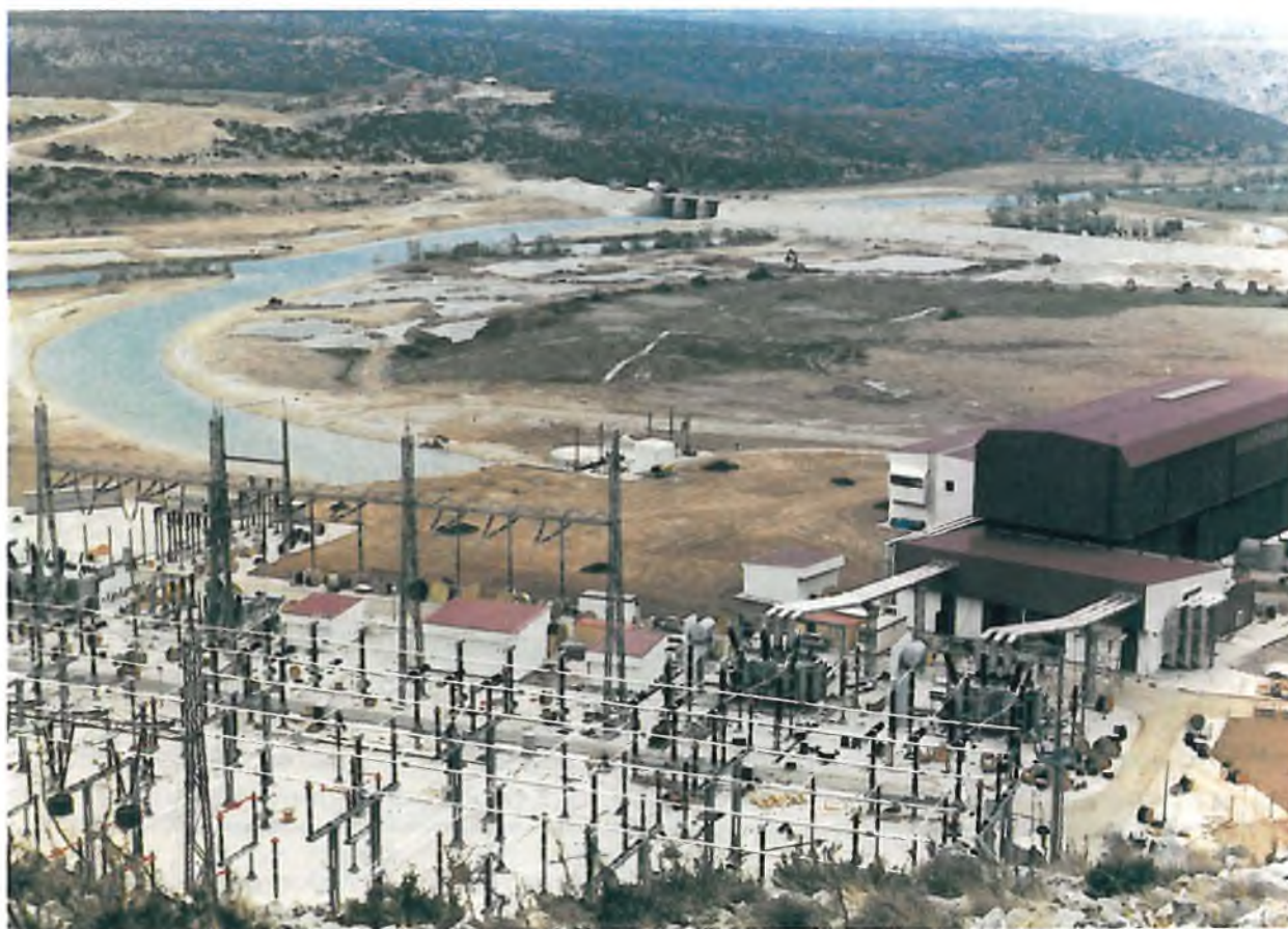
SL. 6. 36. HIDROELEKTRANA OBROVAC, RASKLOPNO POSTROJENJE
