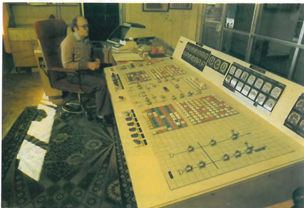
Sl. 12. 10. KOMANDNI PROSTOR HE VARAŽDIN S UGRAĐENOM UPRAVLJAČKOM I MJERNOM OPREMOM TVORNICE „RADE KONČAR“ (1976. G.)
