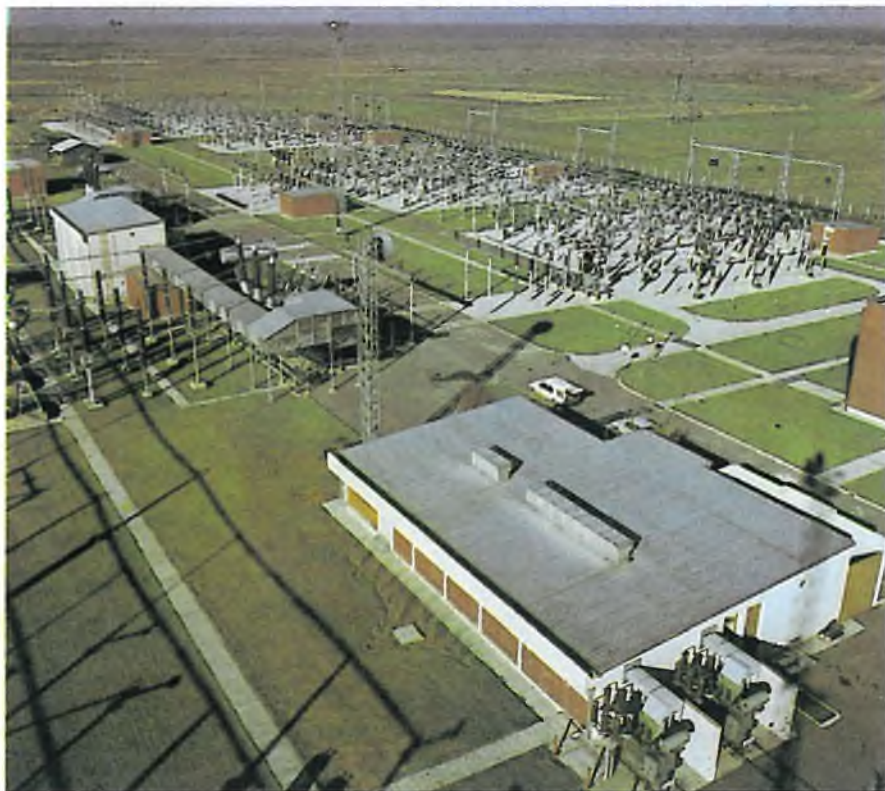
SL. 7. 27. TRANSFORMATOR- SKA STANICA TUMBRI (ZA- GREB) 400/110 kV
