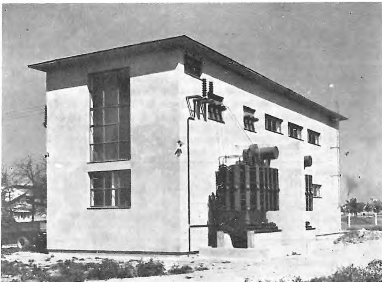
Sl. 8. 19. TRANSFORMATORSKA STANICA OSIJEK 30 kV (1957. g.)
