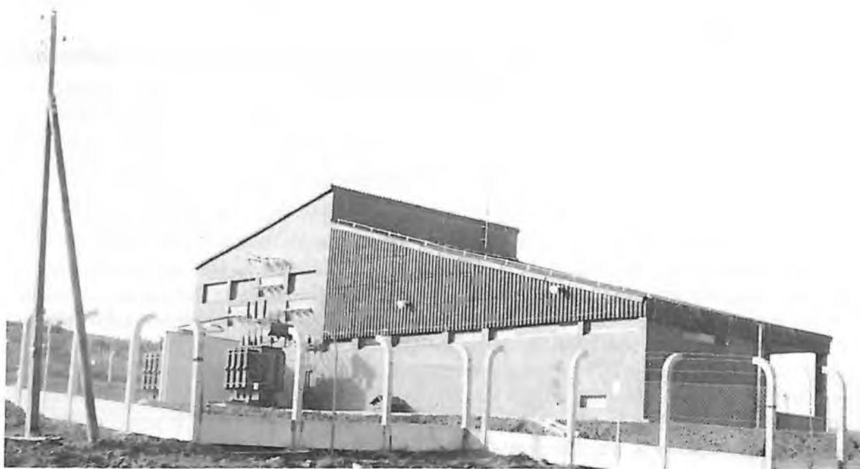
Sl. 8. 8. TRANSFORMATORSKA STANICA 35/10 kV ŽELJEZNA GORA, KRAJ ČAKOVCA (1981. g.)
