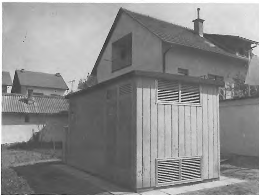
Sl. 8. 4. TRANSFORMATORSKA STANICA 10/0,4 TIPA »RADE KONČAR« (1970. g.)
