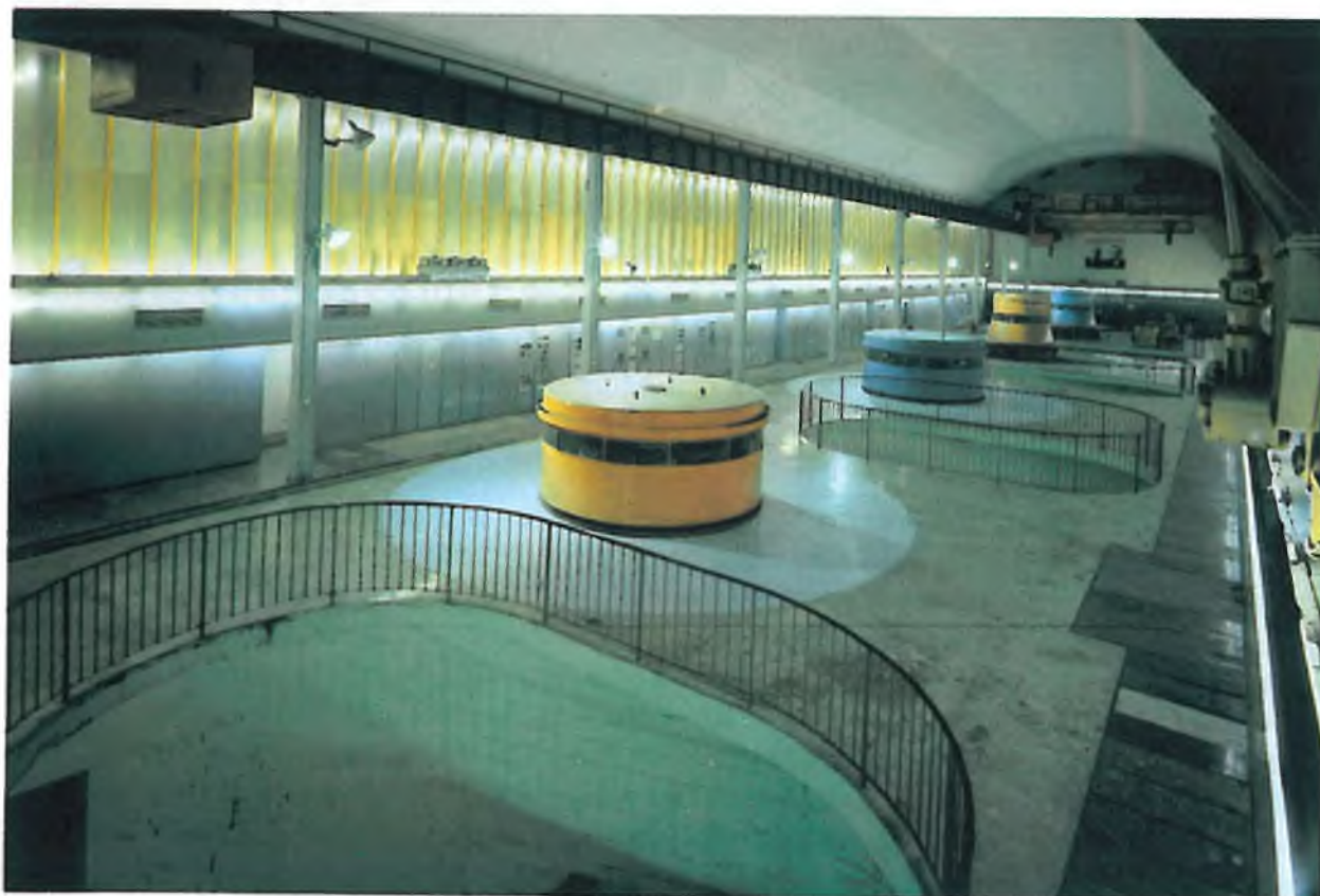
Sl. 6. 16. HIDROELEKTRANA ZAKUČAC, STROJARNICA
