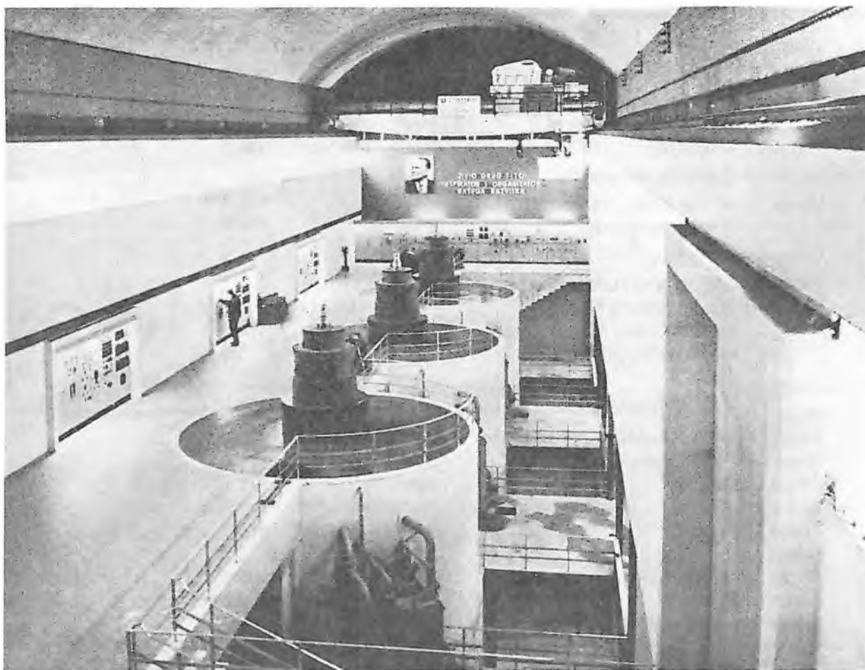
Sl. 6. 19. HIDROELEKTRANA SENJ, STROJARNICA
