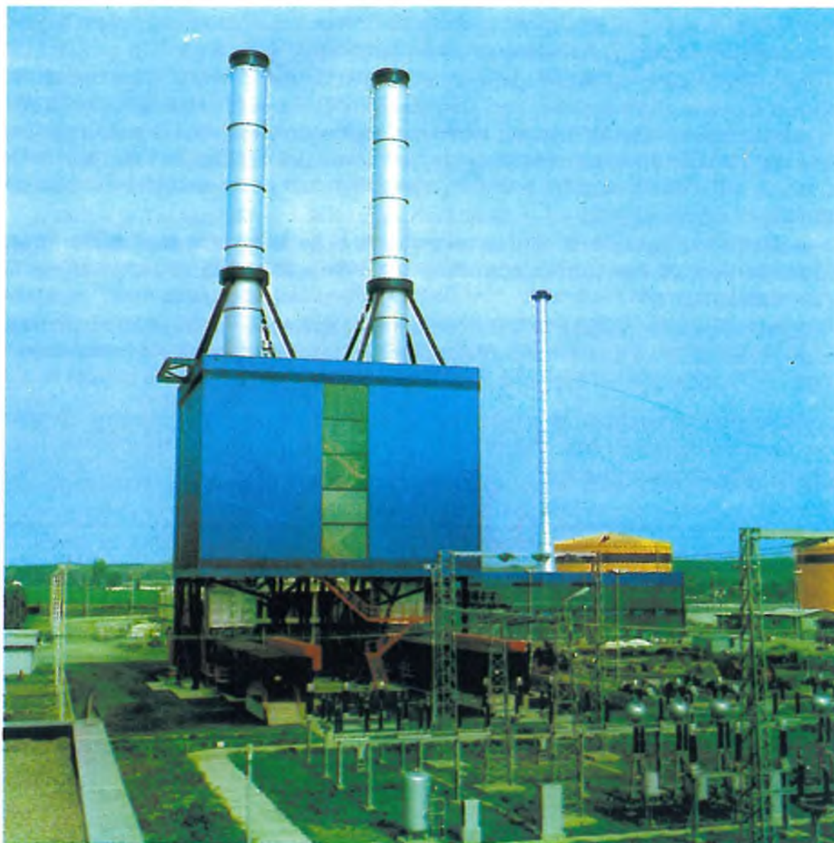
SI. 6. 31. PLINSKO – TURBINSKA ELEKTRANA OSIJEK
