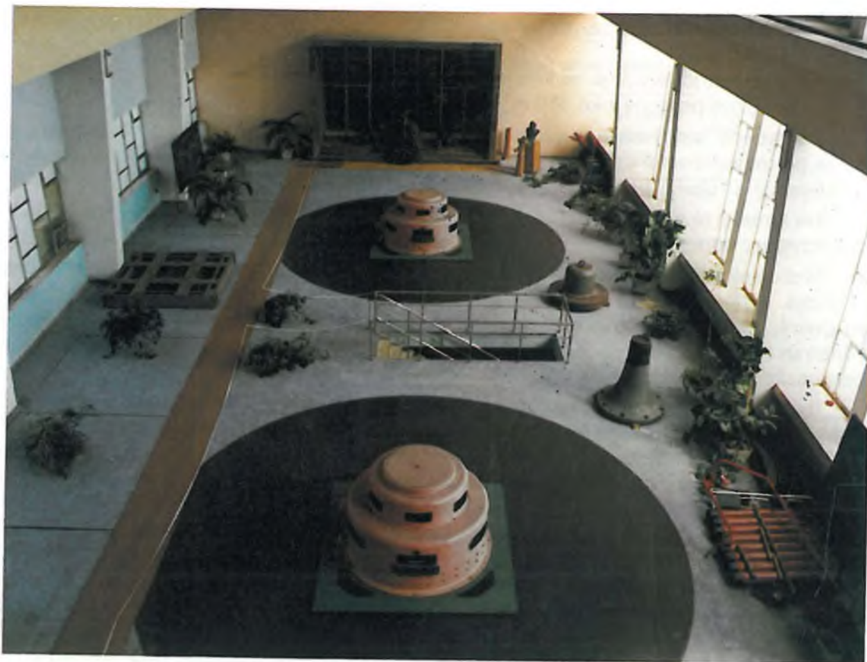
Sl. 6. 14. HIDROELEKTRANA PERUČA, STROJARNICA
