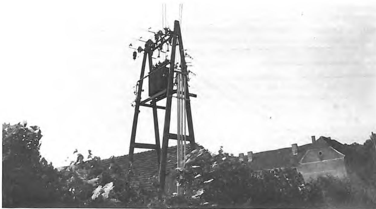
Sl. 8. 9. TRANSFORMATORSKA STANICA 10/0,4 kV NA DRVENIM STUPOVIMA
