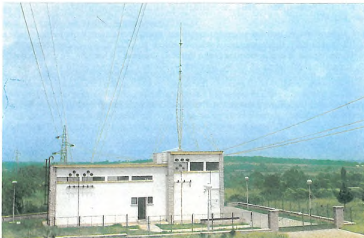
Sl. 8. 18. TRANSFORMATORSKA STANICA BANJOLE 35/10 kV
