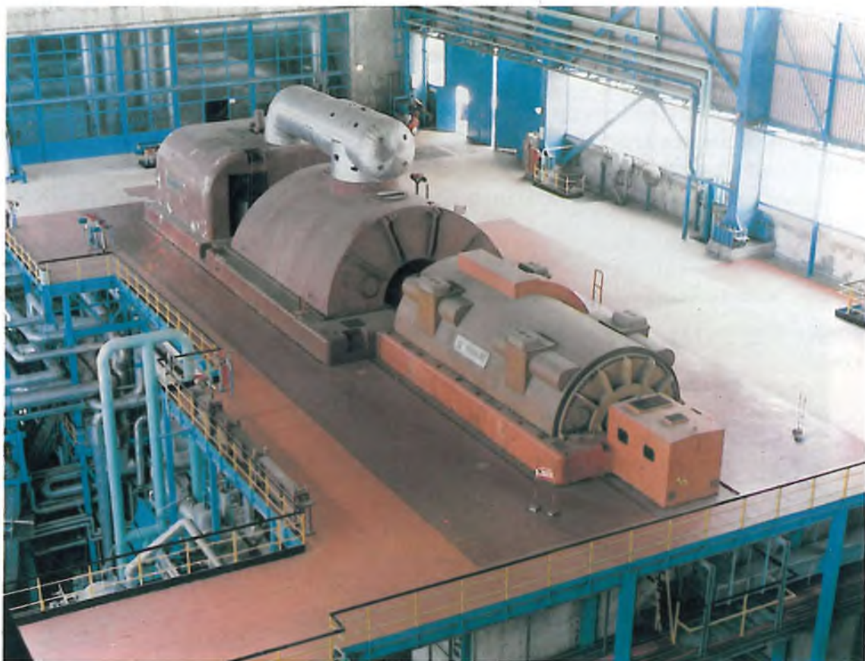
Sl. 6. 32. TERMOELEKTRANA RIJEKA — URINJ, STROJARNICA
