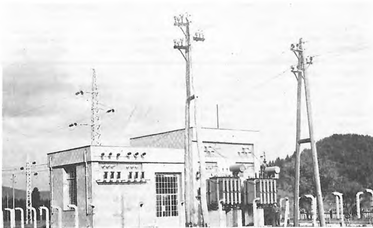
Sl. 8. 13. TRANSFORMATORSKA STANICA KUPJAK 30/10 kV (1957. g.)
