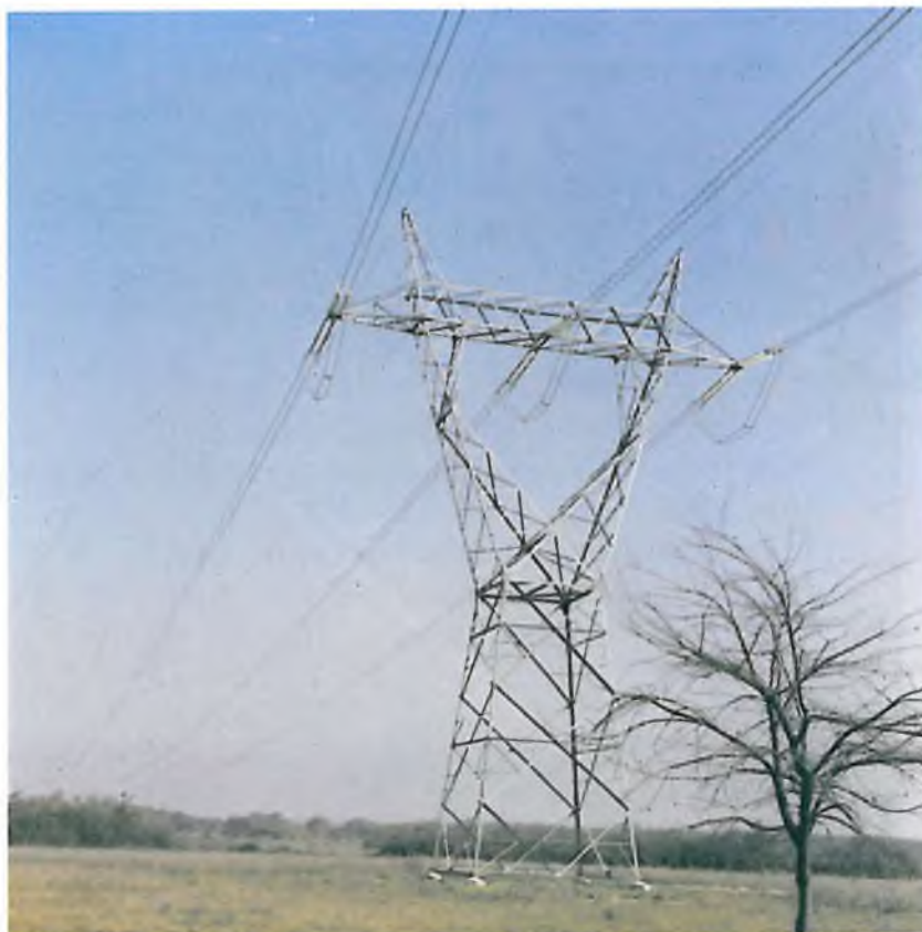
Sl. 7. 26. NOSNI STUP DALEKOVO- DA 400 kV
