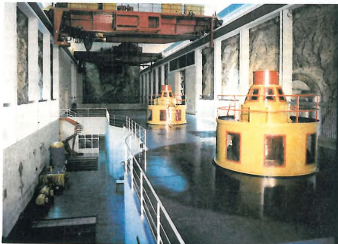
Sl. 4. 1. HIDROELEKTRANA DUBROVNIK, STROJARNICA
