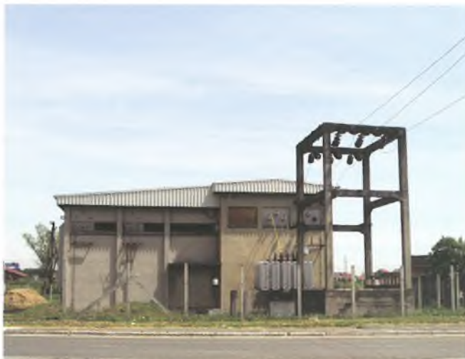
... uz koji je izgrađena transformatorska stanica 30/10 kV Cvetković
