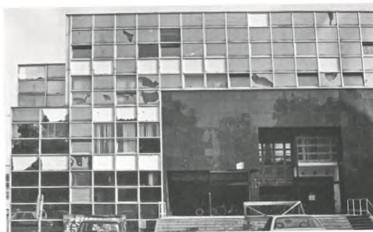
Oštećena poslovna zgrada Elektre Karlovac
