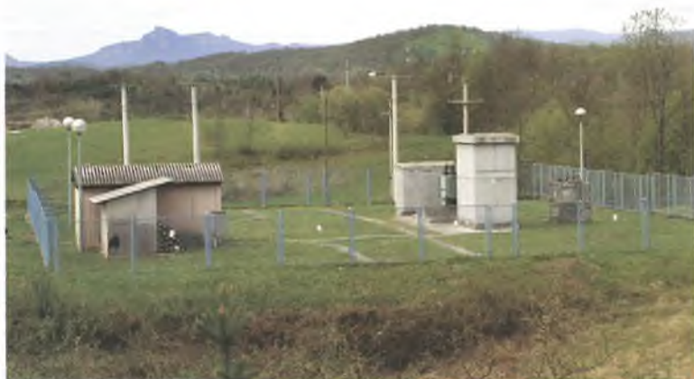
Stara transformatorska stanica Generalski Stol...
