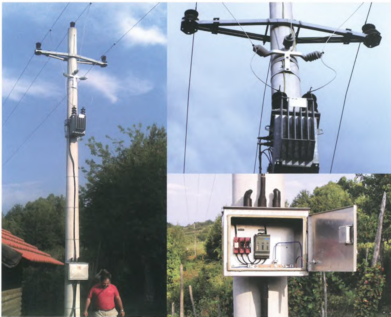
Jednostavna stupna transformatorska stanica izum je stručnjaka Elektro Karlovac
