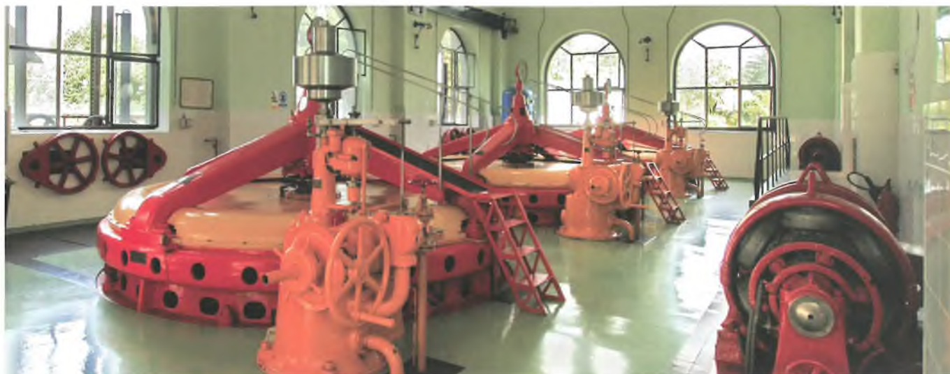
Strojarnica negdašnje Munjare grada Karlovca - Hidroelektrane Ozalj I. i nakon stoljeća rada zadržala je svoj prepoznatljivi sjaj
