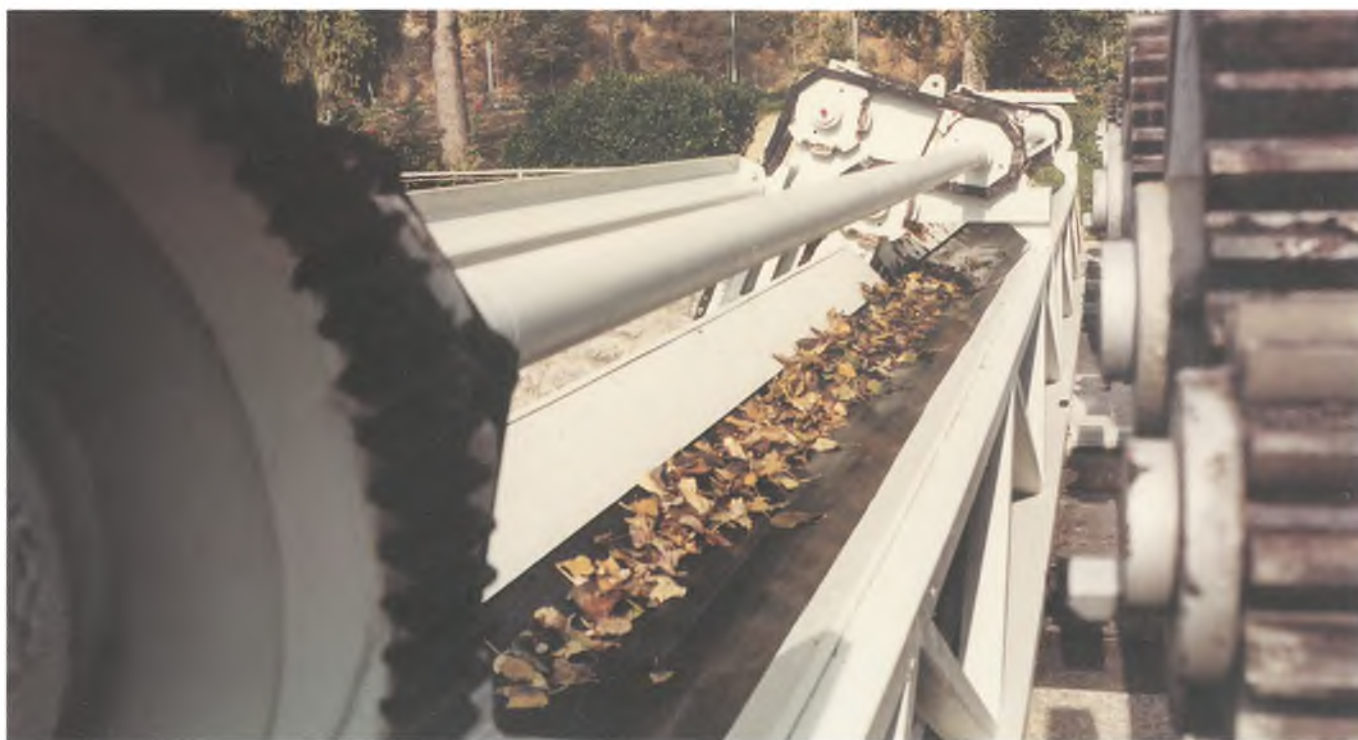
Automatizirana fina čistilica Hidroelektrane Ozalj II.
