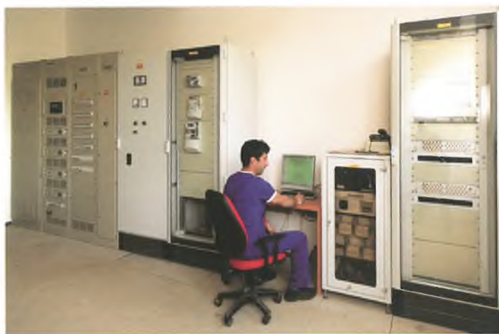
Suvremena oprema u transformatorskoj stanici 35/10 kV Generalski Stol
