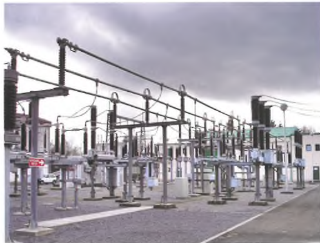
Rasklopno postrojenje transformatorske stanice 110/35 kv Oštarije, izgrađene 2005. godine
