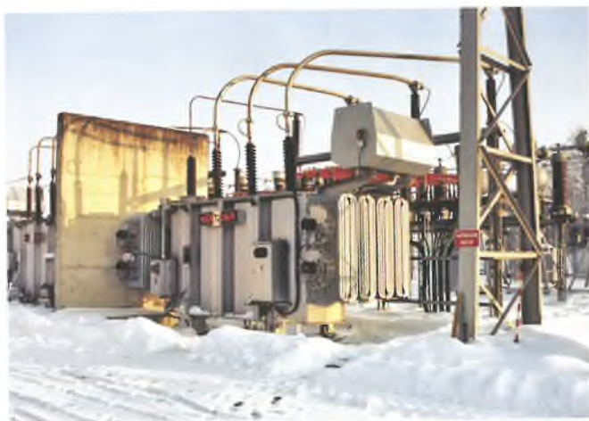
Novi transformator 110/20 kV u transformatorskoj stanici Zdenčina
