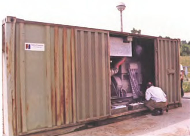
Uz slunjsku transformatorsku stanicu 35/10 kV postavljen je dizelski agregat za najnužnije potrebe grada
