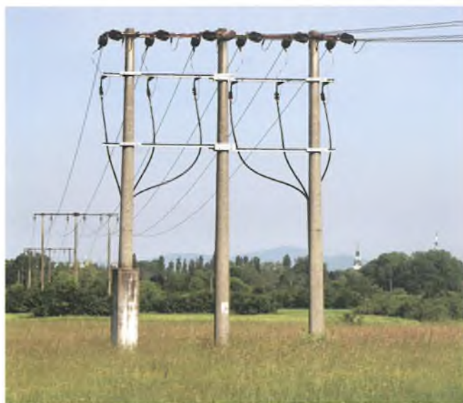
Dalekovod i kabel 35 kV
