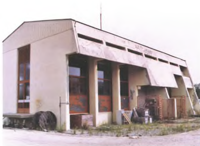
Transformatorska stanica Slunj očito je tražila obnovu
