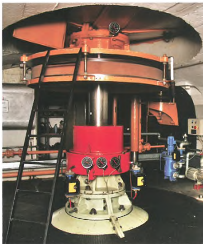
Vodeći ležajevi rekonstruirani su zbog zaštite okoliša - zamijenjene su blazinice od kovine gumenima, koje se podmazuju vodom
