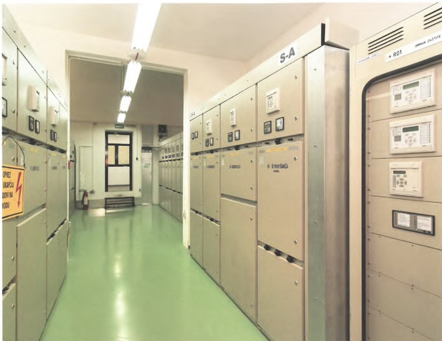
Obnovljena transformatorska stanica 35/10 kV Vojnić
