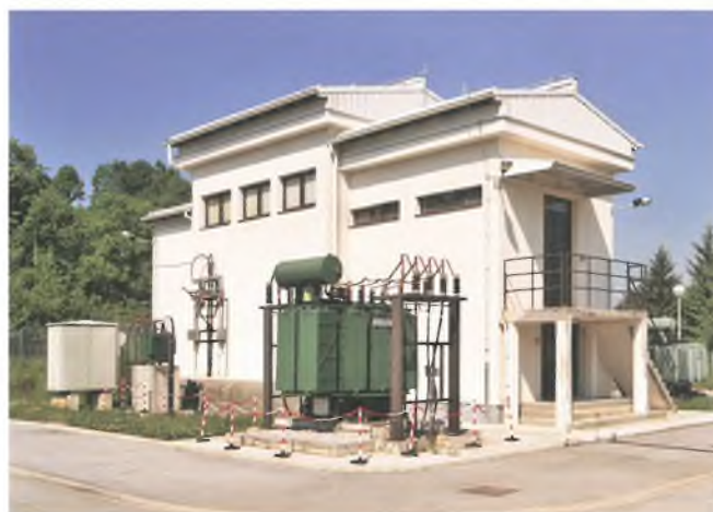
Transformatorska stanica 35/10 kV Vojnić
