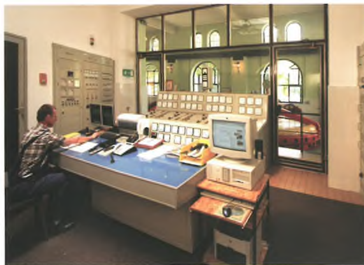
Oдавде се управља радом озалјских хидроенергетских постројења
