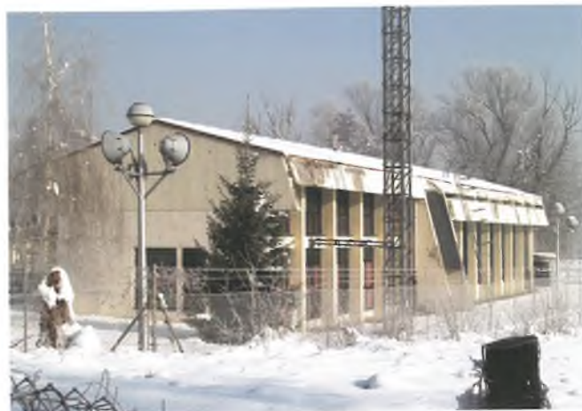
Transformatorska stanica 110/10(20) kV Dubovac u snježnom i ...
