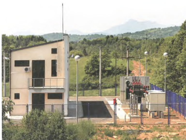
... na čijem je mjestu izgrađena nova transformatorska stanica 35/10 kV
