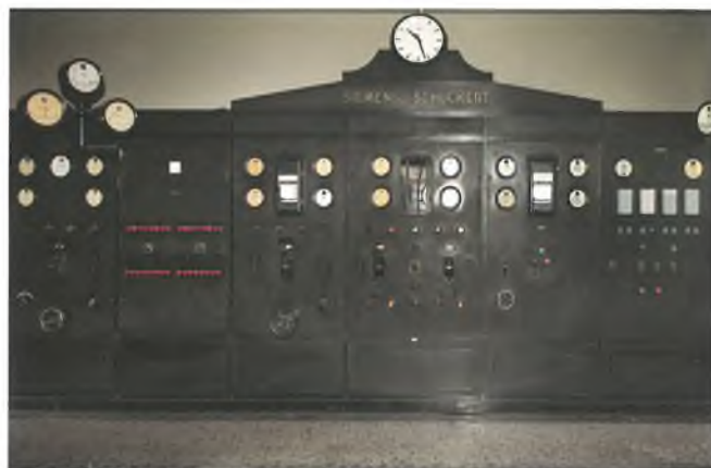
Mjerni instrumenti Hidroelektrane u Dugoj Resi
