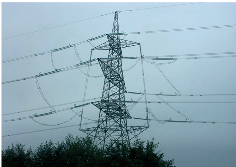
Sl. 16.: Stup na DV 400 kV Žerjavinec (HR) – Hévíz (HU) u blizini državne granice nakon harmoniziranja redoslijeda faza
