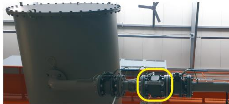
Sl. 15.12. Buchholz relej montiran na cijev koja povezuje kotao i konzervator
