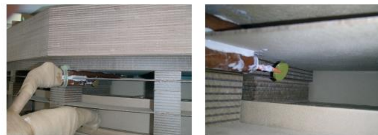
Sl. 18.25. Primjer svjetlovodnog temperaturnog senzora ugrađenog u uljni kanal VN namota transformatora
