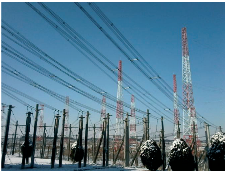
Sl. 19.: Pogled na instalirani antenski fazirani sustav (s mogućnošću usmjeravanja zračenja) u Južnoj Koreji
