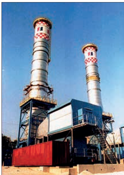
Slika 9. Plinska elektrana (PTE) 2 x 26 MW „Dujmovača” instalirana je 1994., uz pogon stare TS „Dujmovača”, kako bi olakšala napajanje Dalmacije električnom energijom tijekom Domovinskog rata. Priključena je na mrežu preko dalekovoda na postrojenje od 35 kV u TS „Vrboran”. Nakon normaliziranja elektroenergetskog sustava 1998., demontirana je i preseljena u EL-TO Zagreb.
