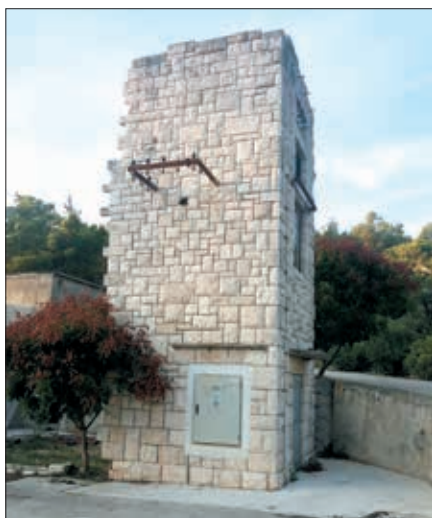
Slika 7. Trafostanica u Ložišću (foto Hania Mladineo Mika)
